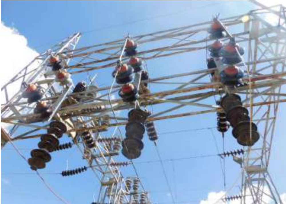
Fotografía 5-3 Seccionador en el lado de la barra en 4.16 kV
