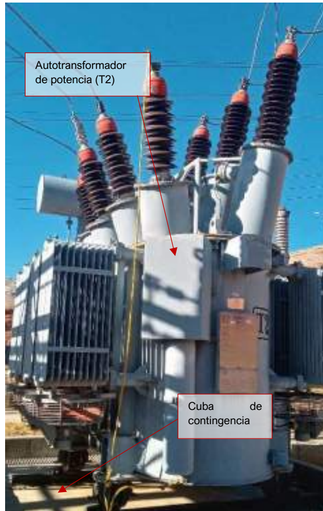
Fotografía 3.3-114 Vista de Transformador de potencia (T2) de 10 MVA
