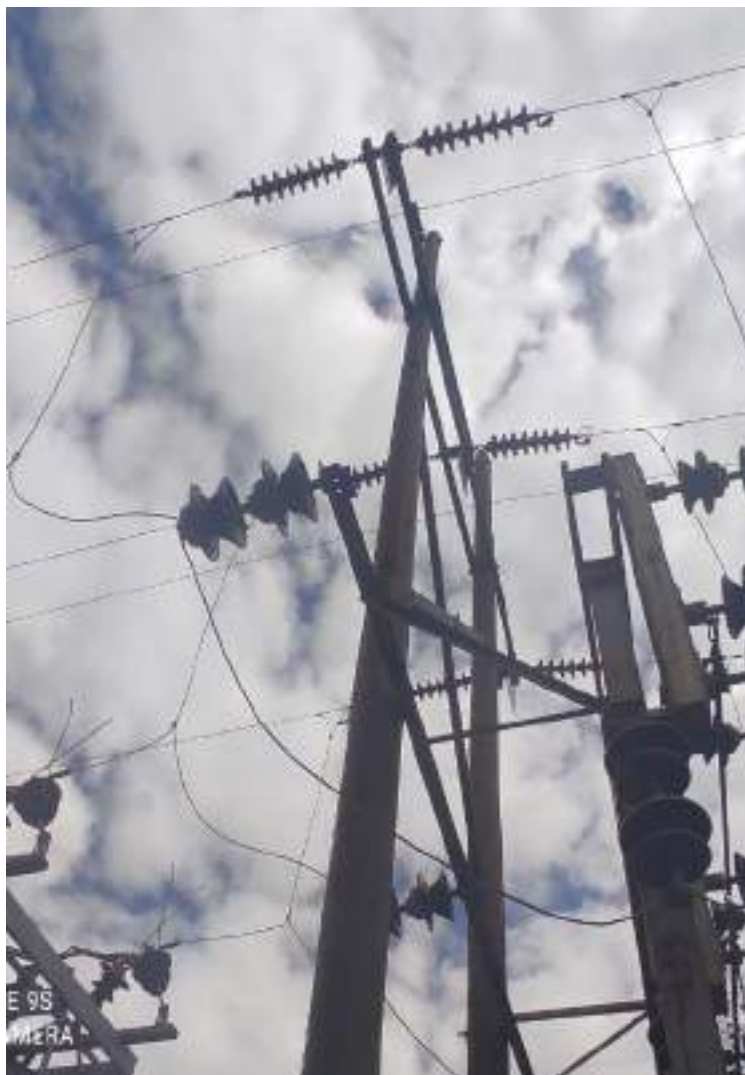
Fotografía 3-2 Estructura de llegada a la S.E. San Antonio
