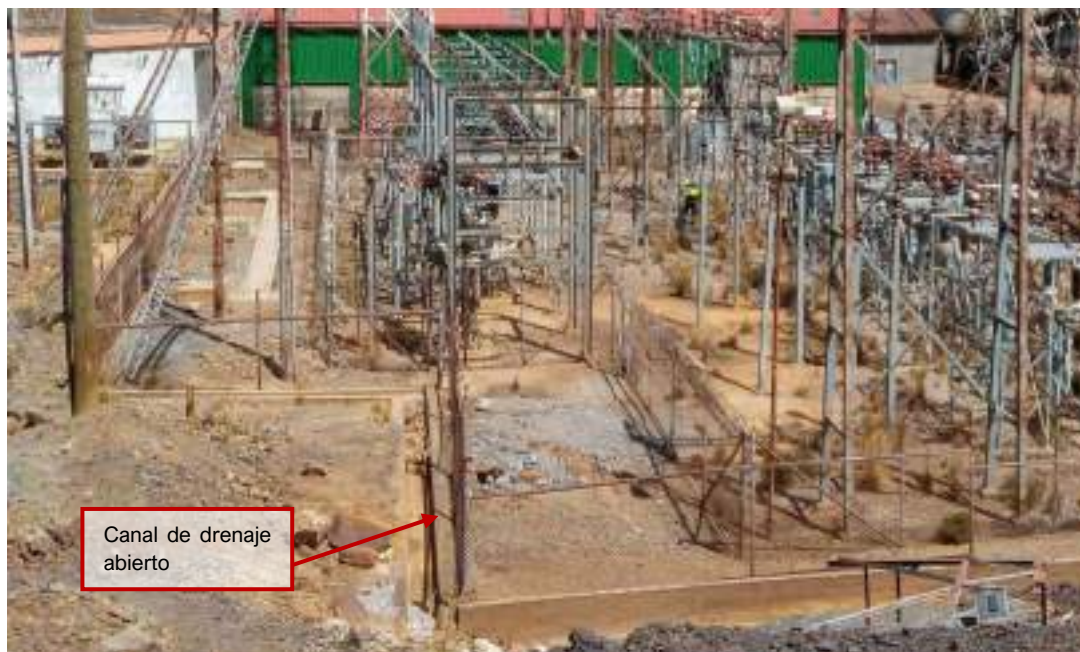
Fotografía 3.3-12 Vista de Canal de drenaje
