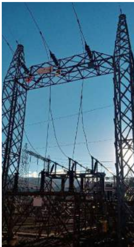
Fotografía 6-2 Pórtico de salida de LT 50 kV desde S.E Oroya Nueva hacia la S.E. Planta Zinc
