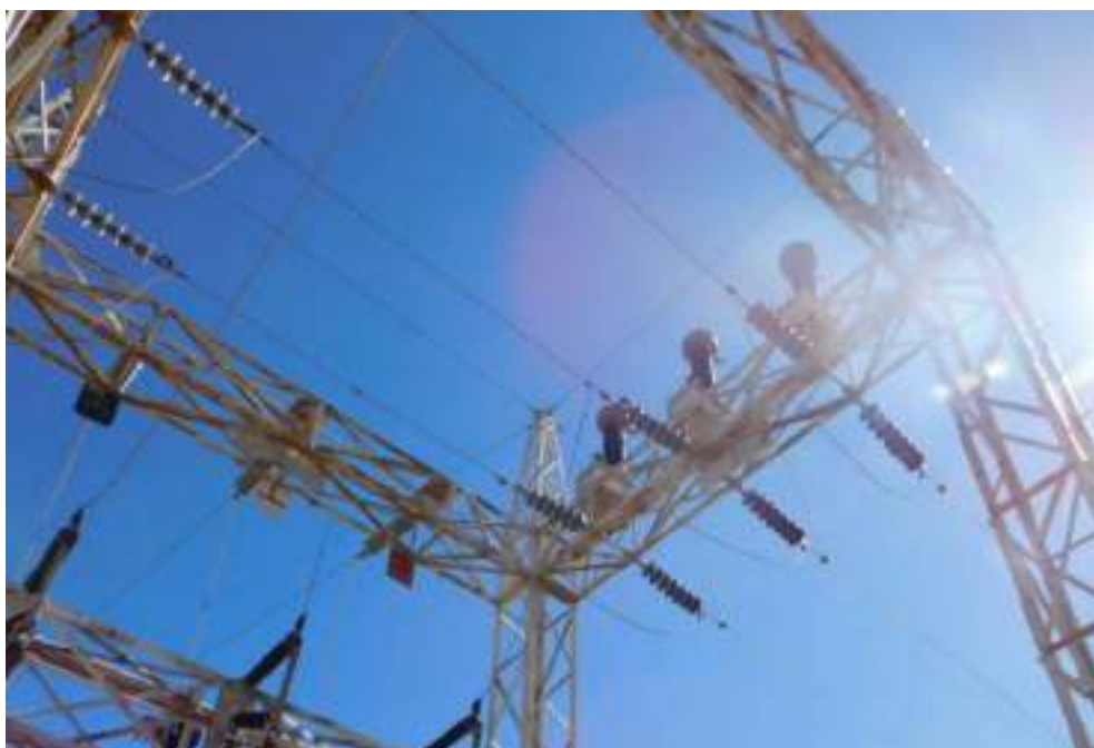
Fotografía 3-1 Pórtico de llegada de LT 50 kV desde C.H. Pachachaca a la S.E Mahr Tunel
