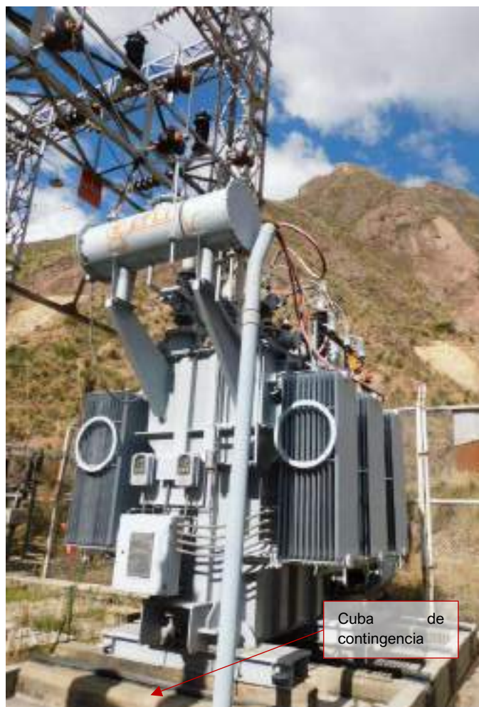
Fotografía 3.3-240 Vista Transformador trifásico de potencia(T1) 3.0 MVA S.E. Antuquito 50/4.16 kV
