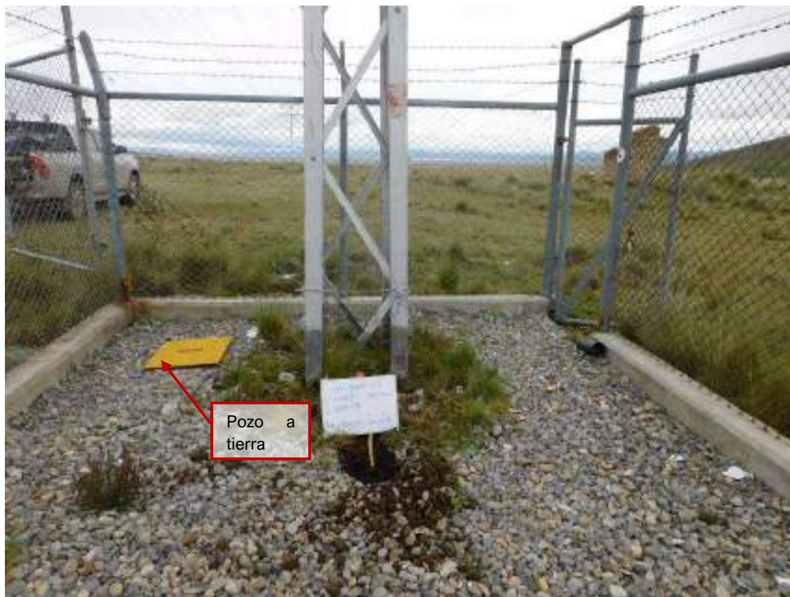
Fotografía 3.3-72 Vista de Pozo a tierra
