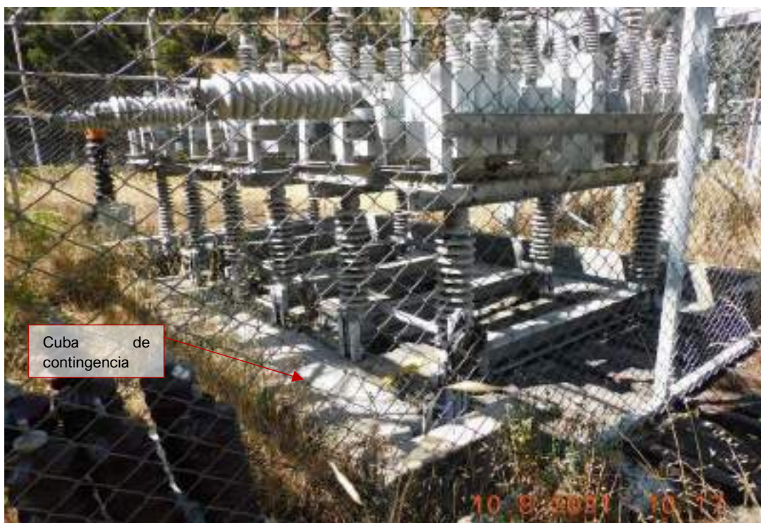
Fotografía 3.3-208 Cuba de contingencia en banco de capacitores.
