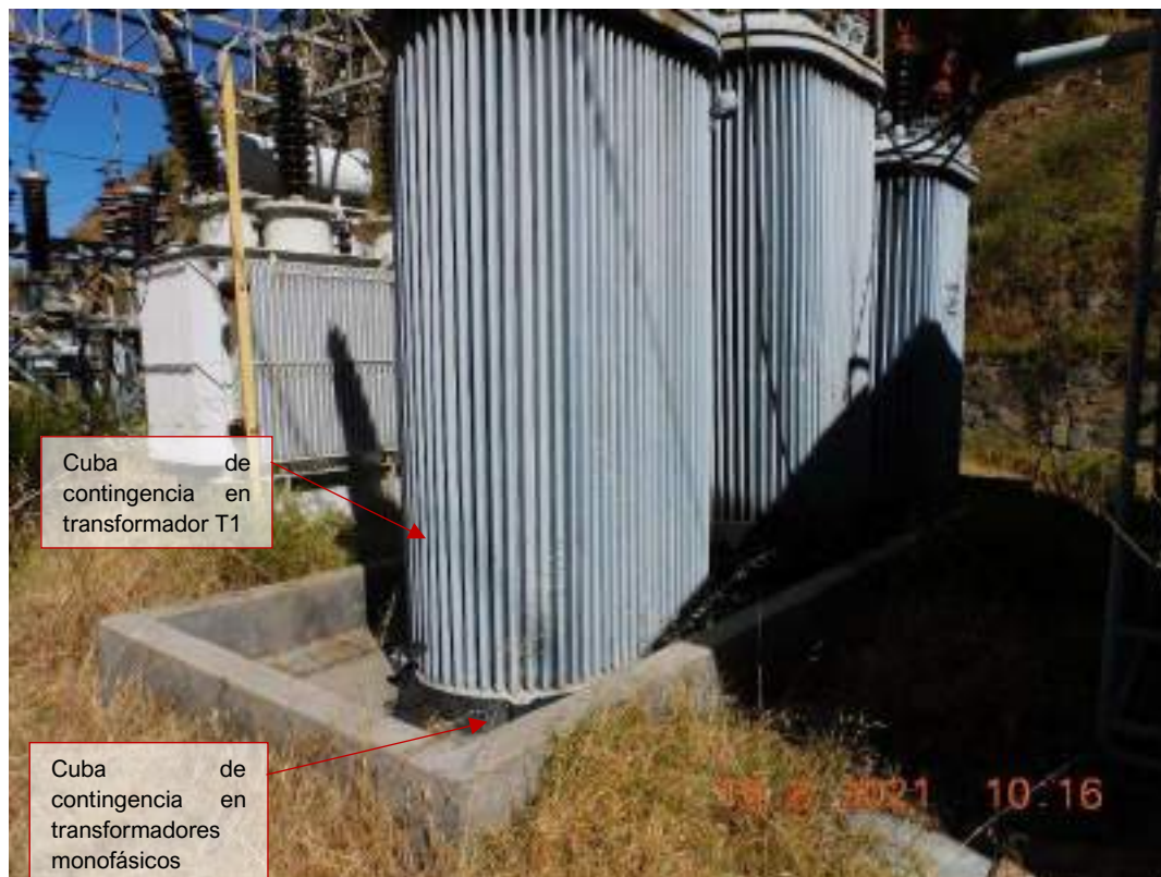
Fotografía 3.3-207 Cuba de contingencia en transformadores.
