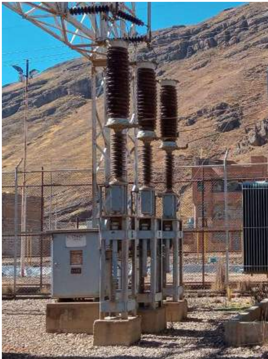
Fotografía 3.3-135 Vista de Interruptor de potencia 1200 Amp. de 72.5 kV
