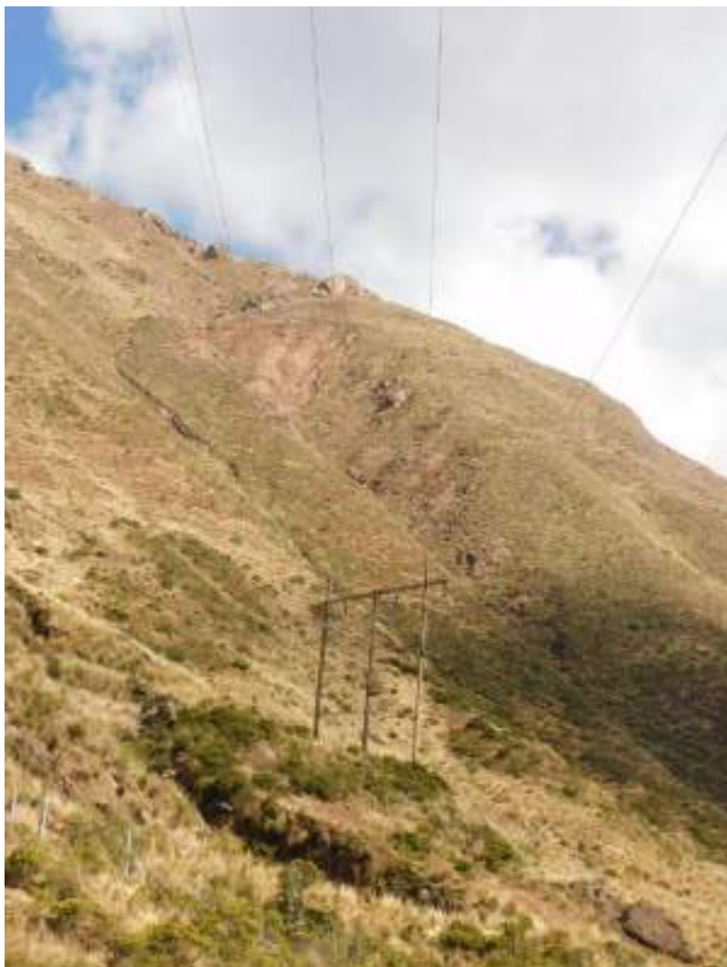
Fotografía 4-2 Poste terminal LT 50 kV desde S.E. Antuquito hacia S.E Carlos Francisco
