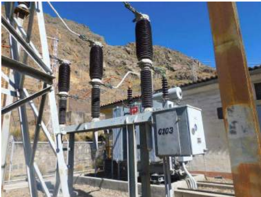
Fotografía 3.3-174 Vista de Interruptor de potencia 72.5 kV
