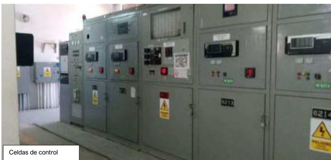
Sala de tableros
