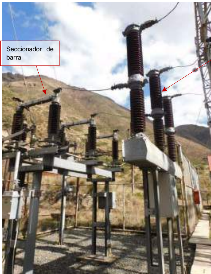
Fotografía 3.3-246 Vista de seccionador de barra
