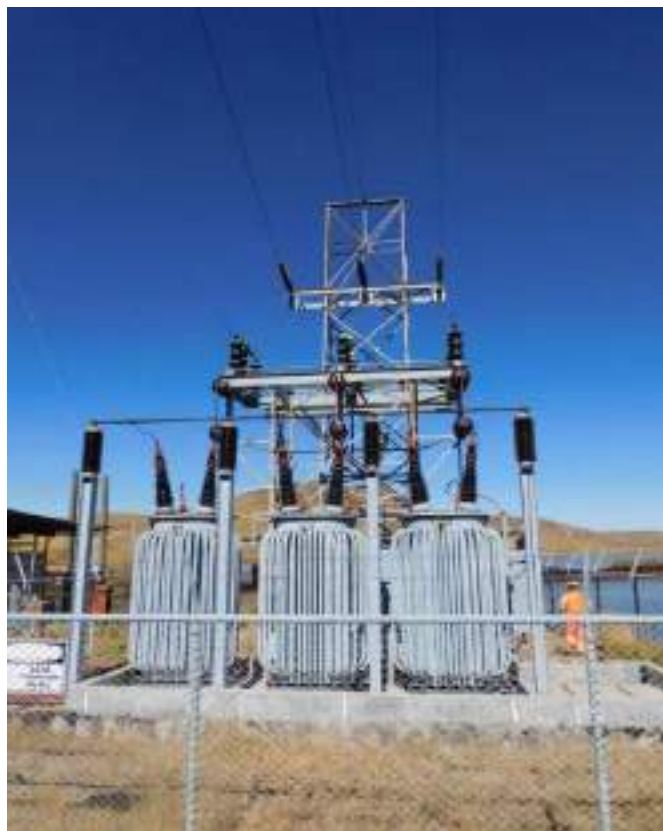
Fotografía 5-1 Transformador de monofásicos de potencia S.E. Huicra 43.3/2.2 kV
