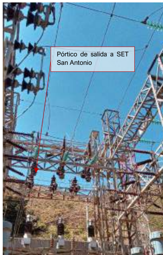
Fotografía 3.3-271 Línea de transmisión de 50 kV desde S.E. Carlos Francisco a SET San Antonio (Instalaciones de terceros)
