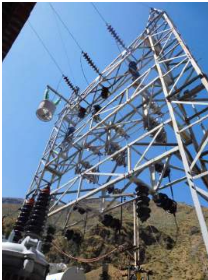
Fotografía 3-2 Pórtico de llegada de LT 50 kV a la S.E. Bellavista
