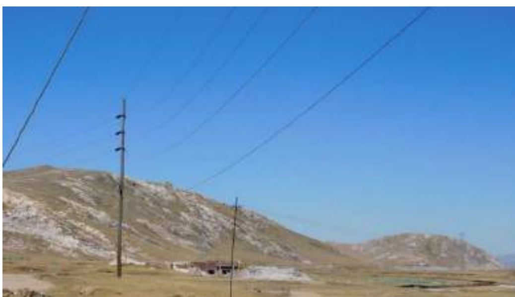
Fotografía 3-1 Línea de transmisión de 50 kV de salida de la S.E San Juan hacia S.E. San Vista Alegre.
