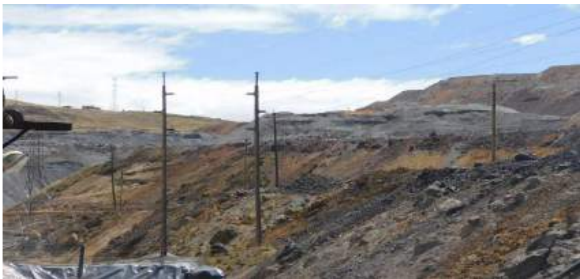
Fotografía 4-1 Torre Terminal de la línea de transmisión de 50 kV llegando a la S.E Excelsior.
