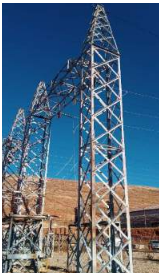
Fotografía 9-1 Pórtico de salida de LT 50 kV desde C.H Oroya Nueva hacia S.E. Alambrón
