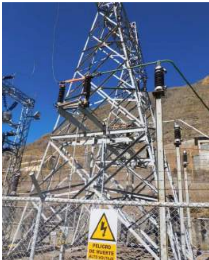
Fotografía 4-3 Seccionador de línea de 72.5 kV
