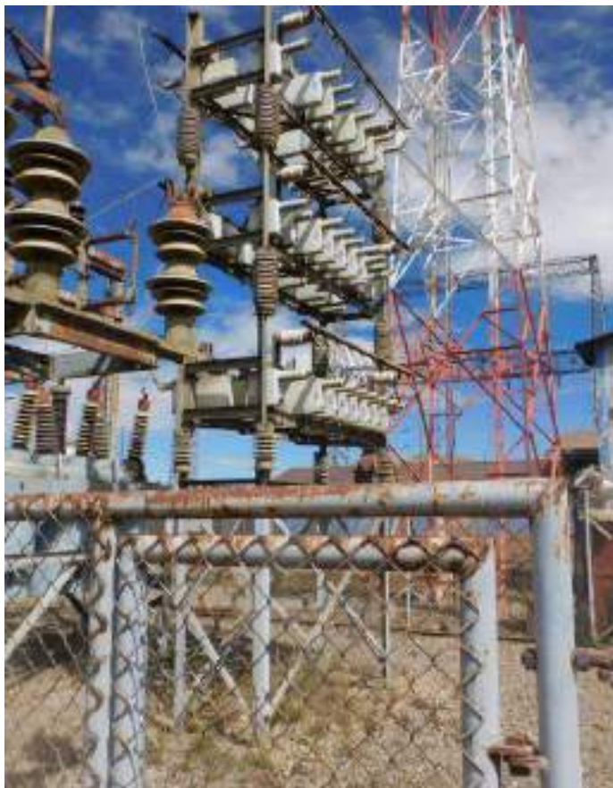
Fotografía 3.3-29 Vista de banco de condensadores de 12 MVAR en 50 kV
