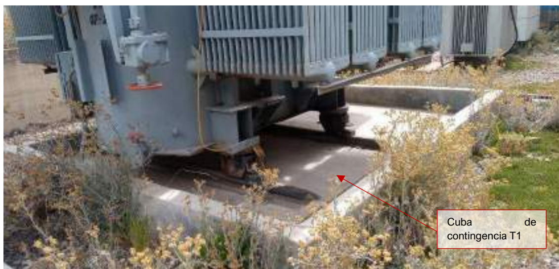
Fotografía 3.3-315 Cuba de contingencia en transformadores.
