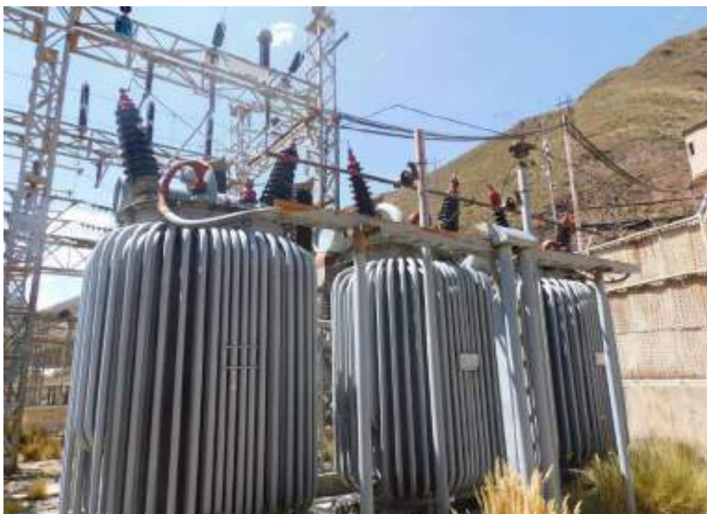
Fotografía 3.3-277 Vista Transformadores monofásicos de Potencia 50/4.16 kV (T2)
