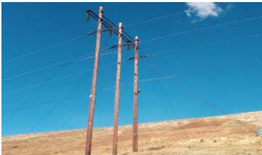
Fotografía 4-2 LT 50 kV de salida desde C.H. Oroya Nueva hacia la S.E. Curipata.
