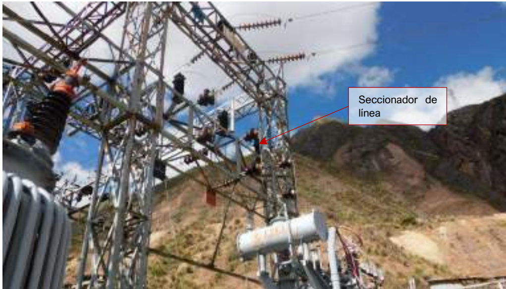
Fotografía 3.3-245 Vista seccionador de línea con fusible de potencia en 72.5 kV
