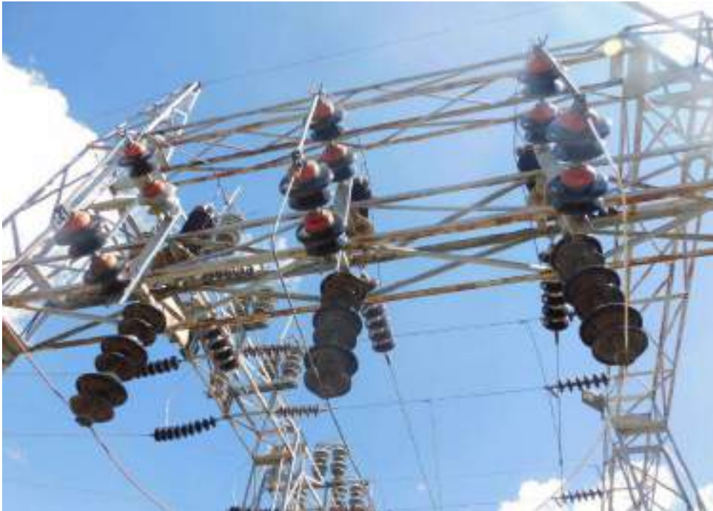
Fotografía 3.3-300 Vista Seccionador fusible, de 72.5 kV
