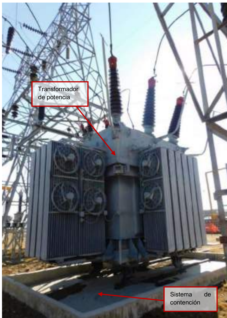
Fotografía 3.3-94 Vista de Transformador de potencia de 30/30/6.56 MVA
