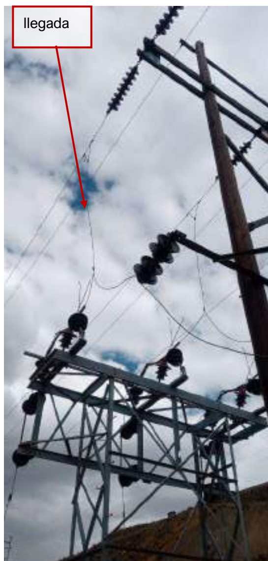
Fotografía 3.3-199 Pórtico de Llegada LT 50 kV desde la S.E. Mina Carahuacra hacia S.E. San Antonio
