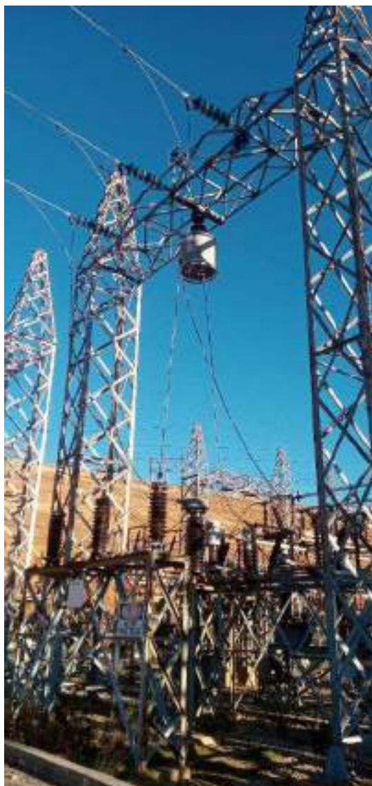
Fotografía 8-2 Pórtico de salida de LT 50 kV desde la S.E. Oroya Nueva hacia S.E. Mayupampa
