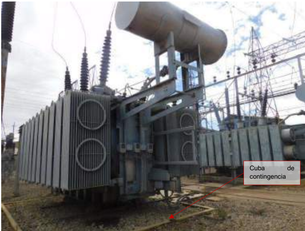
Fotografía 3.3-21 Vista Transformador trifásico T1 de potencia 44/35/44 MVA - 117/46/11 kV
