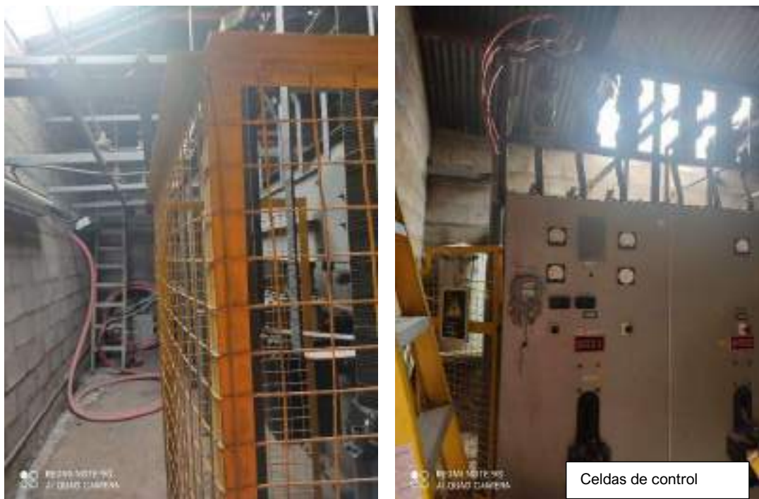
Fotografía 3.3-194 Vistas de interiores de Sala de Control
