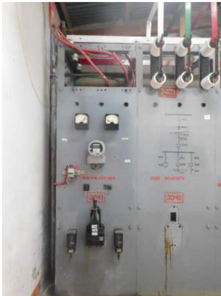
Fotografía 5-3 Interruptor de potencia en 2.4 kV
