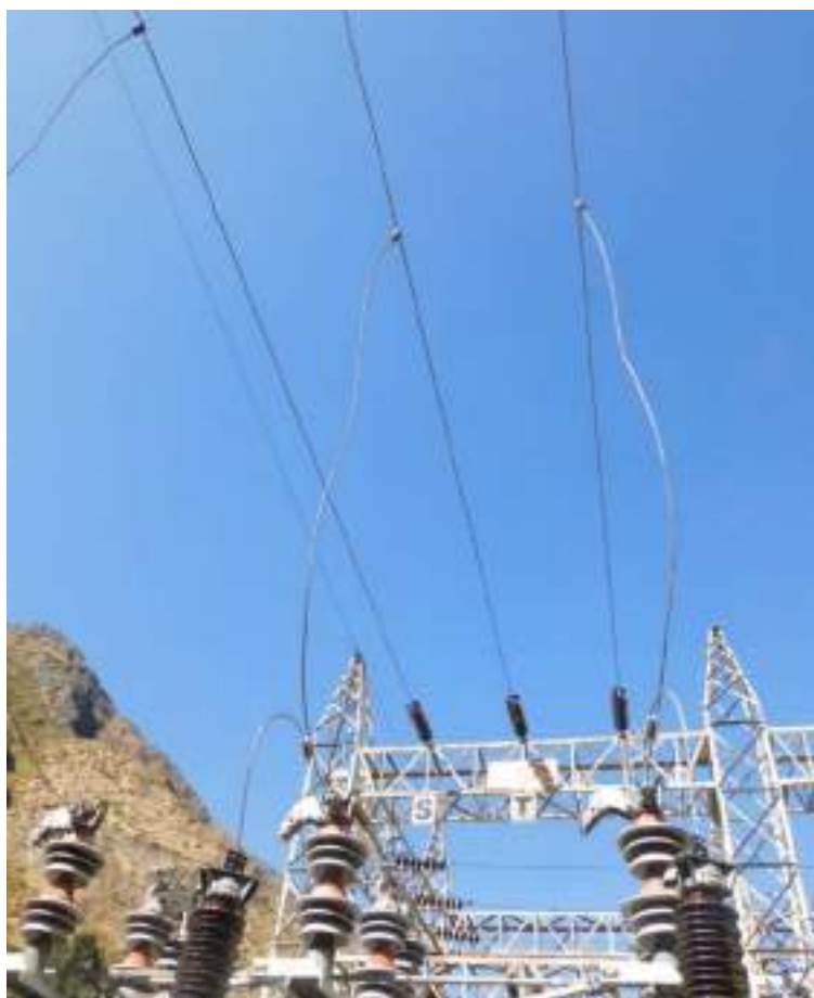
Fotografía 3-2 Pórtico de llegada LT 50 kV a la S.E. San Mateo desde S.E. Bellavista
