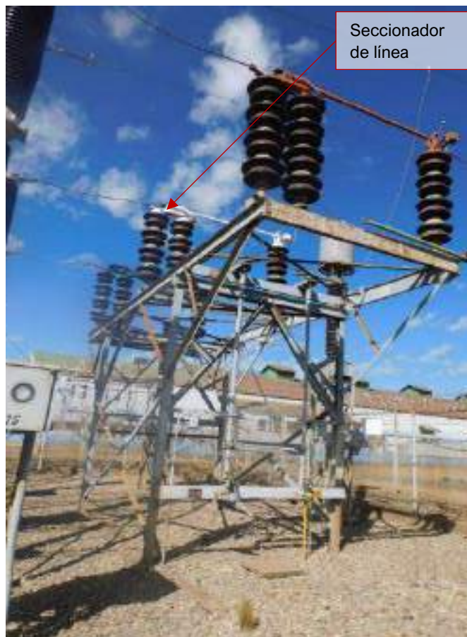
Fotografía 3.3-27 Vista Seccionador de línea 138 kV
