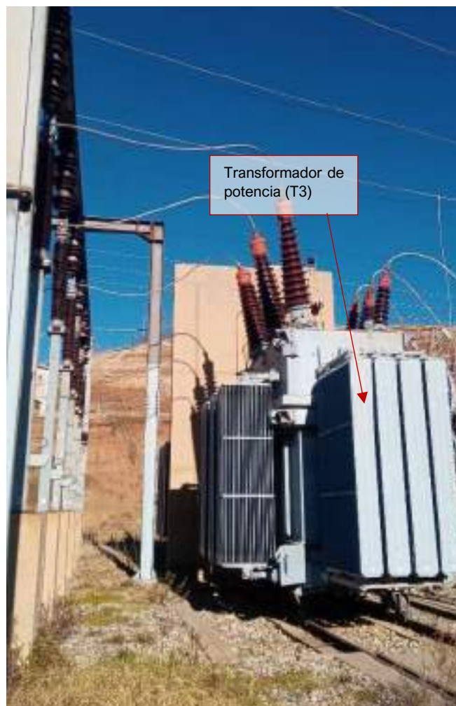
Fotografía 3.3-115 Vista de Transformador de potencia (T3) de 30/30/6.57 MVA
