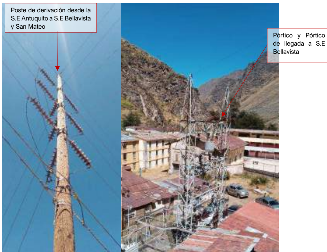
Fotografía 3.3-235 Poste de derivación y Pórtico de Llegada LT 50 kV a la S.E. Bellavista desde S.E. Antuquito
