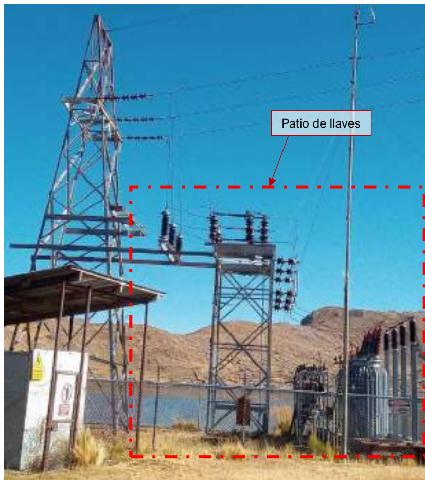
Fotografía 3.3-56 Vista de Patio de Llaves
