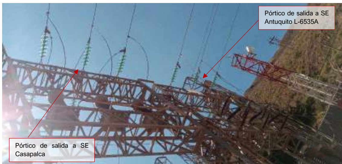
Fotografía 3.3-269 Línea de transmisión de 50 kV desde S.E. Carlos Francisco a S.E Casapalca y S.E. Antuquito.
