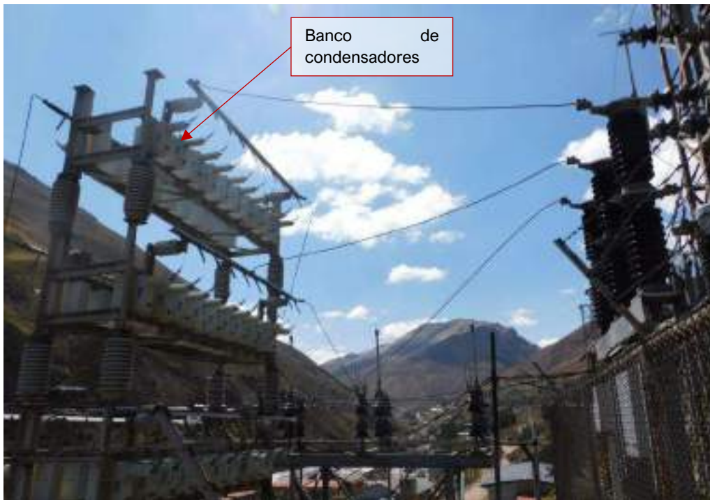
Fotografía 3.3-285 Vista de banco de condensadores de 6 MVAR
