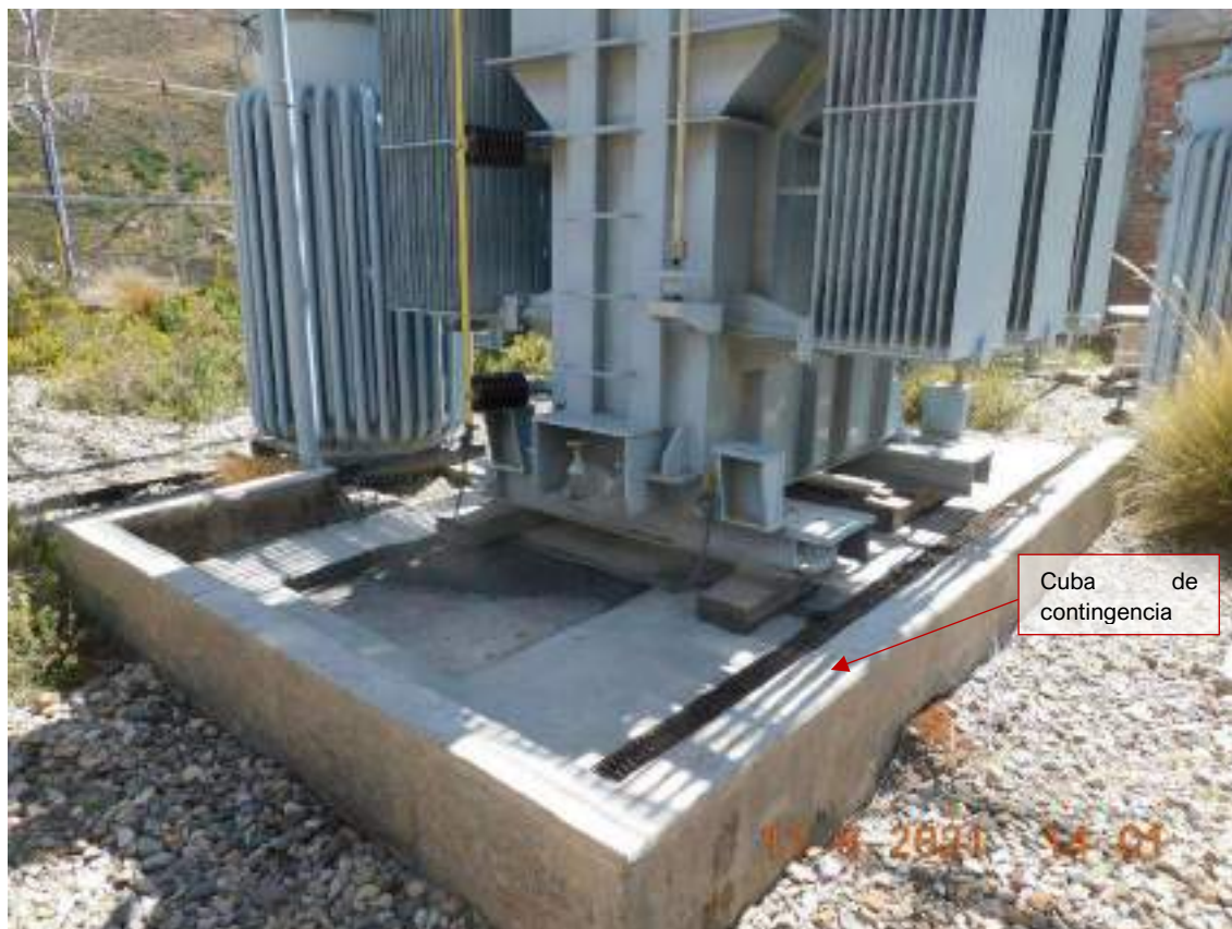
Fotografía 3.3-298 Cuba de contingencia en transformadores.
