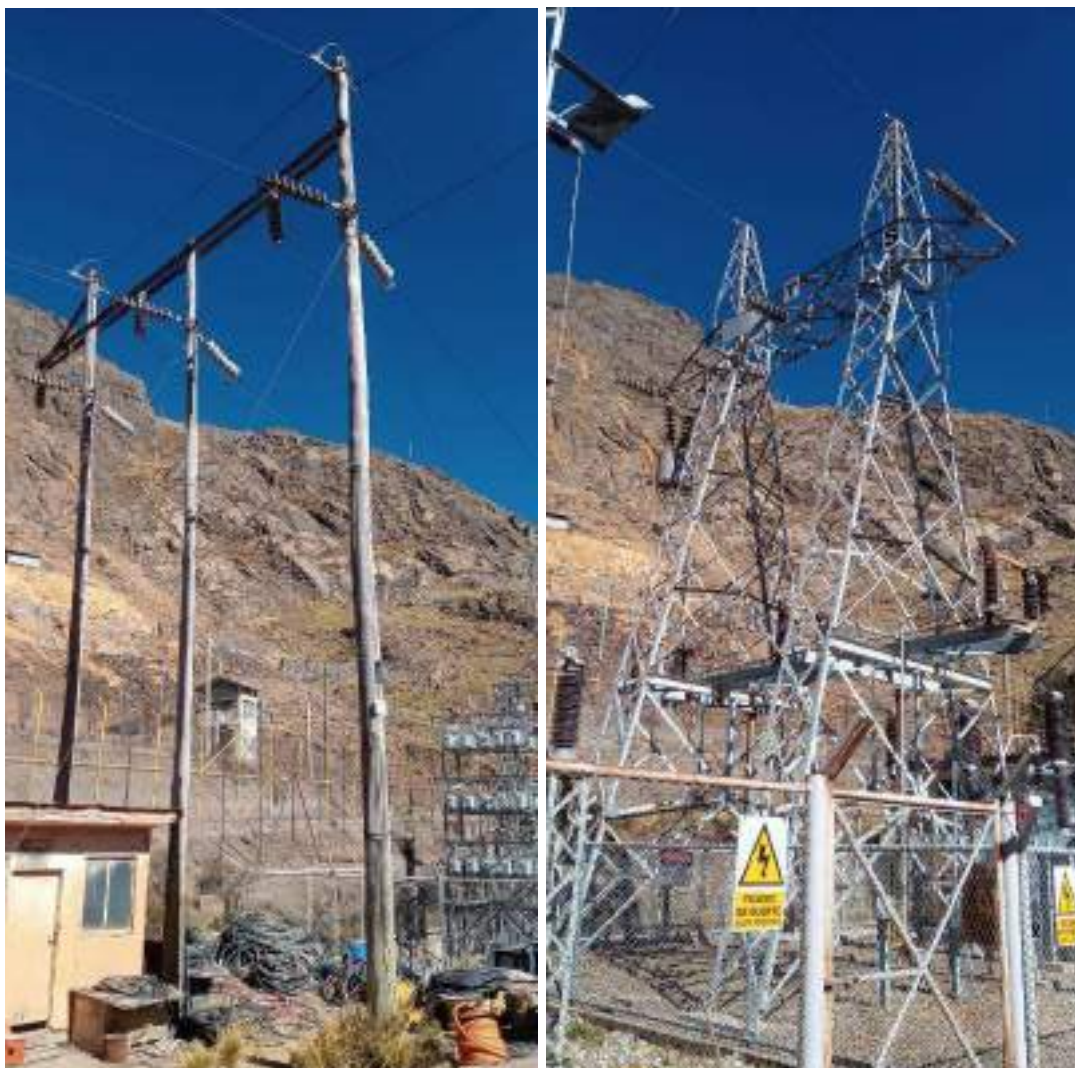
Fotografía 3.3-183 Poste terminal y pórtico de llegada LT 50 kV desde la S.E. Andaychagua ELC hacia S.E. Andaychagua
