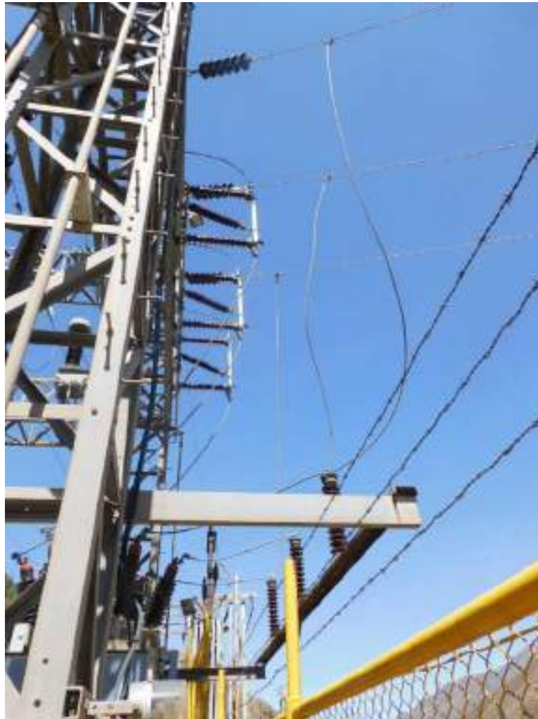
Fotografía 5-4 Seccionador en el lado de la barra en 50 kV
