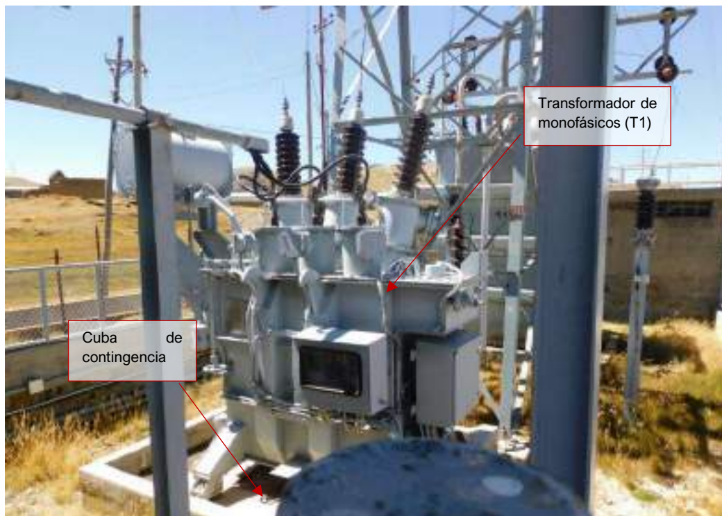
Fotografía 3.3-40 Vista de Transformador de potencia (T1) de 1.5 MVA
