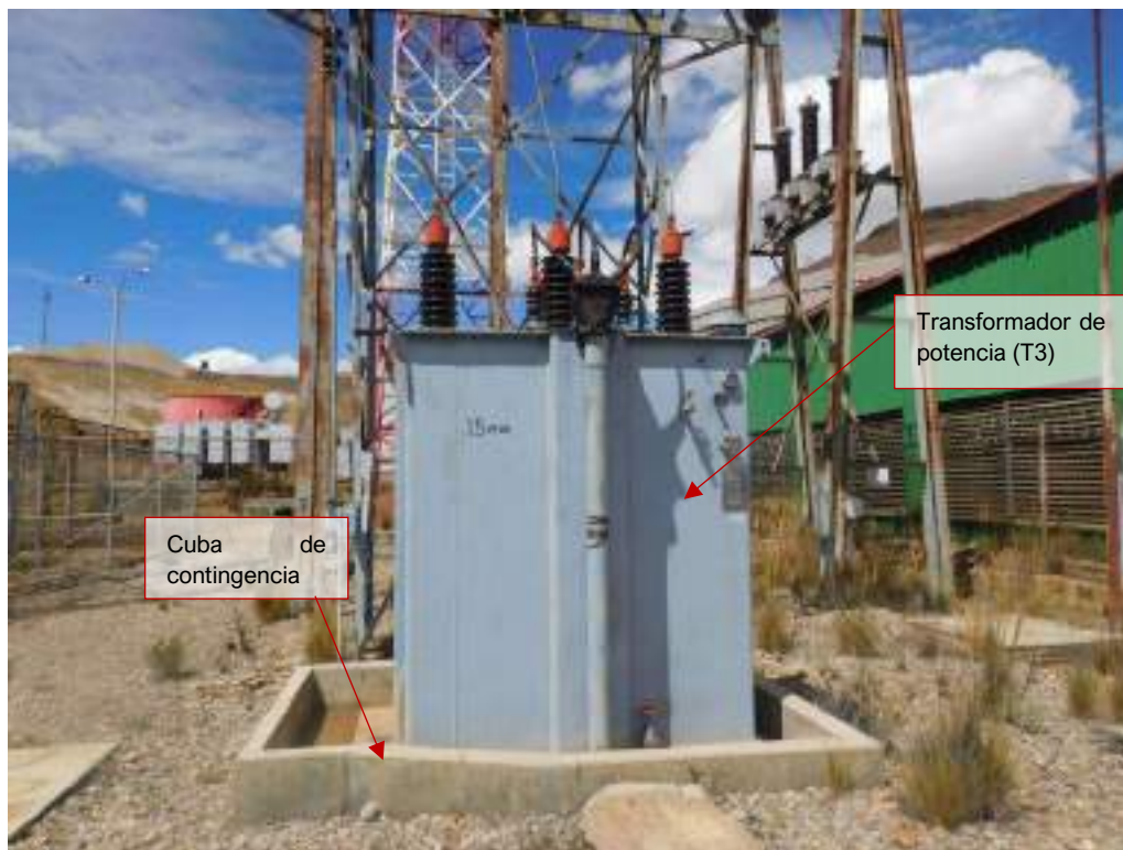
Fotografía 3.3-4 Vista de Transformador de potencia (T3) de 1.5 MVA
