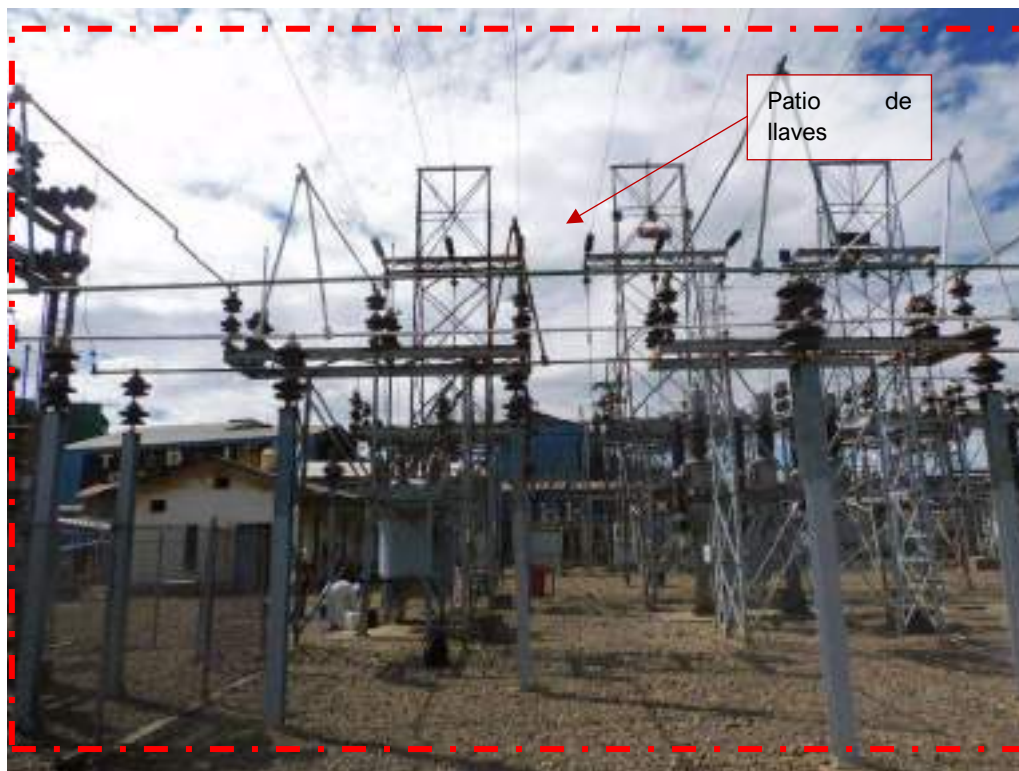
Fotografía 3.3-26 Vista de Patio de Llaves
