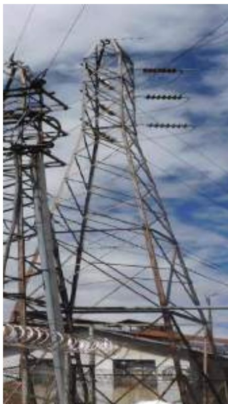
Fotografía 4-1 Torre Terminal de la línea de transmisión de 50 kV llegando a la S.E Paragsha I
