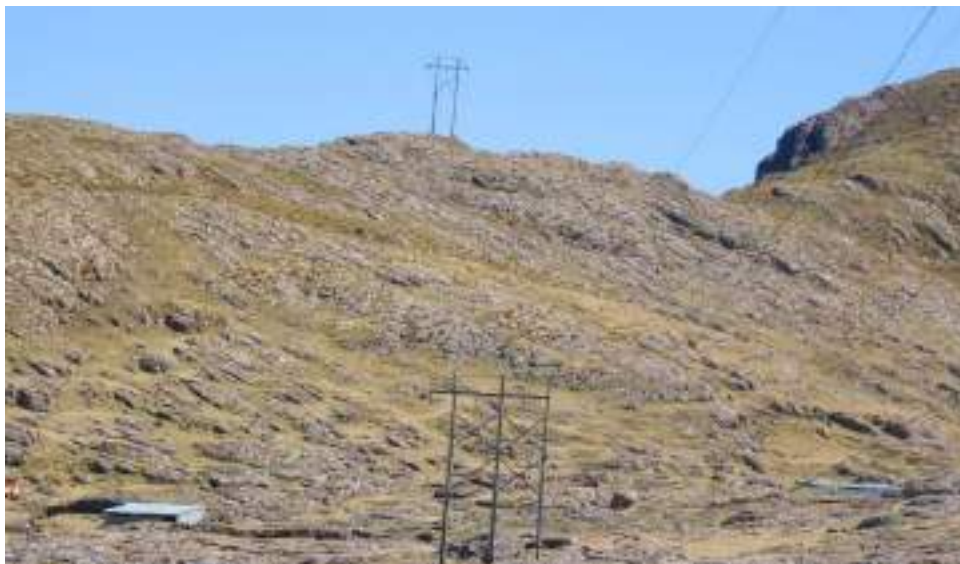
Fotografía 4-2 LT 50 kV simple terna saliendo desde la S.E. Huicra hacia la S.E. Goyllarisquizga
