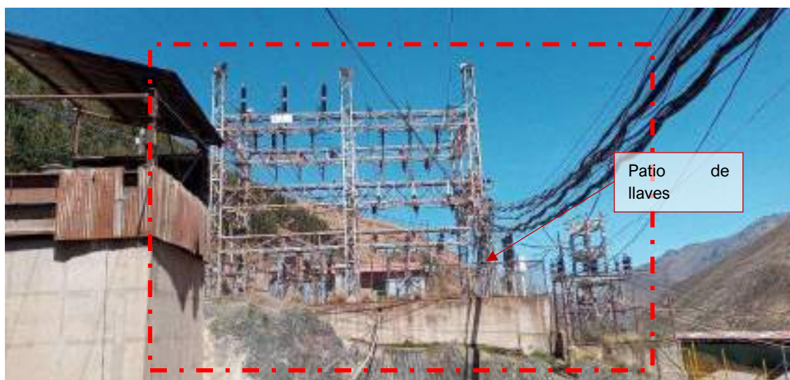
Fotografía 3.3-281 Vista de Patio de Llaves
