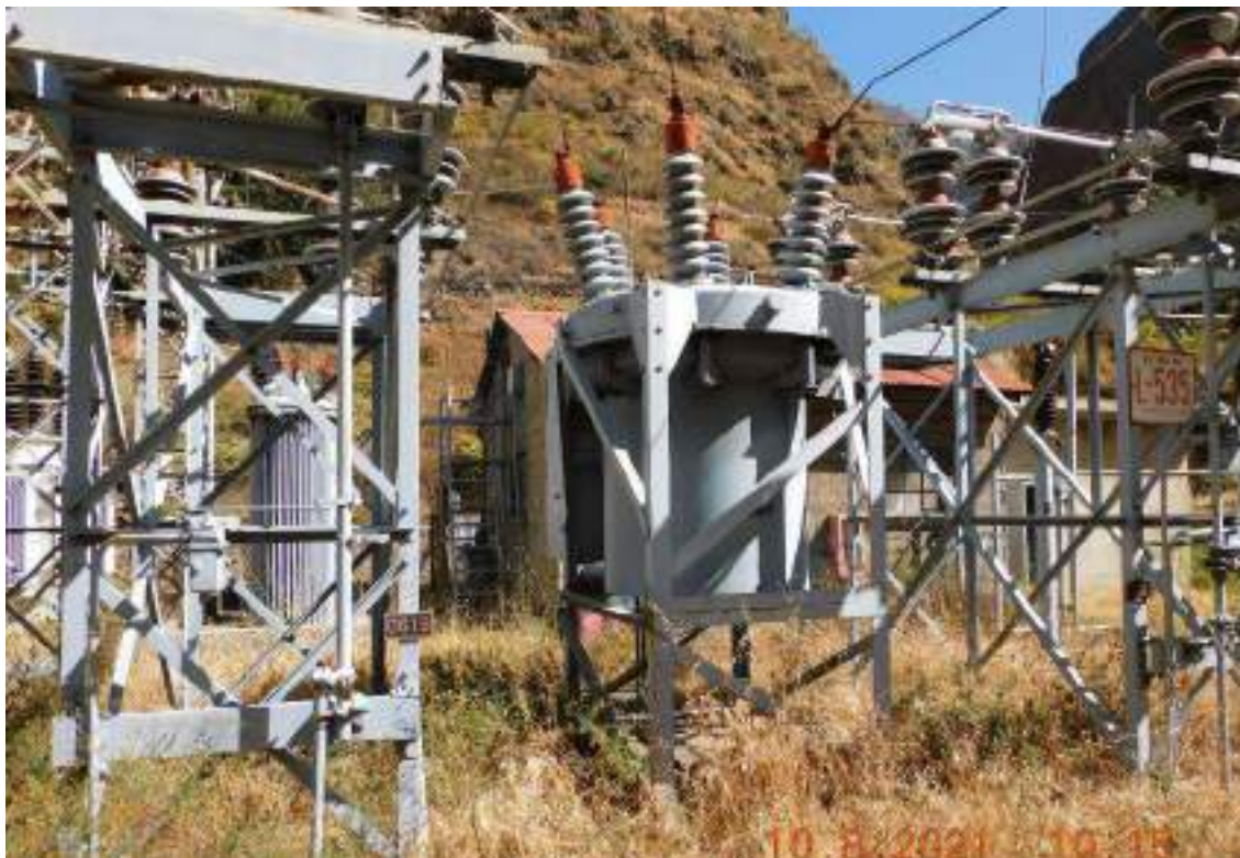
Fotografía 3.3-210 Vista de Interruptor de potencia 72.5 kV en aceite
