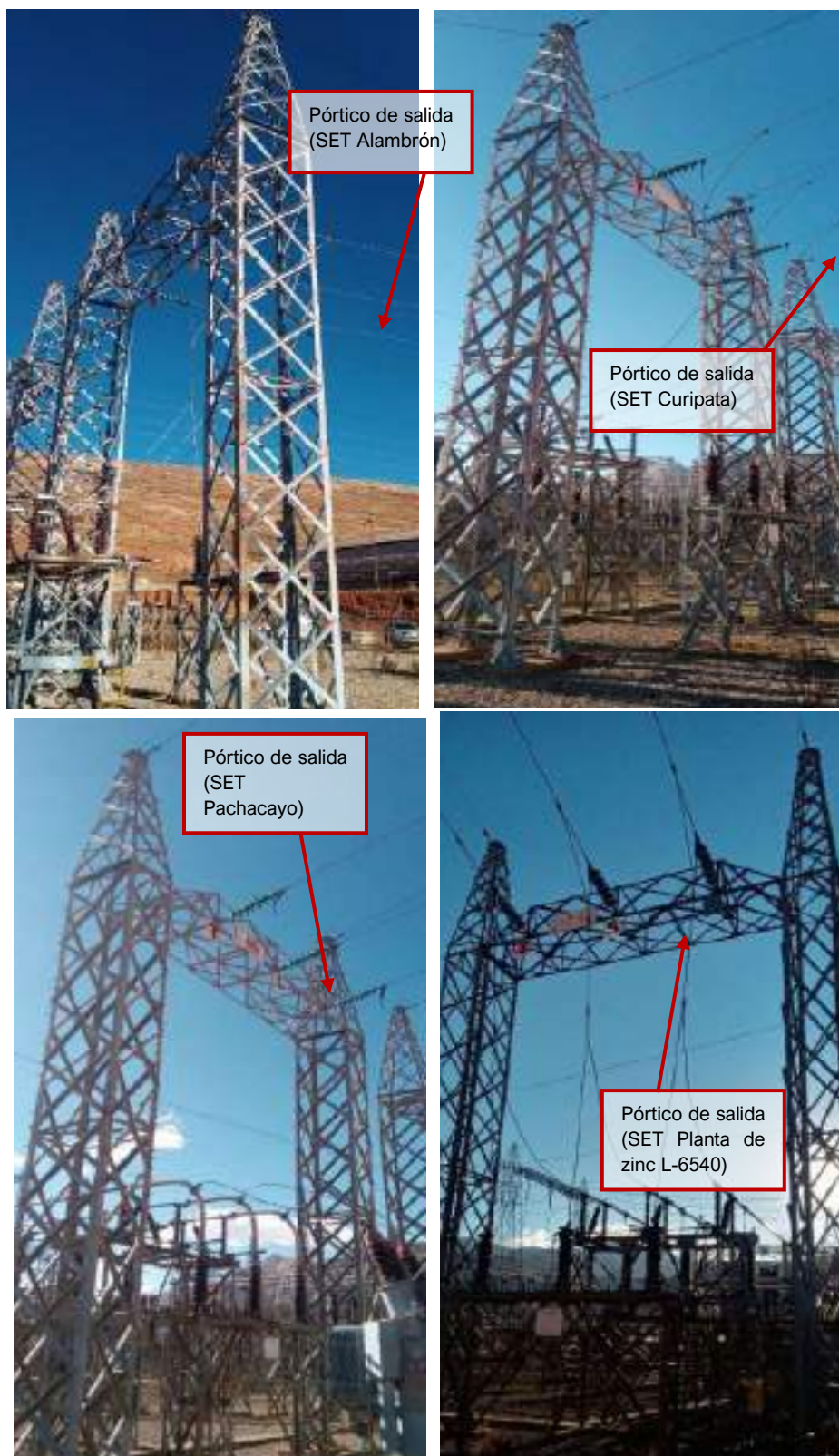
Fotografía 3.3-128 Vistas pórticos de Líneas de salida
