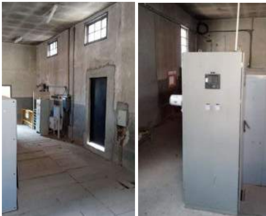
Fotografía 3.3-248 Vistas de interiores de Sala de Control
