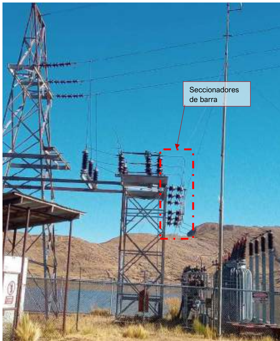
Fotografía 3.3-58 Vista de Seccionadores de barra
