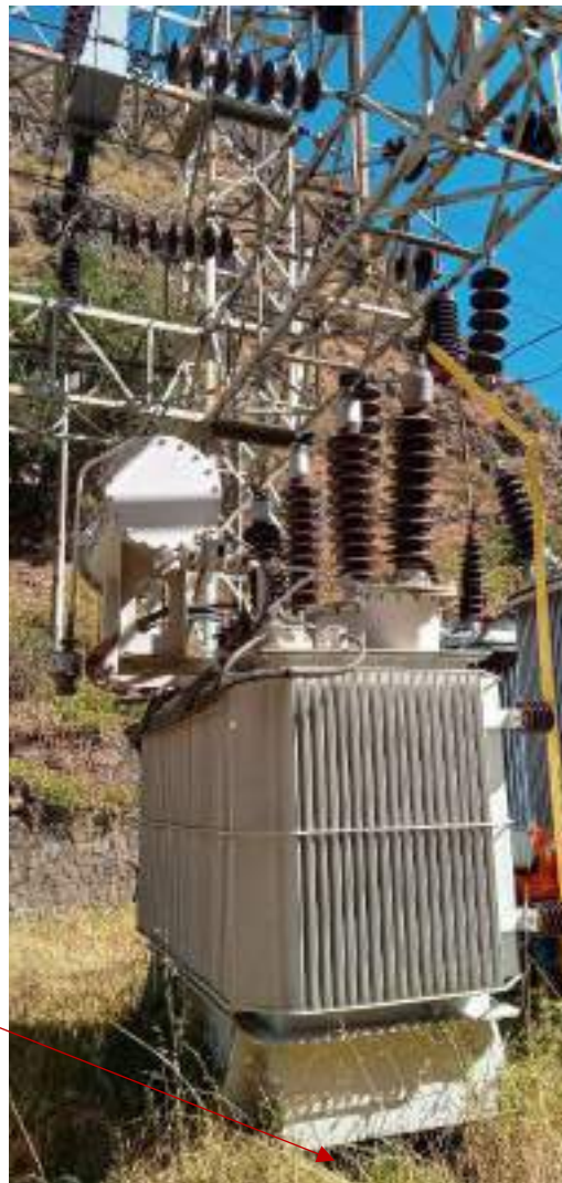
Fotografía 3.3-203 Vista Transformador trifásico de potencia(T1) 1.5 MVA S.E. San Mateo 50/4.16 kV
