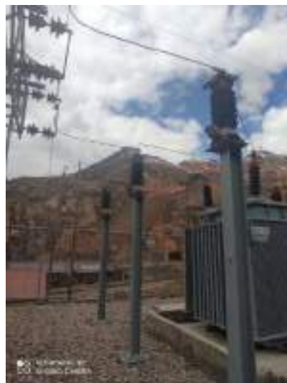
Fotografía 3.3-192 Vista de pararrayos
