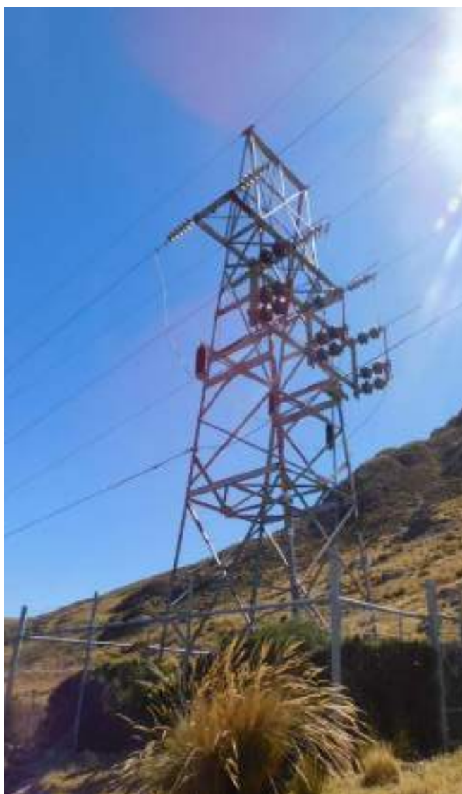
Fotografía 4-1 Pórtico de salida de LT 50 kV desde la S.E Huicra hacia la S.E. Goyllarisquiza
