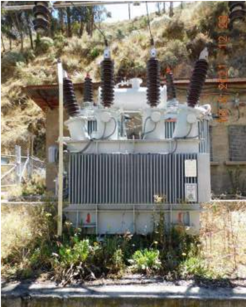
Fotografía 3.3-224 Vista Transformador trifásico de potencia(T1) 1.0 MVA S.E. Bellavista 50/2.4 kV
