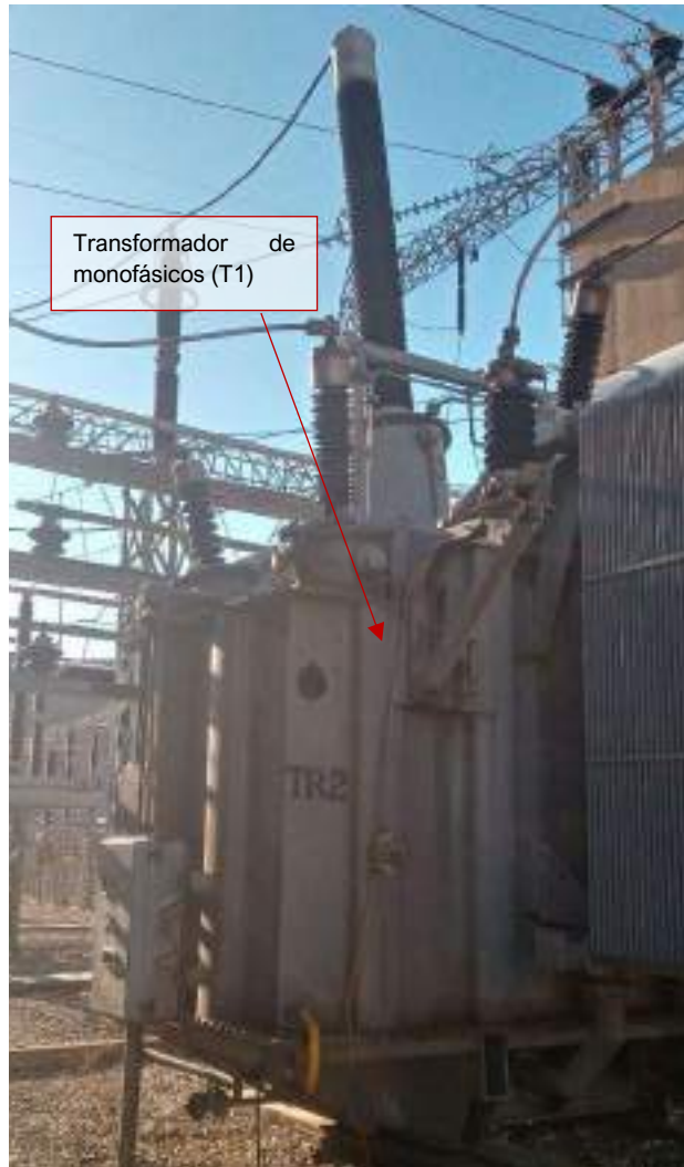
Fotografía 3.3-113 Vista de Transformador de potencia (T1) de 33.33 MVA
