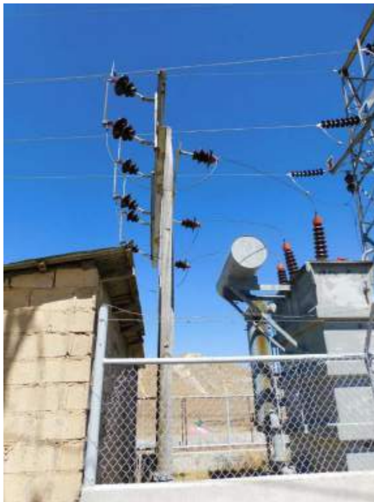
Fotografía 4-4 Seccionador fusible a lado de la línea de 50 kV.
