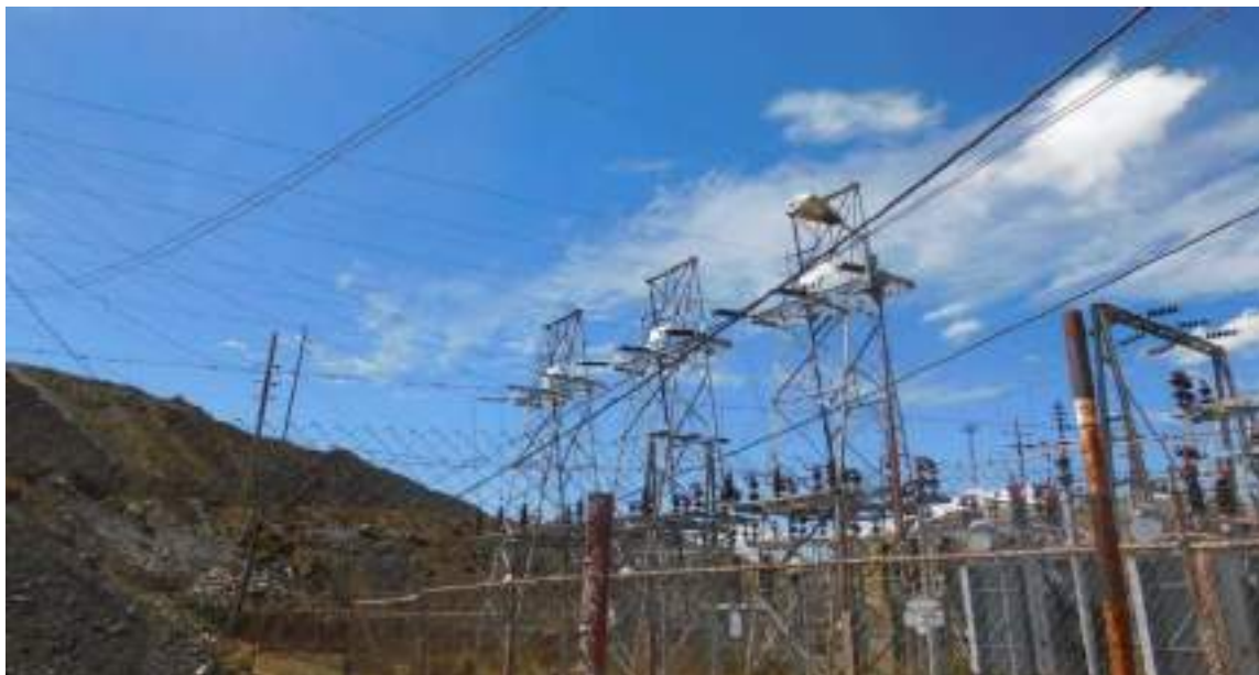
Fotografía 4-2 Pórtico de llegada de LT 50 kV simple terna a la S.E Excelsior desde la S.E. Vista Alegre.
