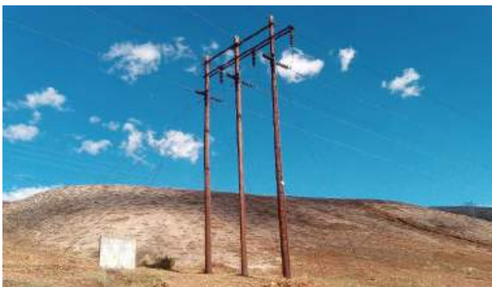
Fotografía 3-1 LT 50 kV de salida desde la C.H. Oroya Nueva hacia la S.E. Pachachaca
