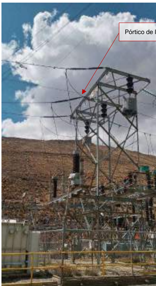
Fotografía 3.3-325 Pórtico de llegada LT 69 kV a la S.E. Chumpe desde CH Canchayllo
