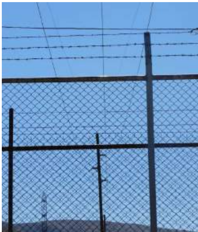
Fotografía 3-2 Salida de LT 50 kV desde la S.E. Mahr Tunel hacia la C.H. Pachachaca
