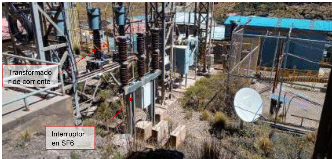
Fotografía 3.3-260 Vista de Interruptor de potencia en SF6 de 72.5 kV
