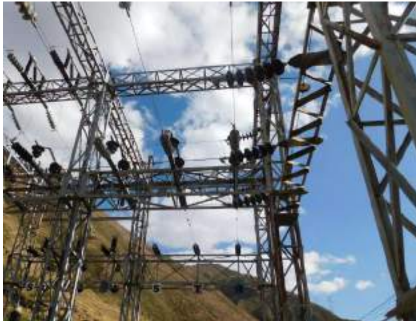
Fotografía 5-4 Seccionador de línea código 0605 0608T en 50 kV estan fuera de servicio.
