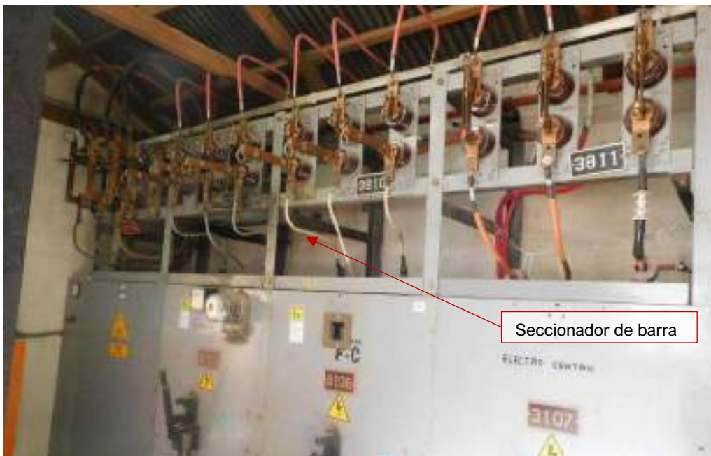
Fotografía 3.3-301 Vista Seccionador en el lado de la barra en 4.16 kV
