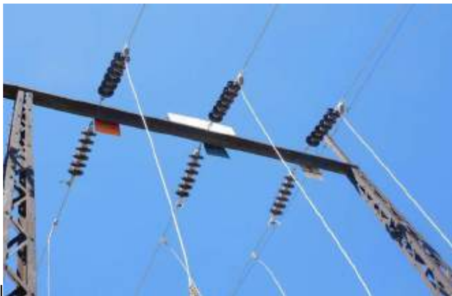
Fotografía 3-2 Pórtico de llegada de LT 50 kV desde la S.E. Vista Alegre a la S.E. Shelby
