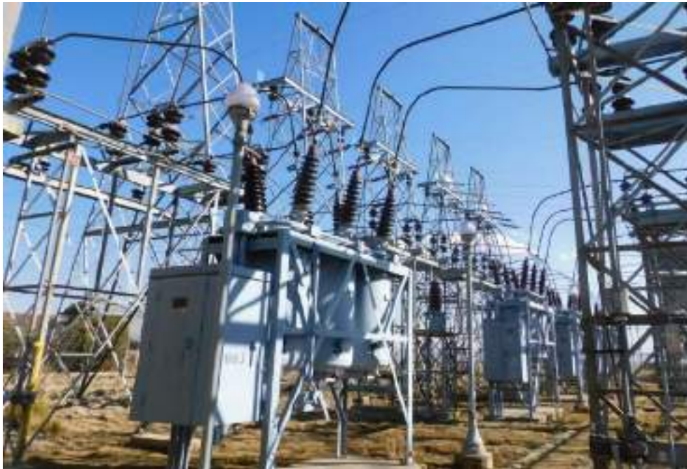
Fotografía 6-2 Interruptores de potencia de 50 kV
