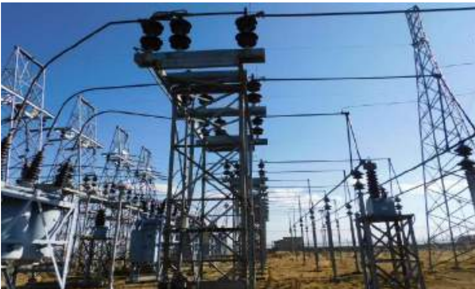
Fotografía 6-3 Juegos de seccionadores al lado de la barra de 50 Kv
