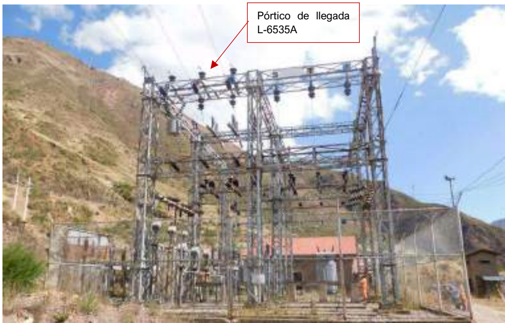
Fotografía 3.3-252 Vista Pórtico y Pórtico de Llegada LT 50 kV a la S.E. Antuquito desde la S.E. Carlos Francisco
