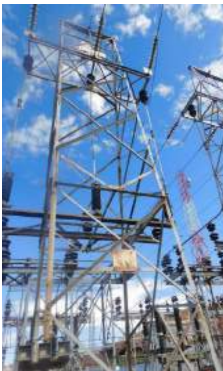
Fotografía 4-2 Pórtico de llegada de LT 50 kV simple terna a la S.E Paragsha I desde la S.E Excelsior.
