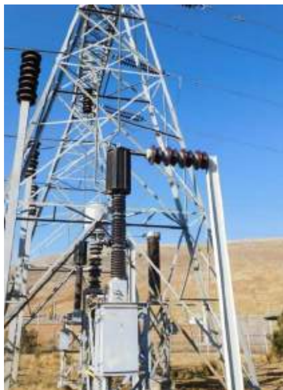
Fotografía 6-7 Transformador de tensión y pararrayos de 138 kV
