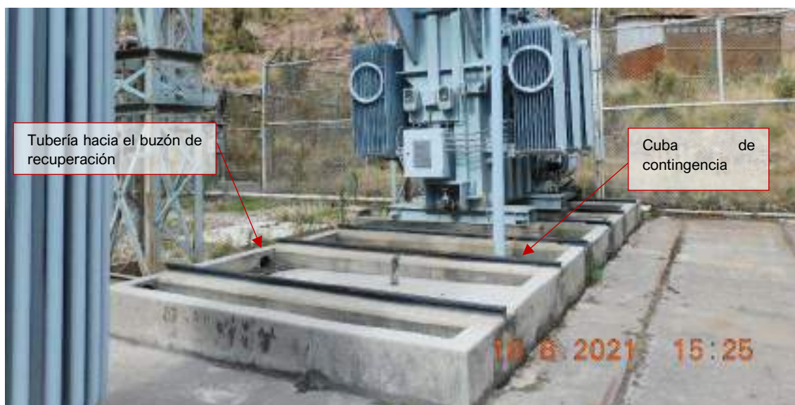
Fotografía 3.3-242 Cuba de contingencia en transformadores.
