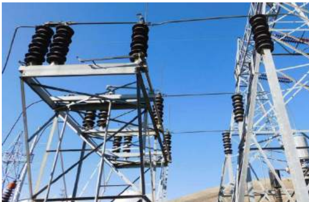
Fotografía 6-5 Seccionador de línea de 138 kV
