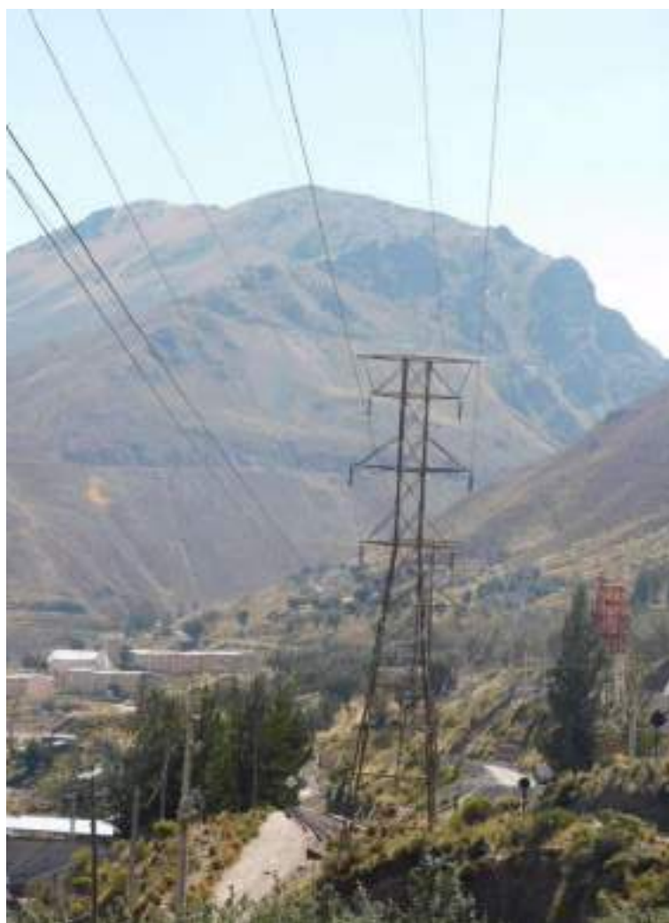
Fotografía 4-1 Salida de LT 50 kV desde la S.E. Carlos Francisco hacia S.E. Casapalca Norte
