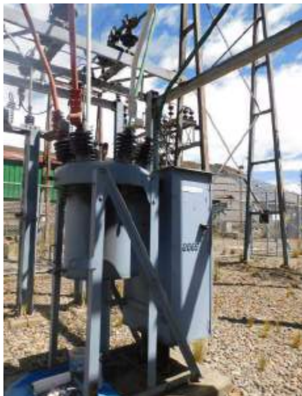
Fotografía 5-4 Interruptores de potencia en aceite de 12.6 kV.
