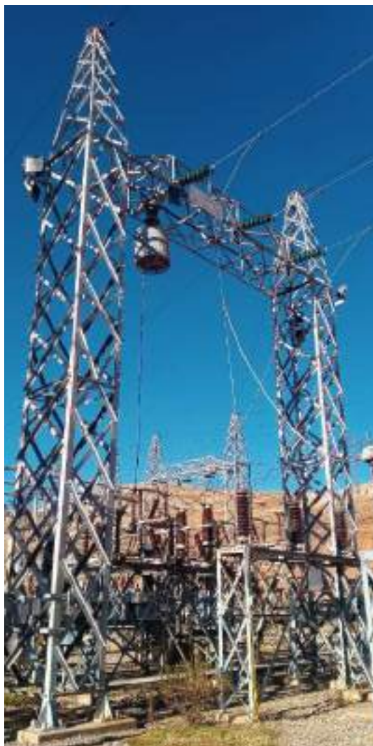
Fotografía 3-2 Pórtico de salida LT 50 kV desde C.H. Oroya Nueva hacia S.E Pachachaca
