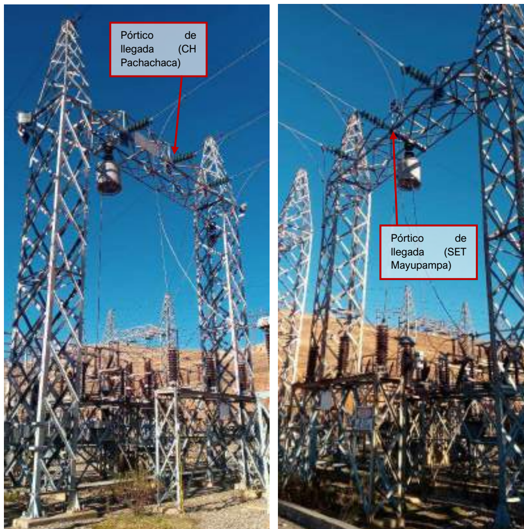
Fotografía 3.3-127 Vistas pórticos de Líneas de Llegada
