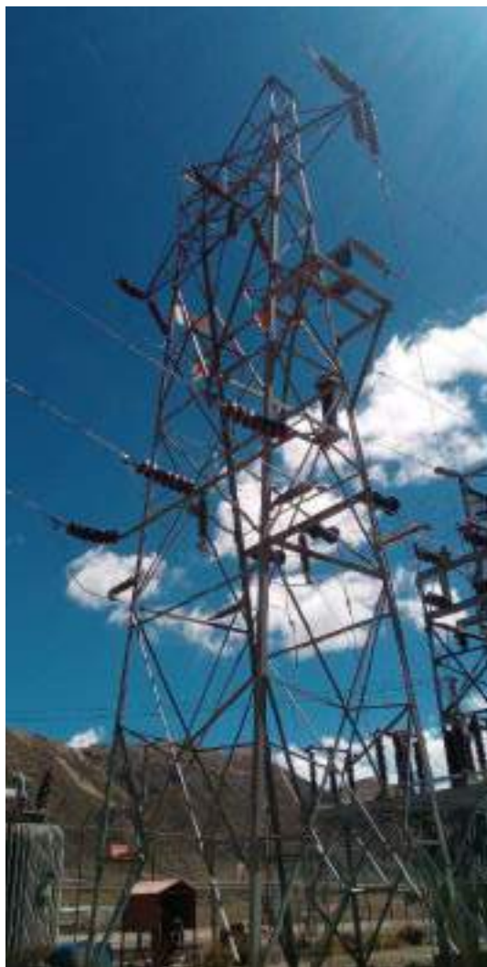
Fotografía 3.3-165 Pórtico de salida de LT 50 kV desde S.E San Cristóbal hacia S.E. Pachachaca (lado derecho)
