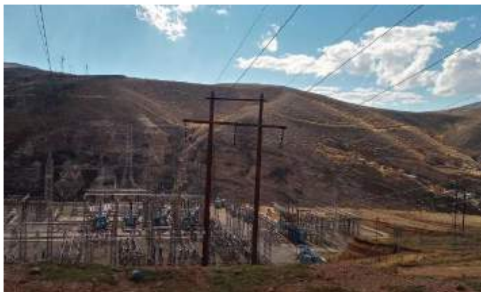
Fotografía 6-1 LT de 50 kV de salida desde la S.E Oroya Nueva a la S.E. Planta Zinc
