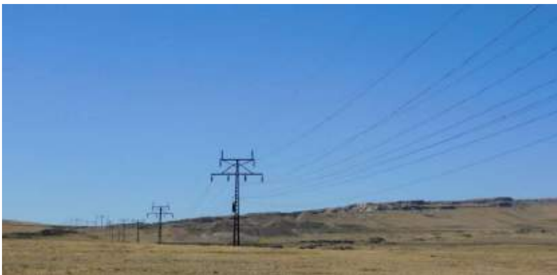
Fotografía 4-2 Línea de transmisión de 50 kV de salida de la S.E Vista Alegre hacia S.E. Buenavista.
