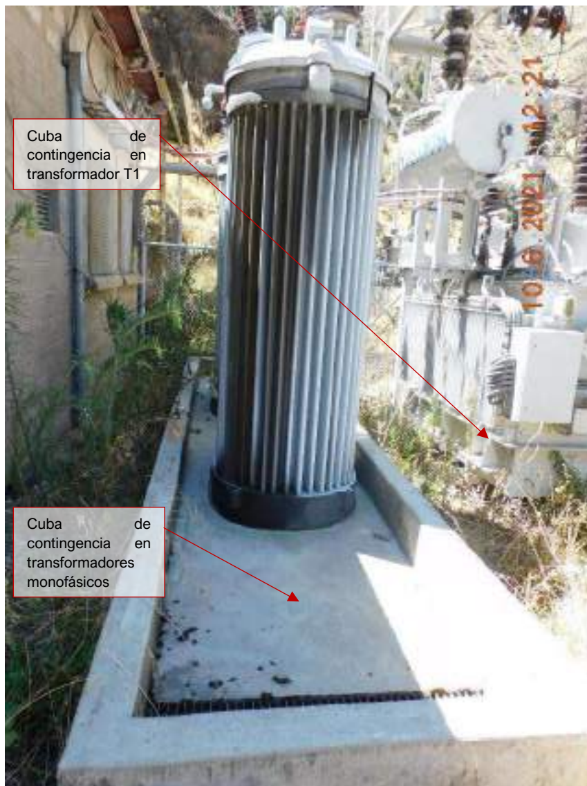
Fotografía 3.3-227 Cuba de contingencia en transformadores.
