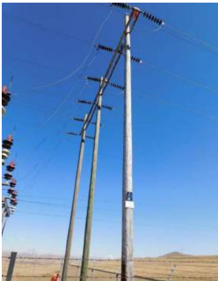
Fotografía 4-1 Pórtico de llegada de LT 50 kV simple terna de la S.E Vista Alegre
