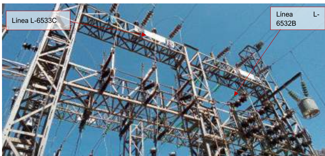
Fotografía 3.3-268 Vista Pórtico y líneas de llegada LT 50 kV a la S.E. Carlos Francisco desde la S.E. Nueva Morococha
