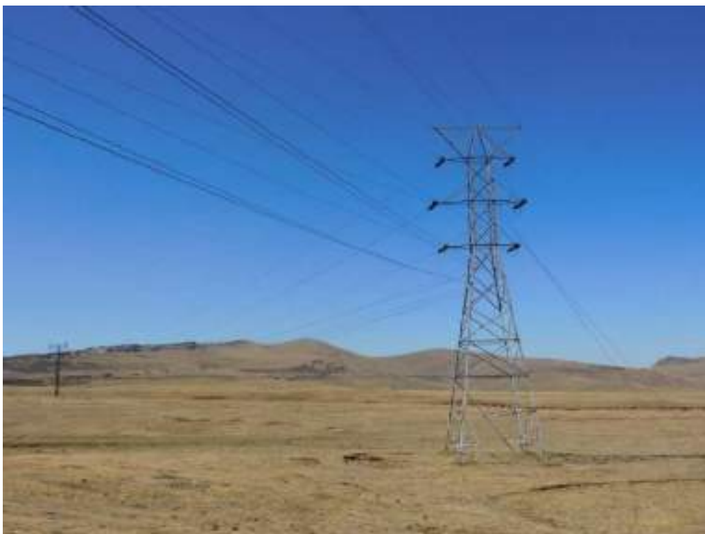
Fotografía 6-2 Línea de transmisión de 50 kV de salida de la S.E Vista Alegre hacia S.E. Shelby.
