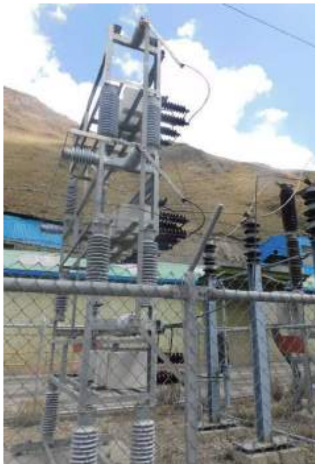
Fotografía 4-5 Banco de condensadores de 3.23 MVAR en 69 kV
