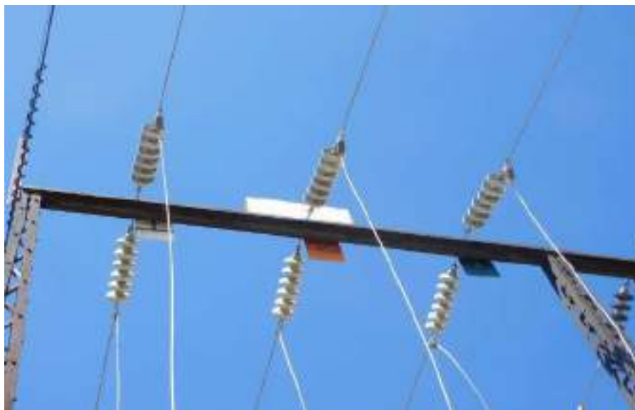
Fotografía 4-1 Pórtico de llegada de LT 50 kV de S.E. Buenavista hacia S.E. Shelby
