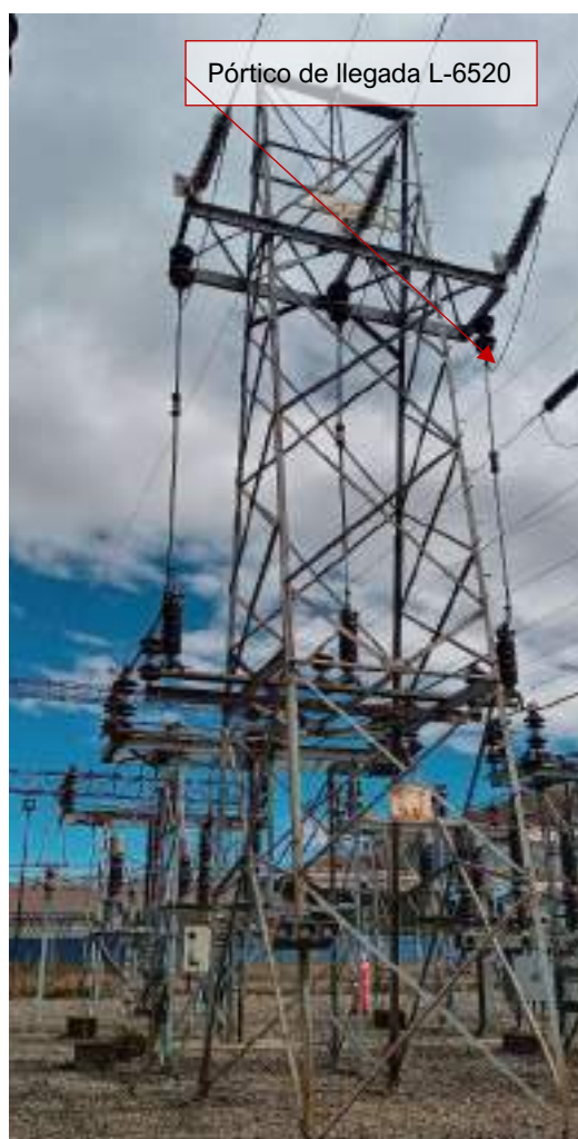
Fotografía 3.3-35 Vista Pórtico de Llegada de LT 50 kV simple terna a la S.E Paragsha I desde la S.E Excelsior
