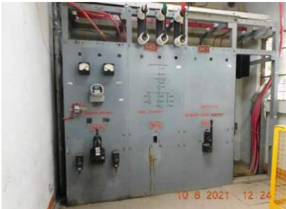
Fotografía 3.3-232 Vistas de interiores de Sala de Control
