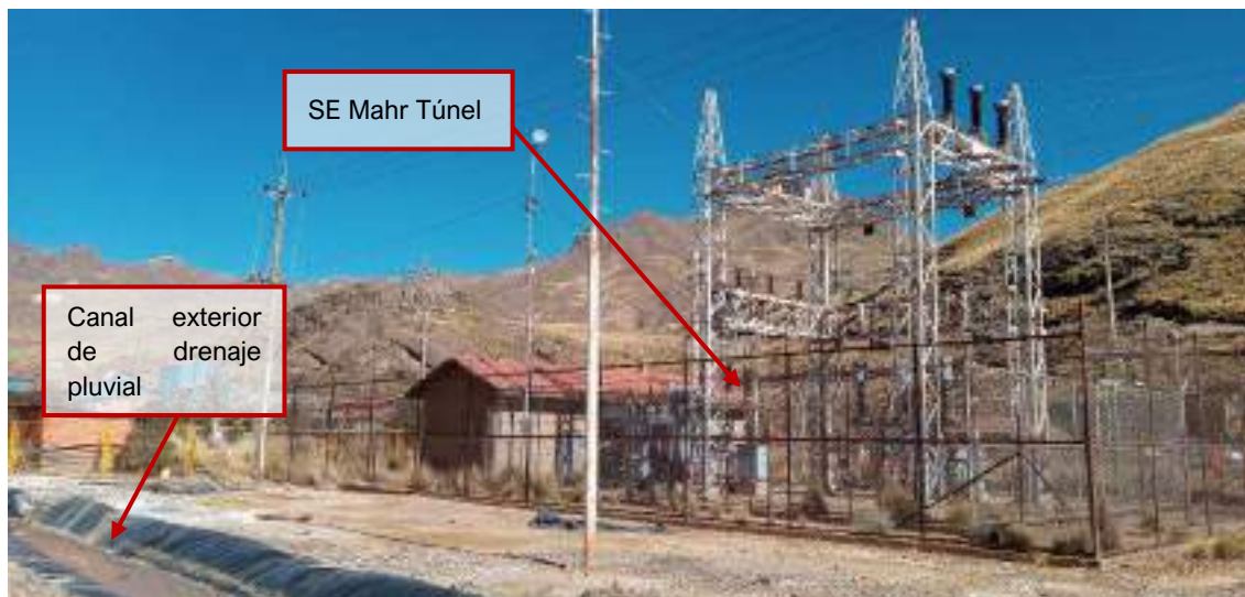
Fotografía 3.3-140 Vista de Canal de drenaje
