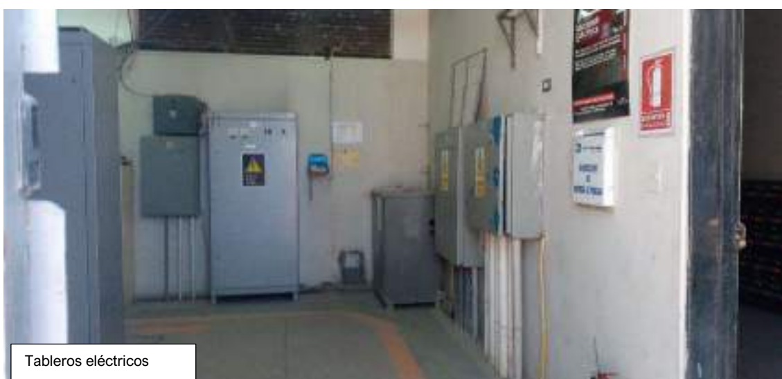
Celdas de control
