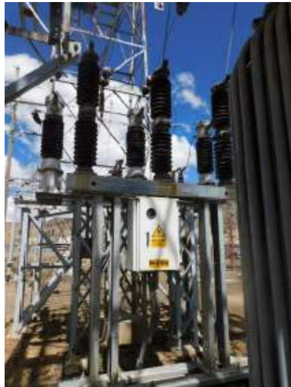
Fotografía 3.3-156 Vista de Interruptor de potencia 72.5 kV en SF6
