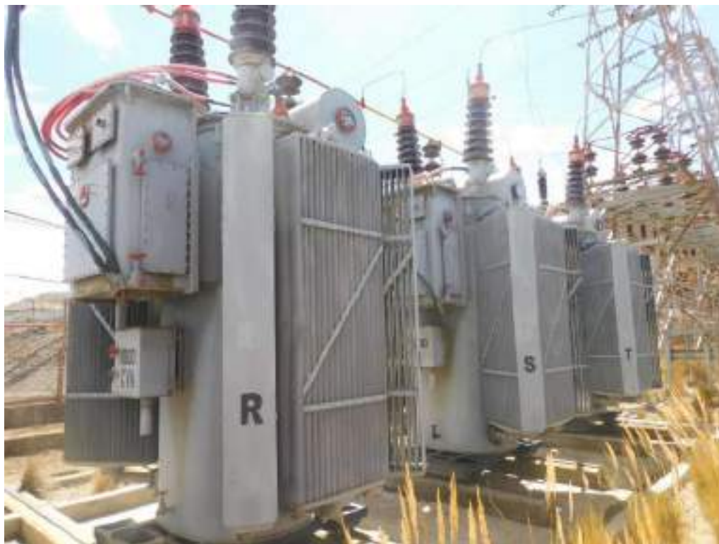
Fotografía 5-3 Transformador de monofásicos de 3x1 MVA, S.E. Excelsior 27.4/2.4 kV
