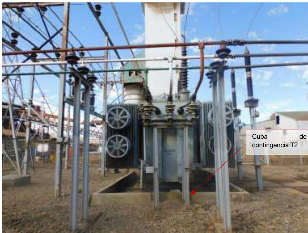
Fotografía 3.3-24 Cuba de contingencia en transformadores.
