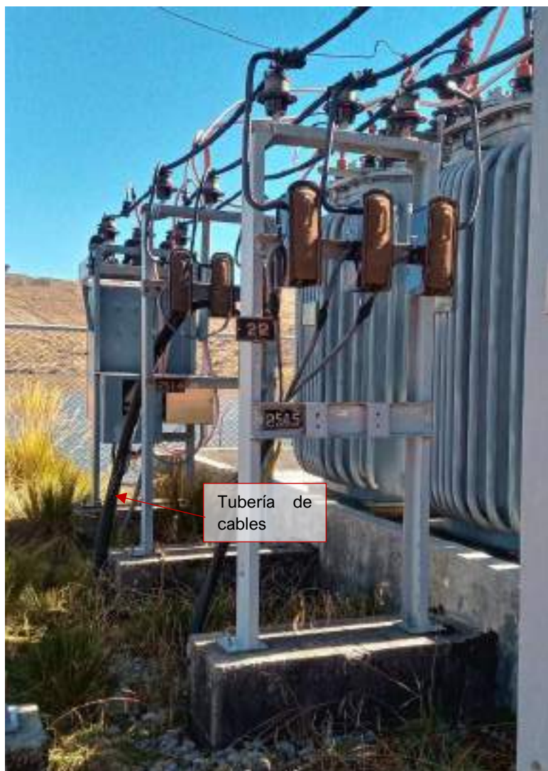
Fotografía 3.3-59 Vista de canaleta de cables
