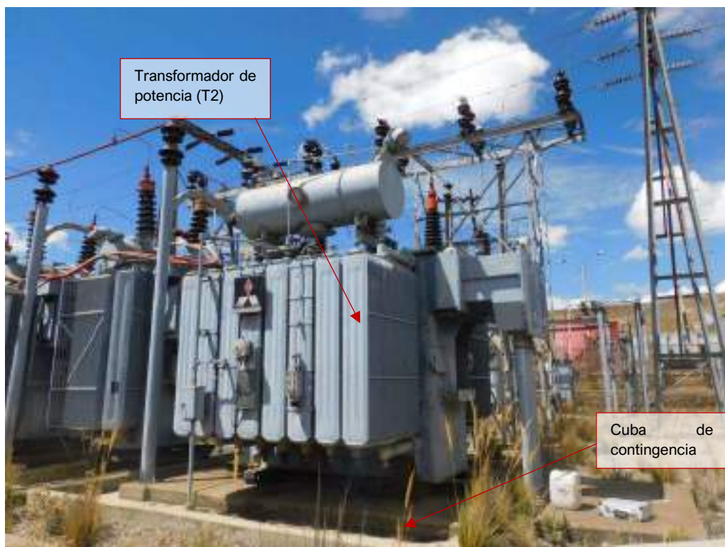
Fotografía 3.3-3 Vista de Transformador de potencia (T2) de 10 MVA
