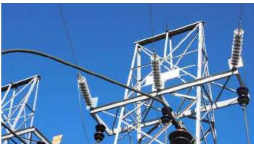
Fotografía 3-1 Pórtico de salida de LT 50 kV de la S.E. Carhuamayo hacia S.E. Shelby
