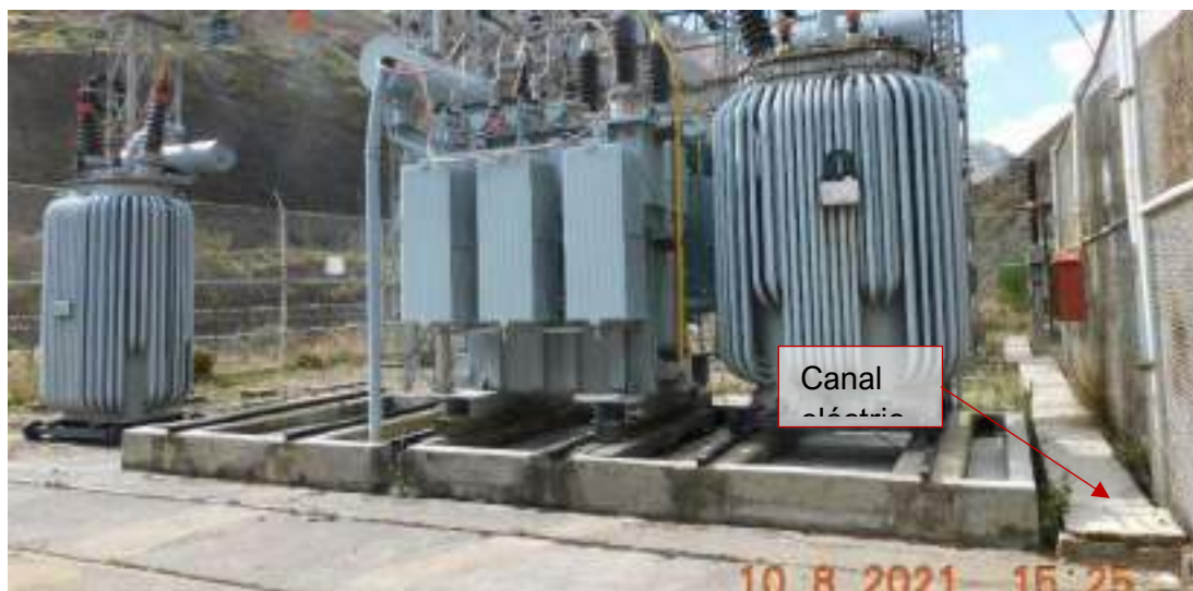
Fotografía 3.3-249 Vista de canal eléctrico
