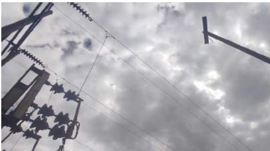
Fotografía 3-1 Llegada de LT 50 kV desde la S.E. Mina Carahuacra a la S.E San Antonio
