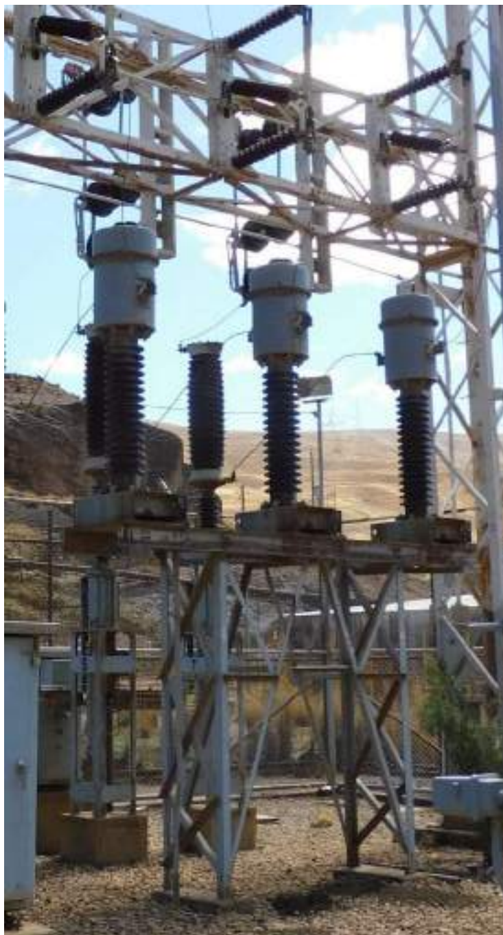
Fotografía 3.3-138 Vista de Transformadores de corriente
