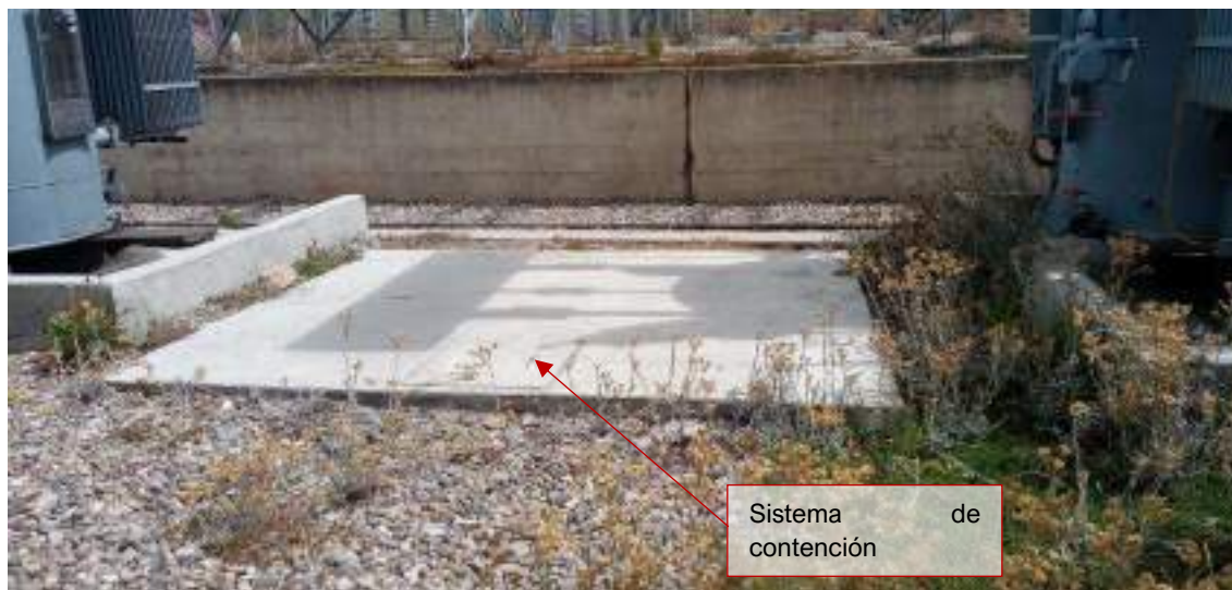
Fotografía 3.3-314 Vista del Sistema de contención
