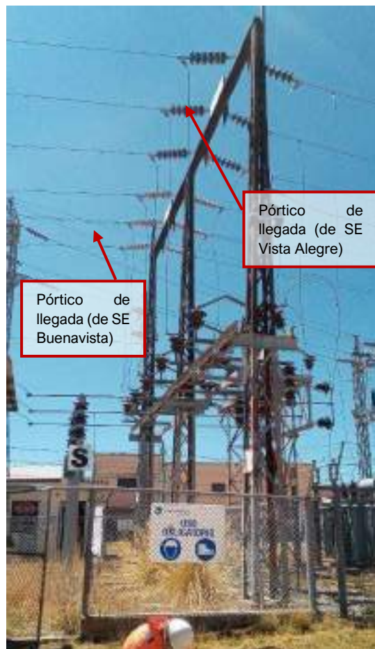
Fotografía 3.3-90 Vista de Líneas de Llegada
