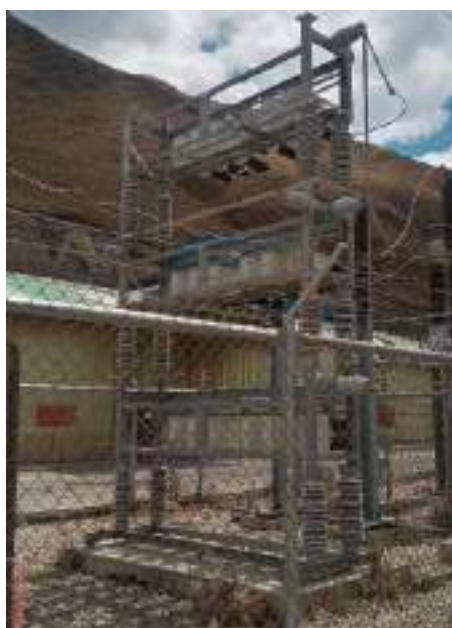
Fotografía 3.3-320 Vista de banco de condensadores de 3.23 MVAR en 69 kV
