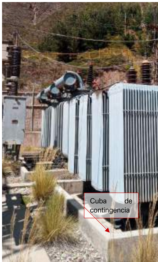
Fotografía 3.3-279 Cuba de contingencia en transformadores.
