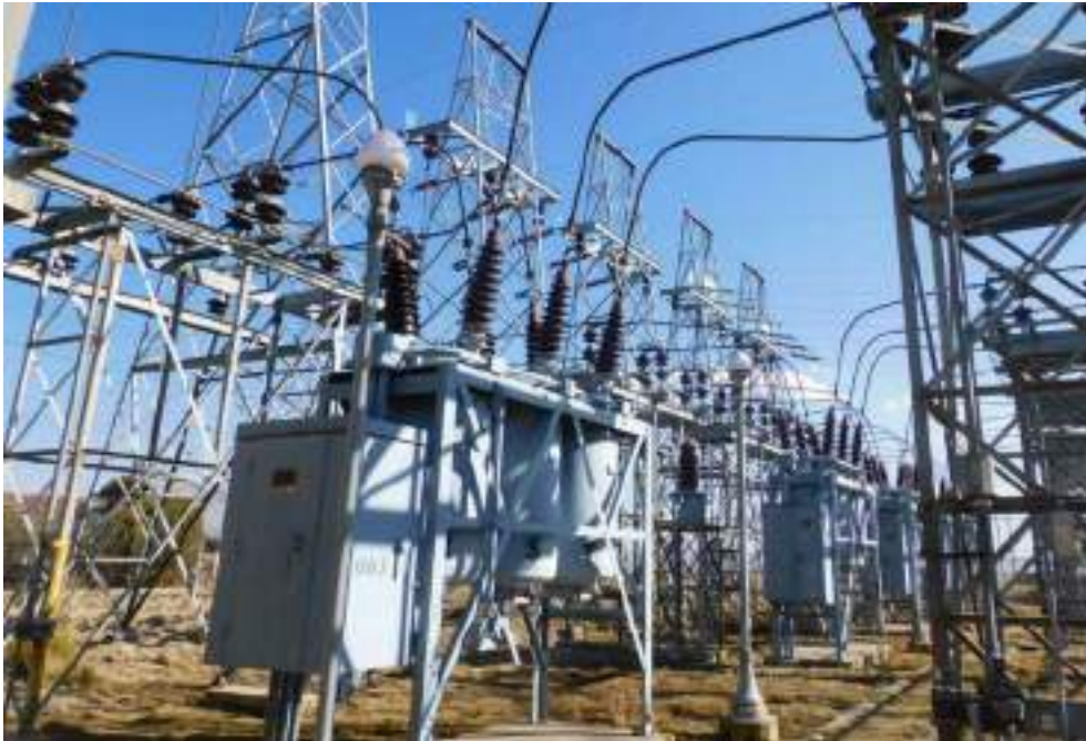
Fotografía 3.3-98 Vista de Interruptores de potencia de 50 kV
