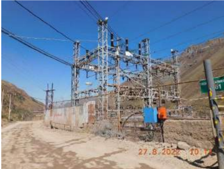
Fotografía 20: Vista general de la Zona STE Centro 18 (SE Casapalca), ubicado en el distrito de Chicla, provincia de Huarochiri.
