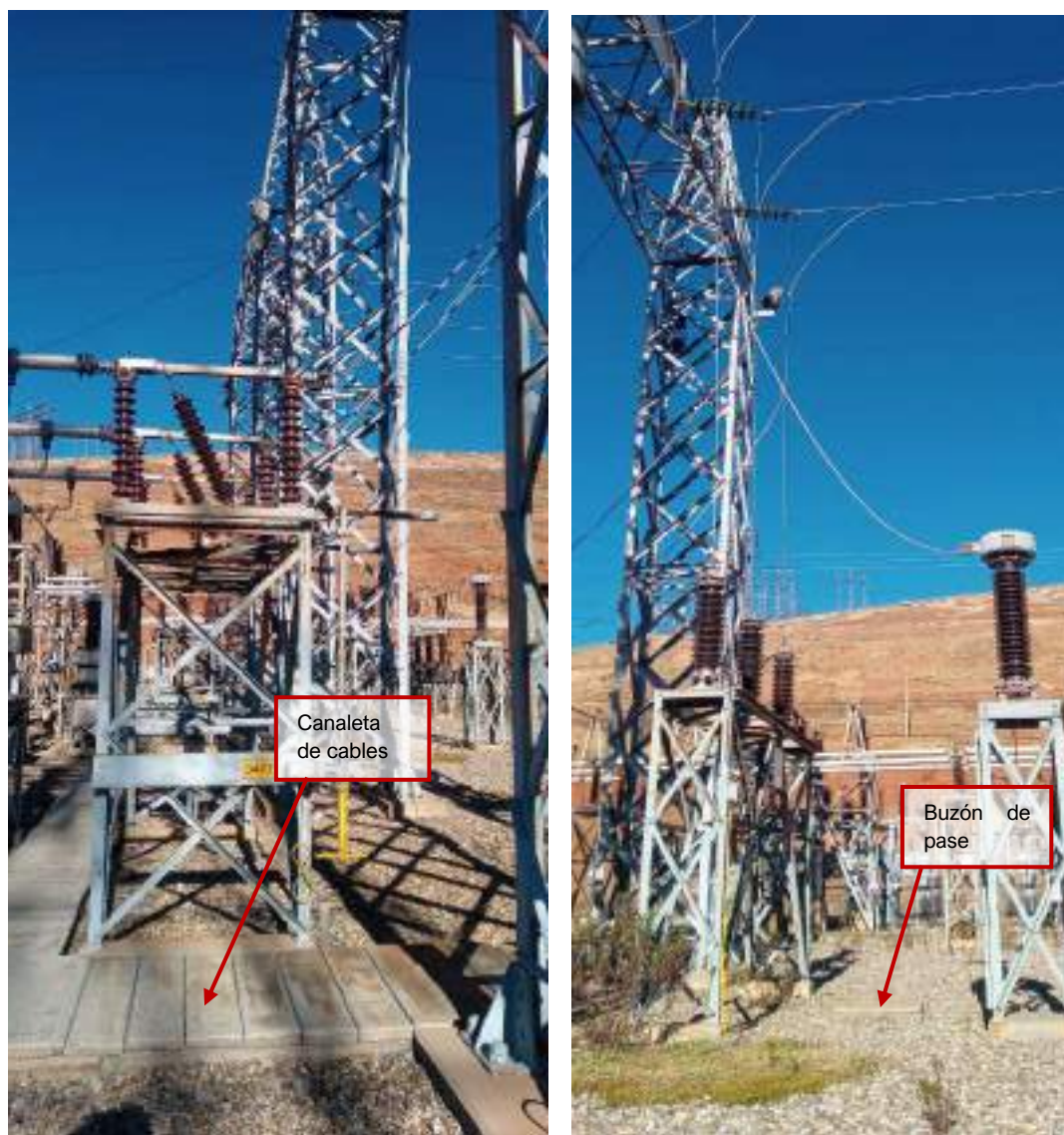
Fotografía 3.3-125 Vista de canaleta y buzón de pase de tubería de cables
