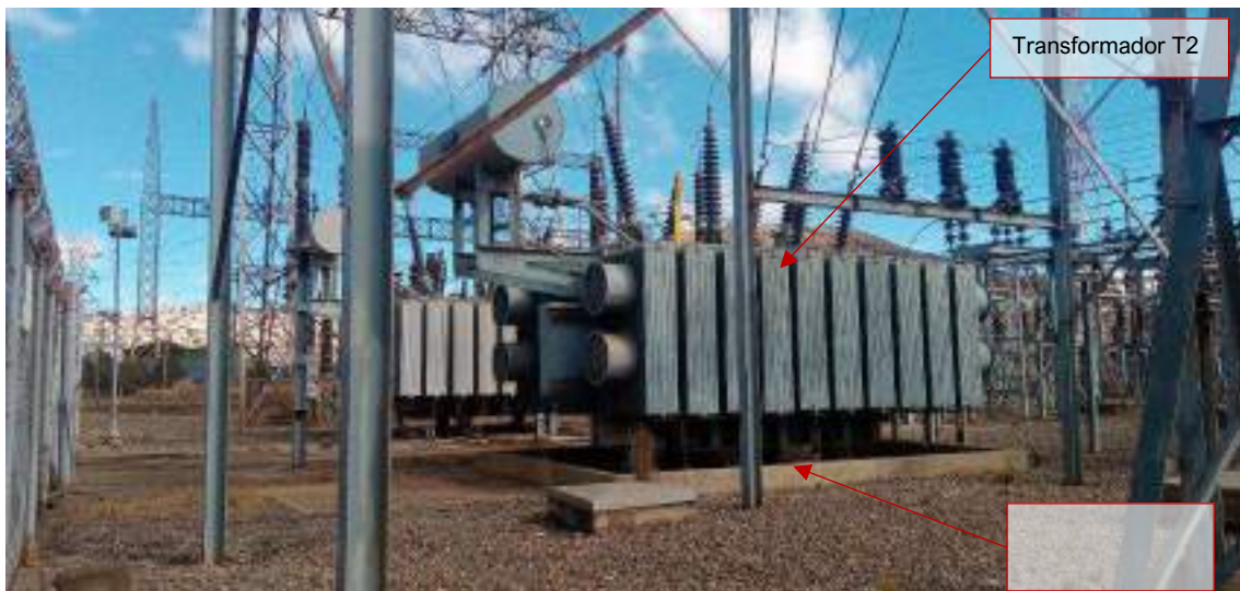
Fotografía 3.3-22 Vista Transformador trifásico T2 de potencia 44/35/44 MVA - 117/46/11 kV
