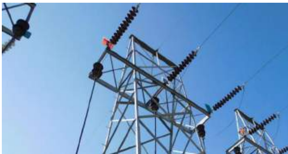
Fotografía 4-1 Pórtico de salida de LT 50 kV de S.E. Carhuamayo hacia S.E. Junín
