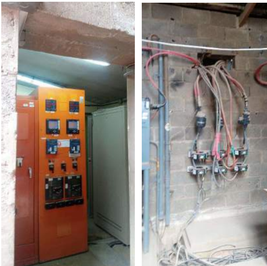
Fotografía 3.3-160 Vistas de interiores de Sala de Control
