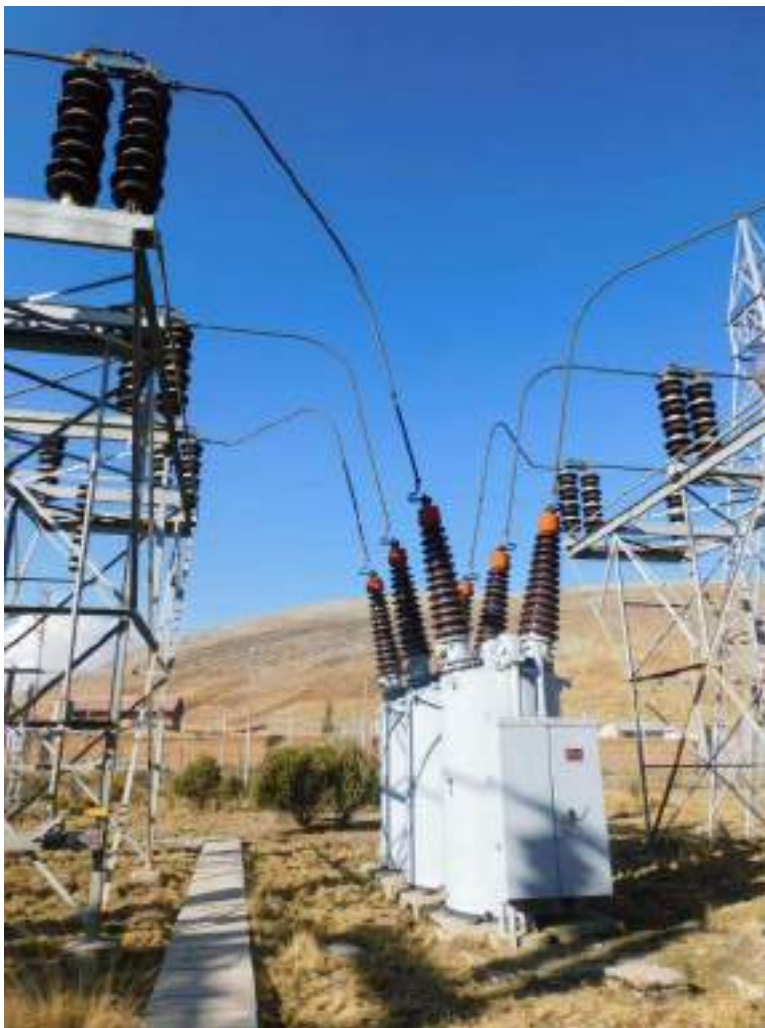
Fotografía 3.3-99 Vista de Interruptor de potencia de 138 kV
