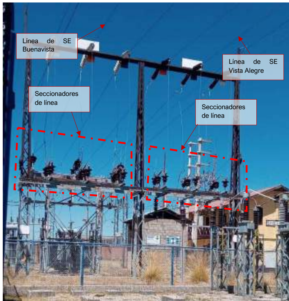
Fotografía 3.3-86 Vistas de Seccionadores de línea
