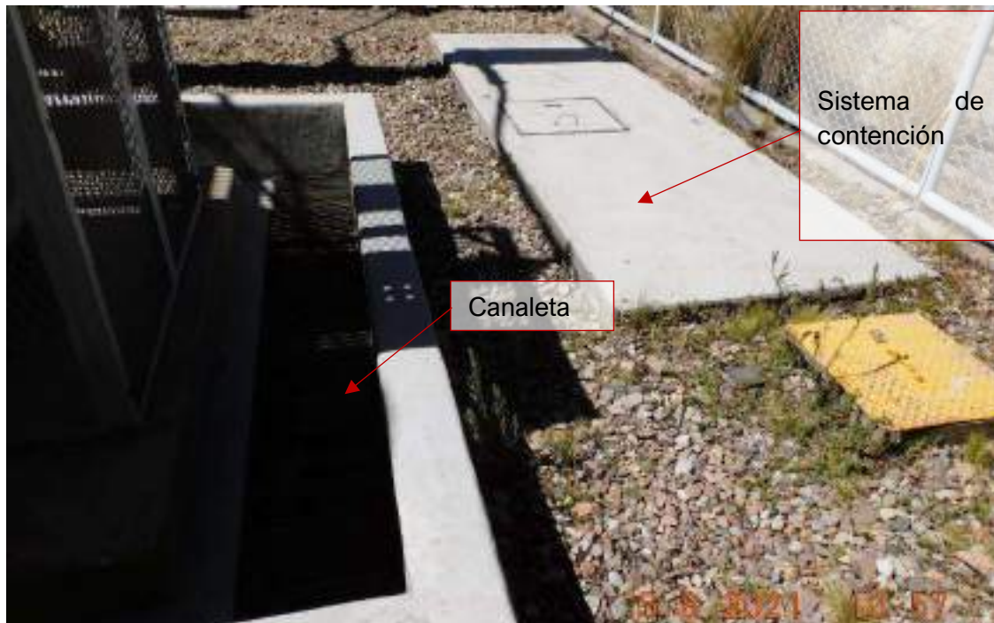
Fotografía 3.3-170 Vista del Sistema de contención
