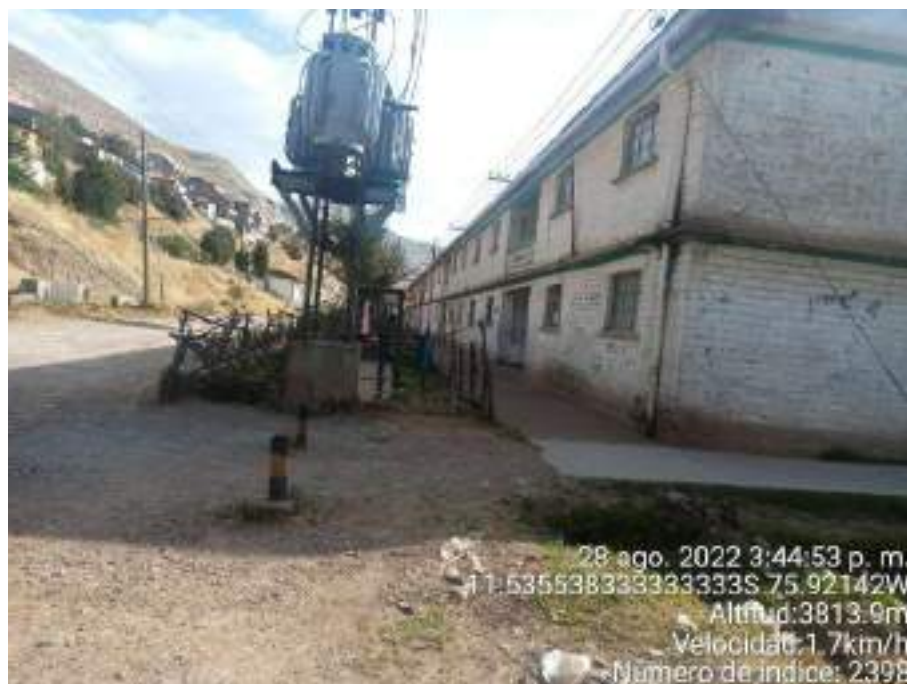
Fotografía 27: Asociación de Vivienda Buenos Aires, se puede apreciar las redes de alumbrado público, además de las conexiones de energía a viviendas.
