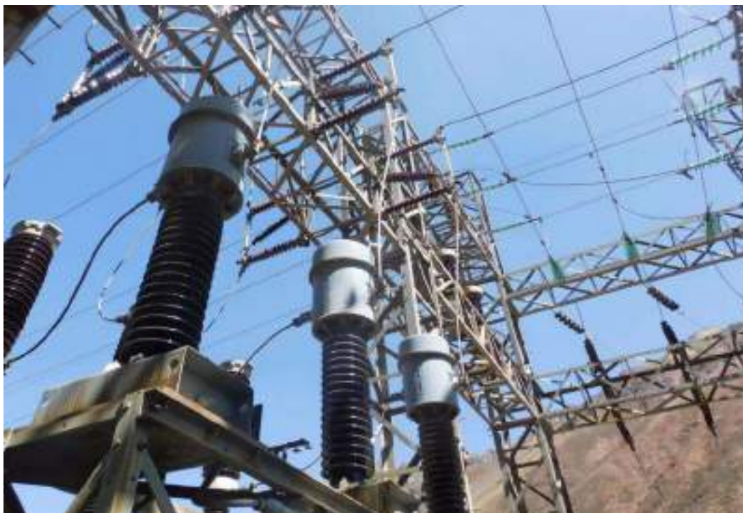
Fotografía 3.3-261 Vista Transformadores de corriente en 50 kV
