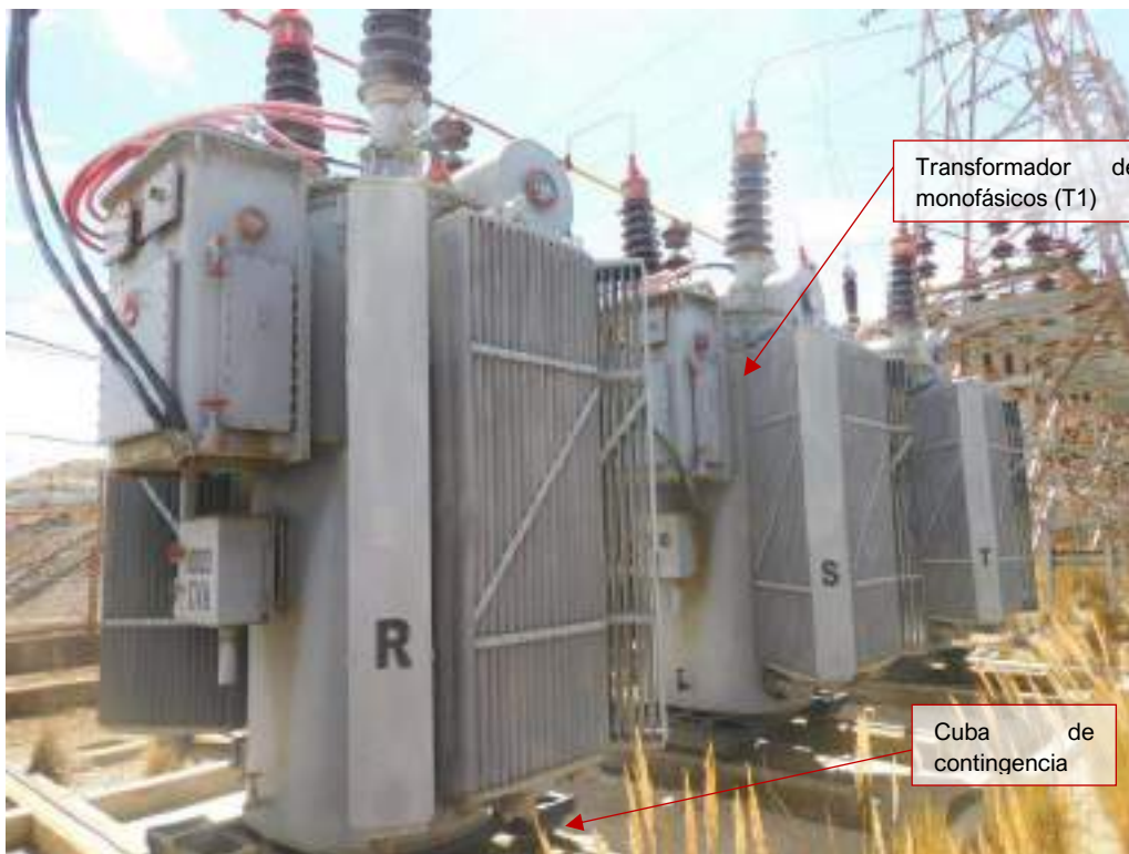
Fotografía 3.3-2 Vista de Transformador de monofásicos (T1) de 3x1 MVA
