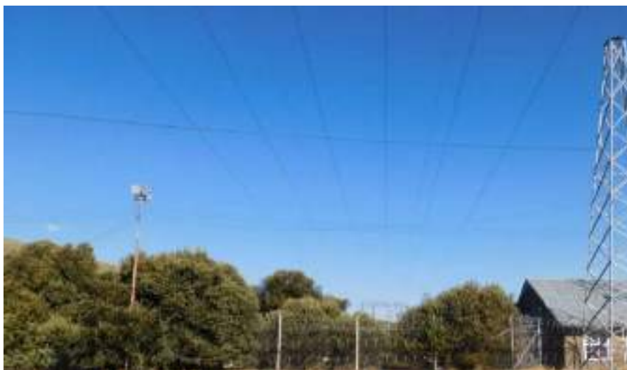
Fotografía 4-2 Salida de la LT 50 kV desde la S.E. Carhuamayo hacia S.E. Junín (conductores de lado derecho)
