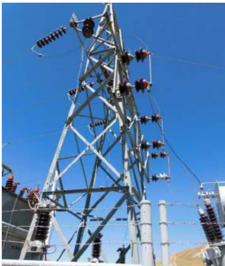
Fotografía 4-1 Pórtico de salida LT 50 kV desde la S.E. San Juan hacia S.E. Vista Alegre
