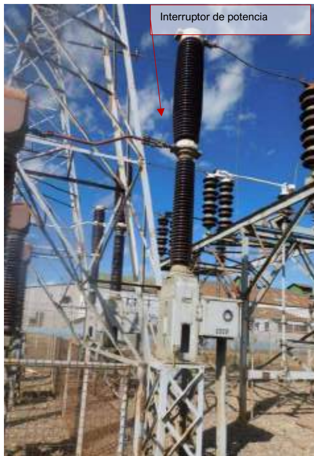
Fotografía 3.3-28 Vista Interruptor de potencia 138 kV
