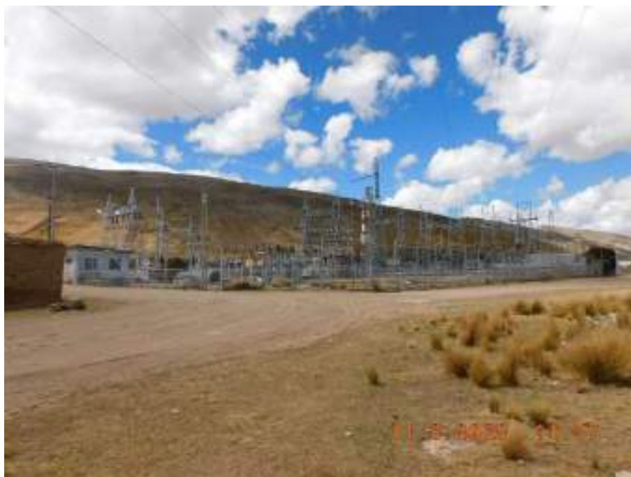
Fotografía 1: Zona STE Centro 8 (SE Carhuamayo), ubicado en el distrito Carhuamayo (provincia Junín). En el entorno inmediato se identificaron poblados denominados Chivian y Miraflores, ubicados a 15 m y 35 m, respectivamente, de la SE Carhuamayo.
