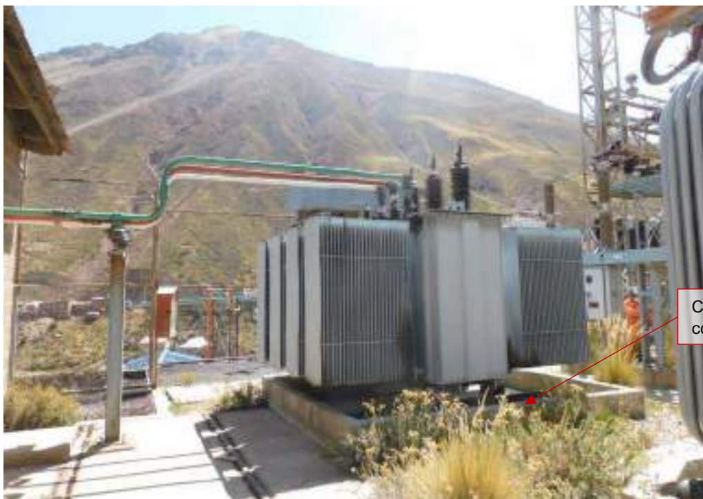
Fotografía 3.3-276 Vista Transformador de potencia trifásico 50/2.4 kV (T1)
