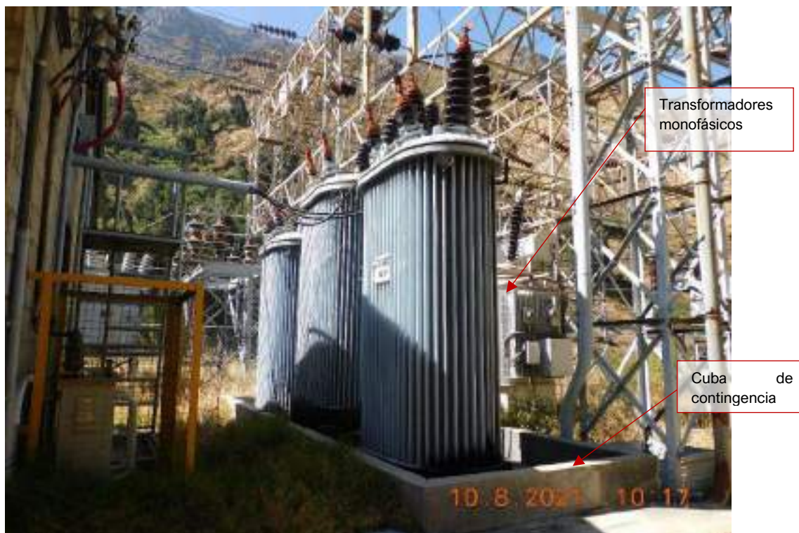
Fotografía 3.3-204 Vista de 03 Transformadores monofásicos de 0.5 MVA S.E. San Mateo 50/4.16 kV (fuera de servicio)
