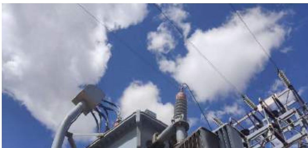
Fotografía 3-1 Salida de LT 50 kV desde la S.E. San Cristóbal hacia S.E. San Antonio
