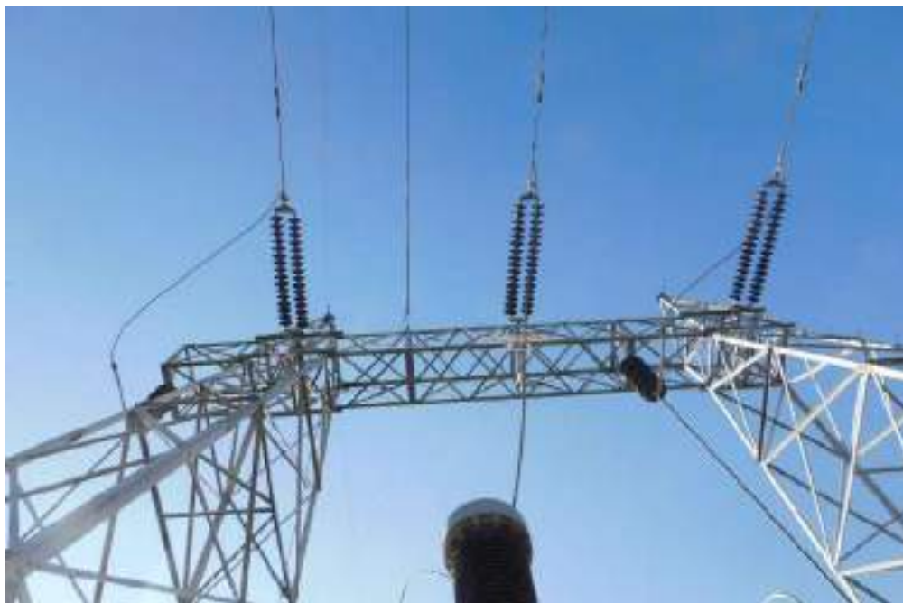
Fotografía 5-1 Pórtico de salida de la S.E. Carhuamayo hacia la S.E. Caripa
