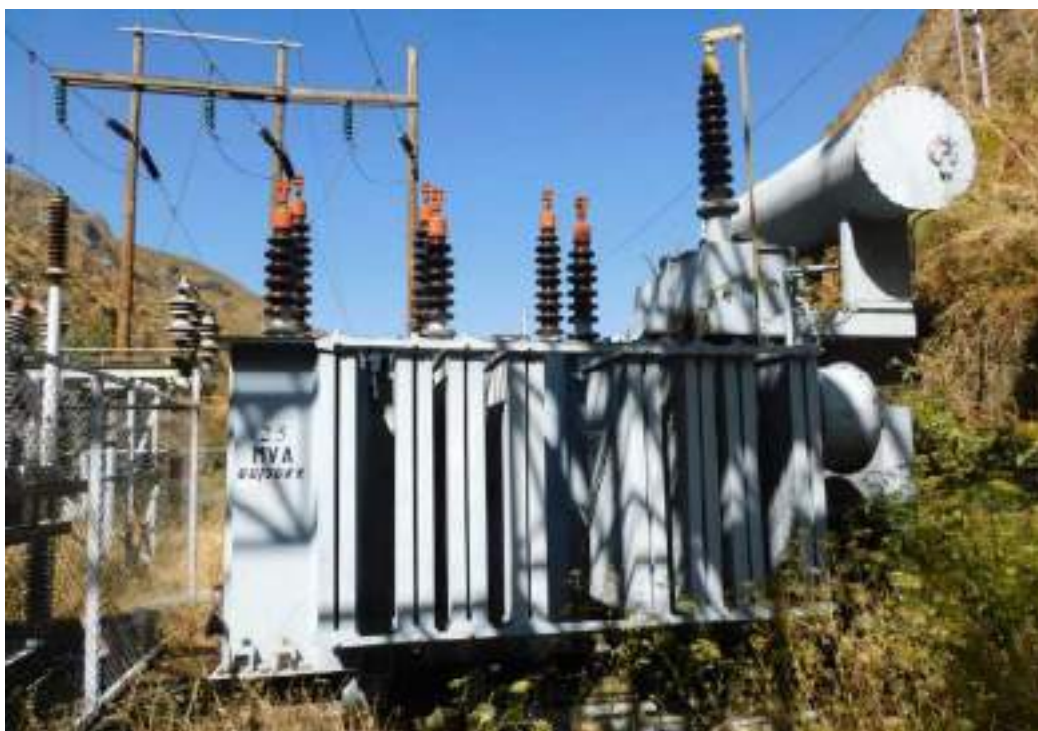
Fotografía 3.3-205 Vista Transformador trifásico (fuera de servicio)
