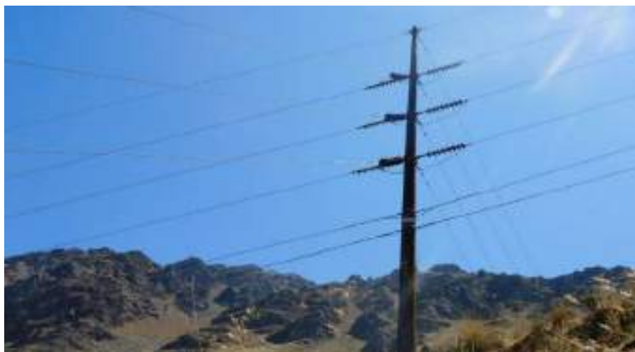
Fotografía 3-1 Poste derivación LT 50 kV de llegada a la S.E. Bellavista
