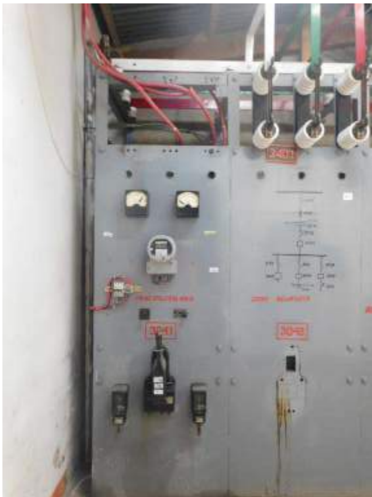
Fotografía 3.3-229 Vista de Interruptor de potencia 2.4 kV
