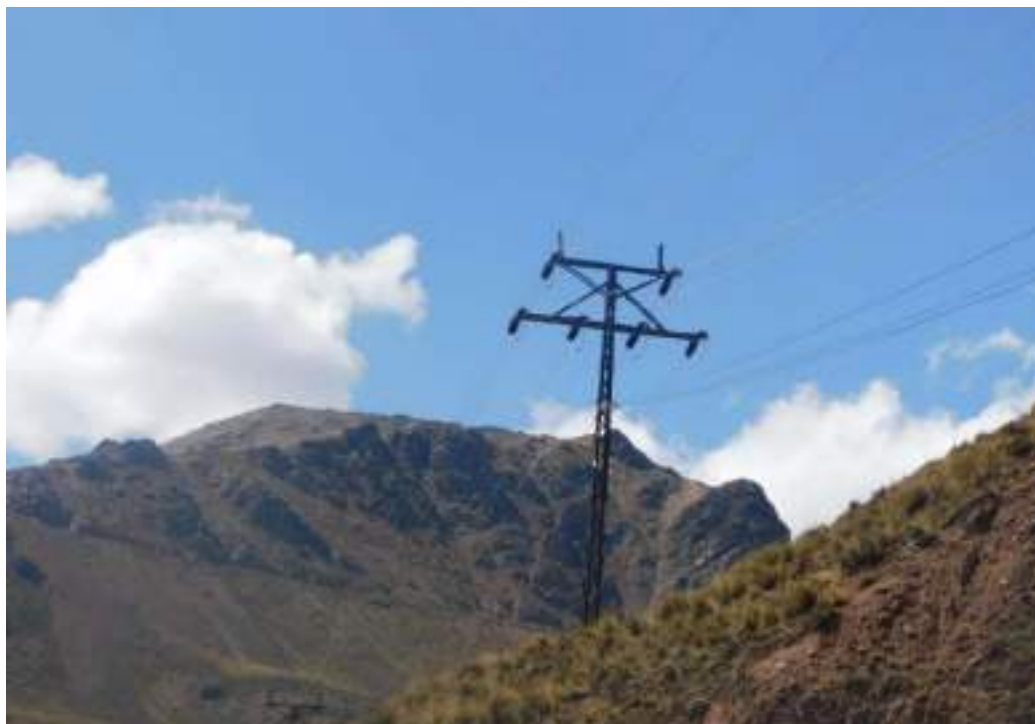
Fotografía 3-3 LT 50 kV de llegada desde S.E. Morococha hacia la S.E. Casapalca Norte
