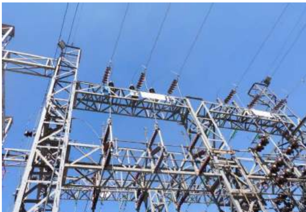
Fotografía 4-2 Pórtico de salida de LT 50 kV desde S.E. Carlos Francisco hacia S.E Casapalca Norte.
