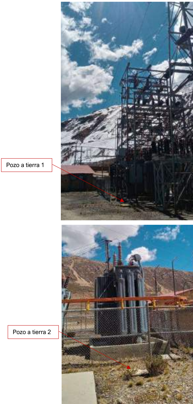
Fotografía 3.3-163 Vistas de Pozos a tierra
