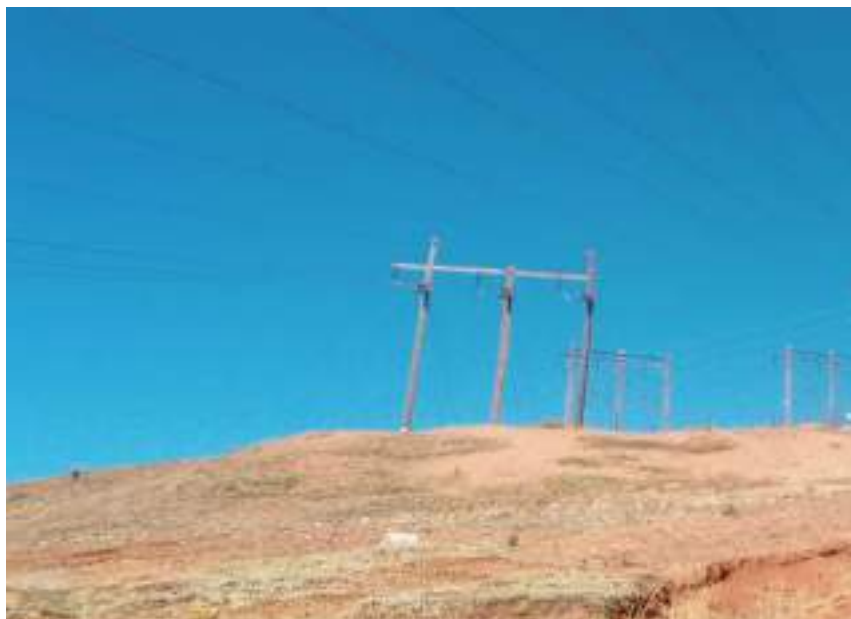
Fotografía 7-2 LT 50 kV de salida desde S.E Oroya Nueva hacia la S.E. Planta Zinc
