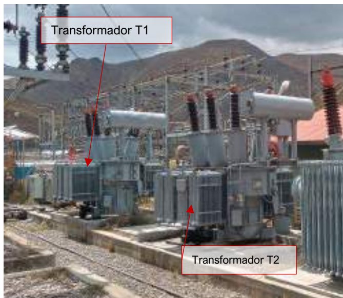
Fotografía 3.3-313 Vista Transformador trifásico T2 de potencia 6 MVA - 69/2.4 kV
