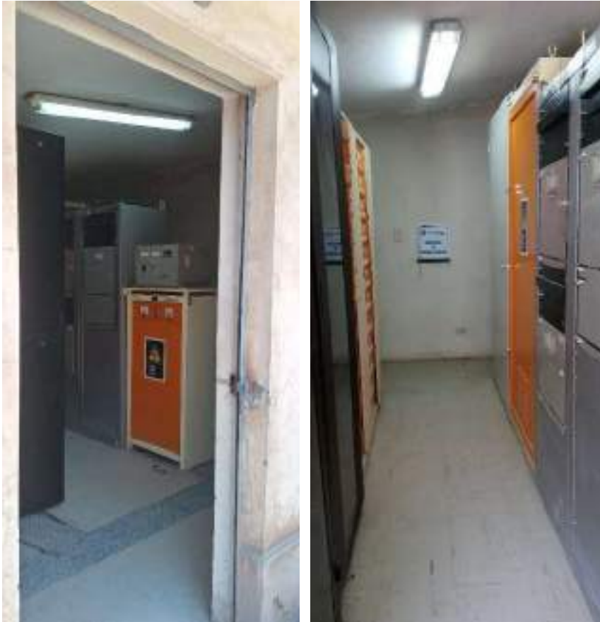
Fotografía 3.3-264 Vistas interior de Sala de Control
