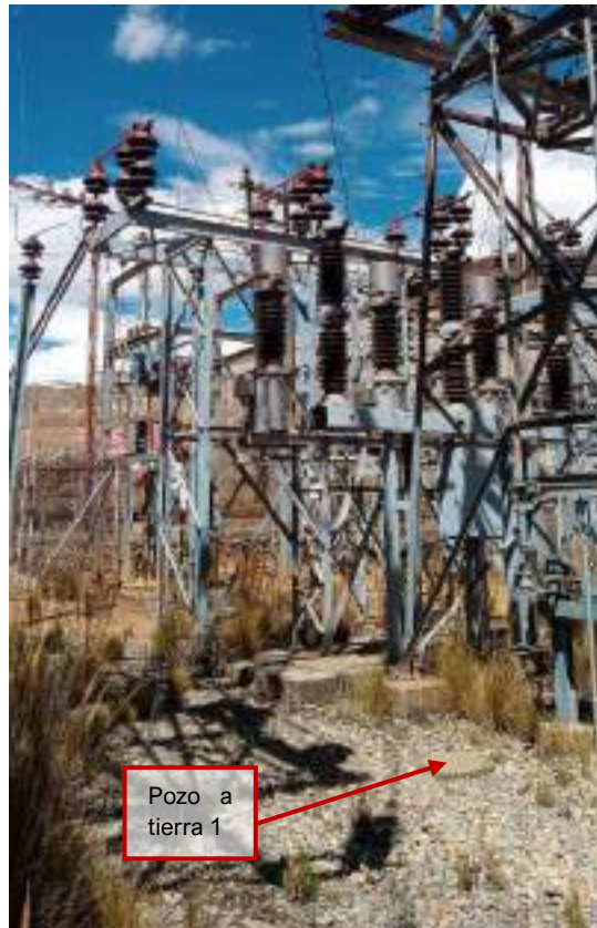
Fotografía 3.3-15 Vistas de Pozos a tierra
