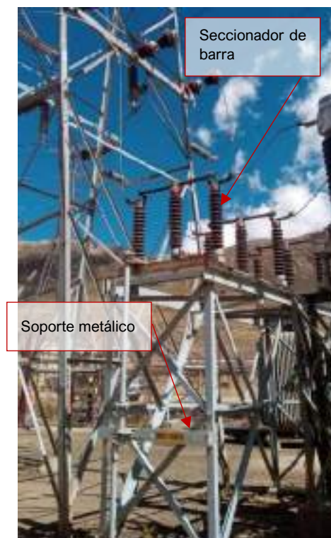
Fotografía 3.3-213 Vista de Seccionador de barra en 72.5 kV
