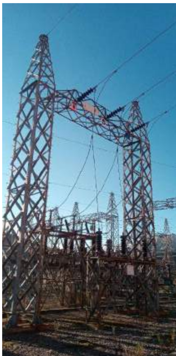
Fotografía 7-1 Pórtico de salida desde la S.E Oroya Nueva a la S.E. Planta Zinc
