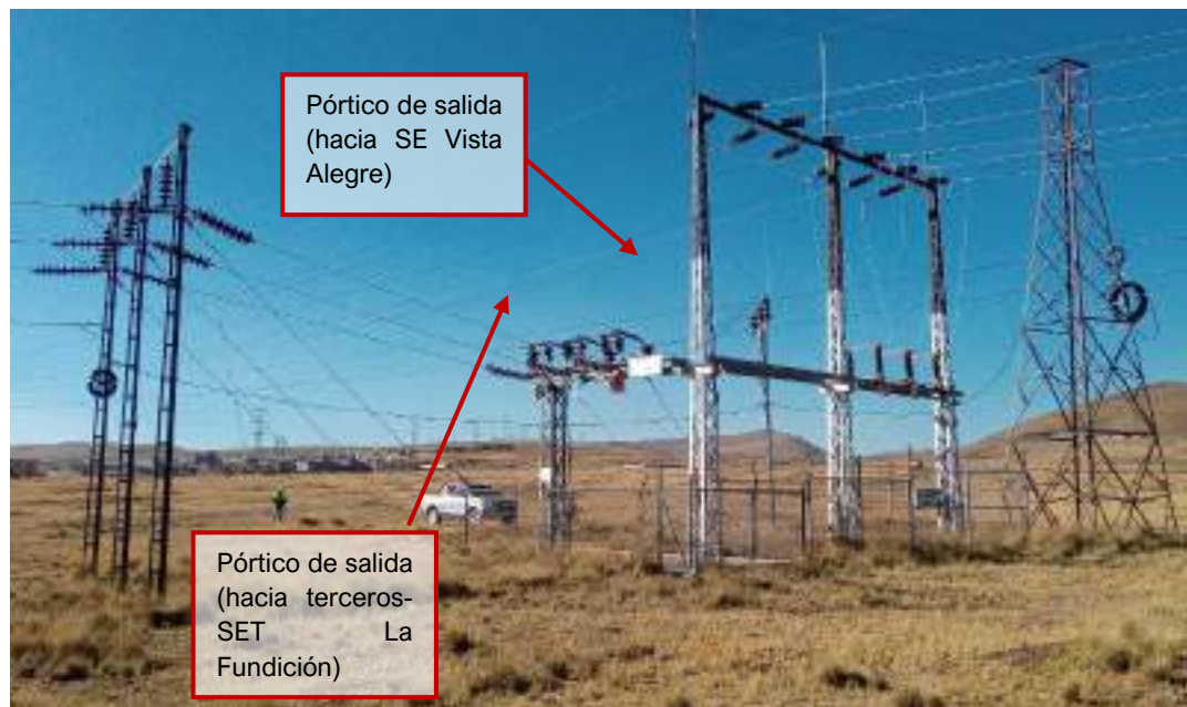
Fotografía 3.3-74 Vista de Líneas de salida
