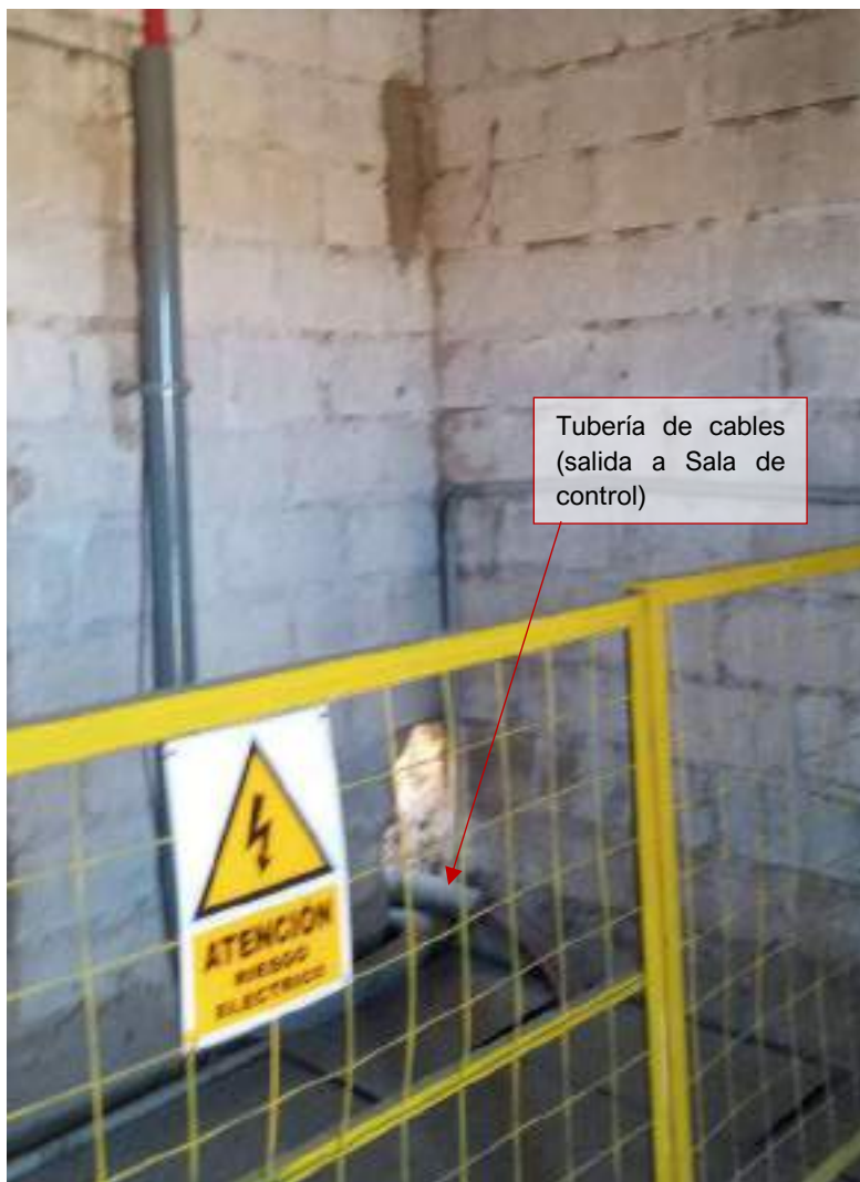
Fotografía 3.3-47 Vista de tubería de cables
