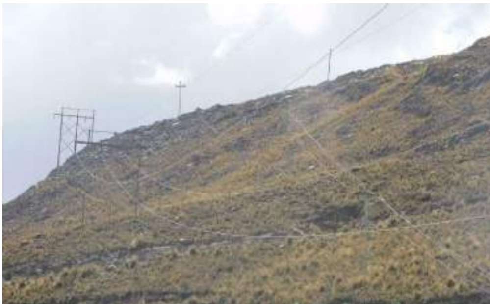
Fotografía 3-2 LT 69 kV de llegada a la S.E. Chumpe desde S.E. Pachacayo
