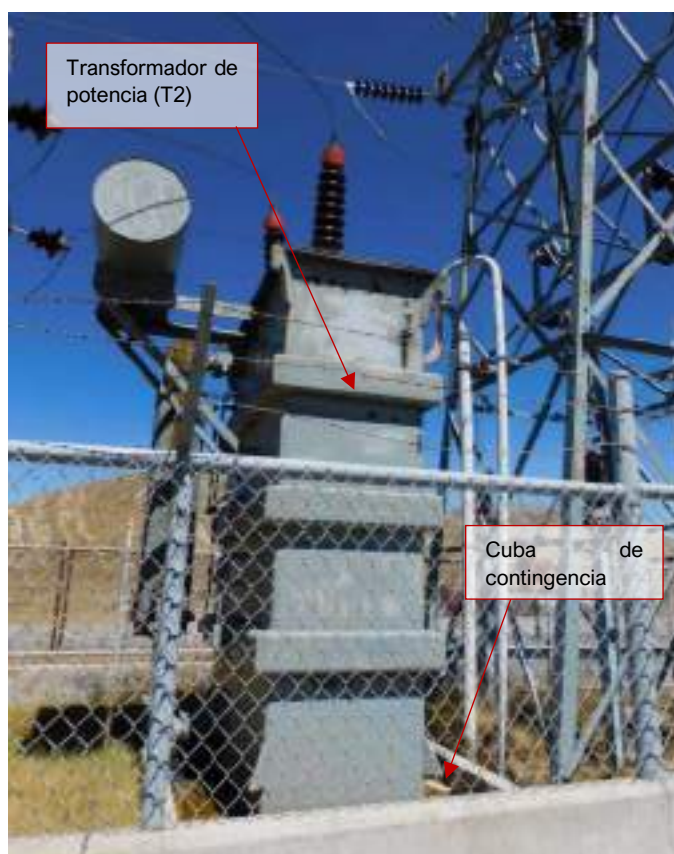
Fotografía 3.3-41 Vista de Transformador de potencia (T2) de 15 MVA
