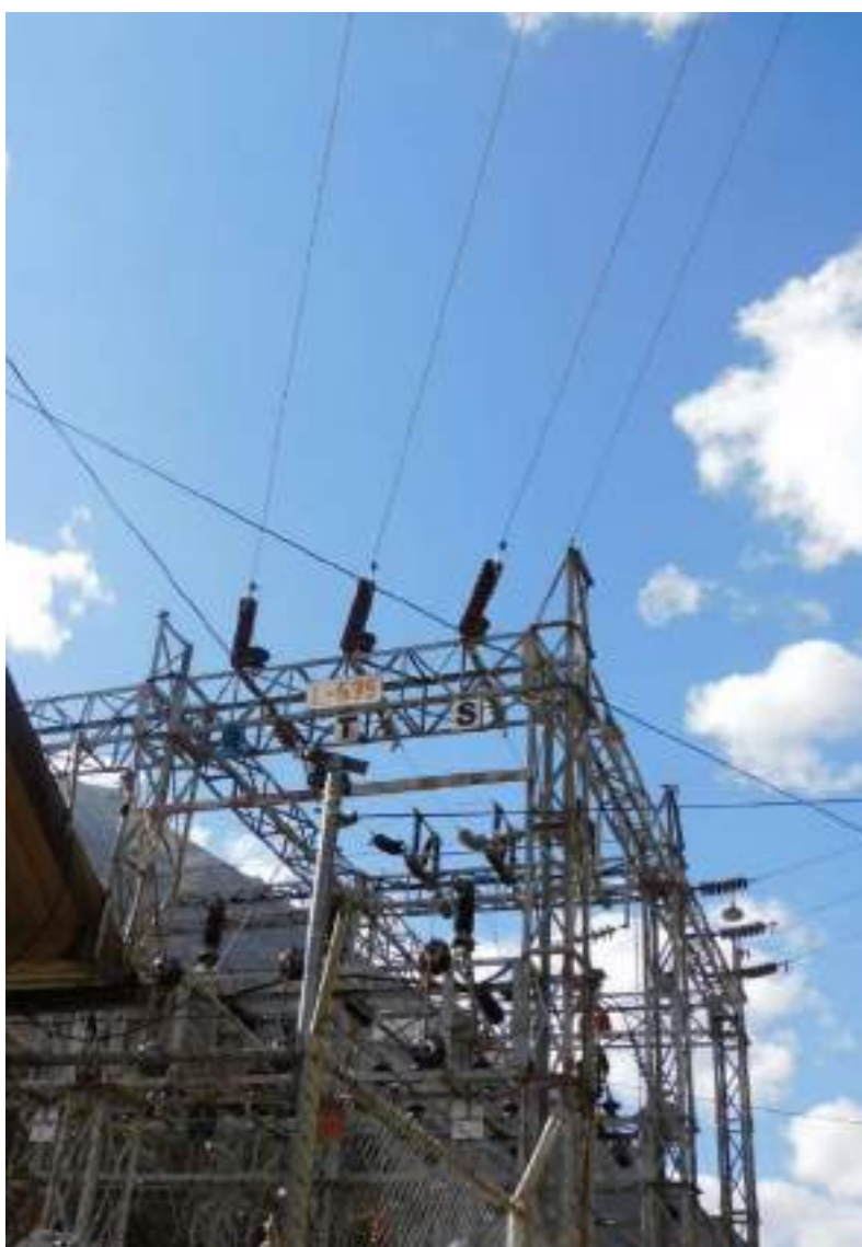
Fotografía 4-1 Pórtico de llegada de LT 50 kV a la S.E. Antuquito desde S.E. San Mateo
