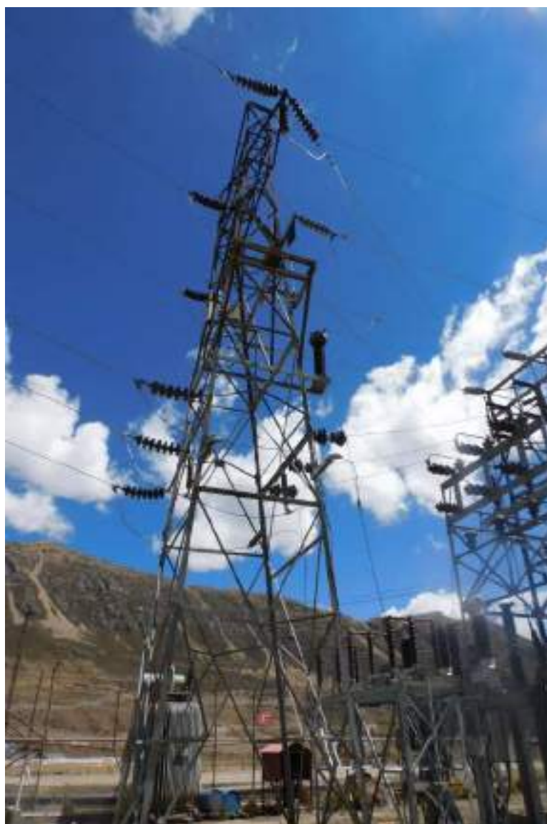
Fotografía 5-1 Pórtico de salida de LT 50 kV desde S.E San Cristóbal hacia S.E. Pachachaca (lado derecho)
