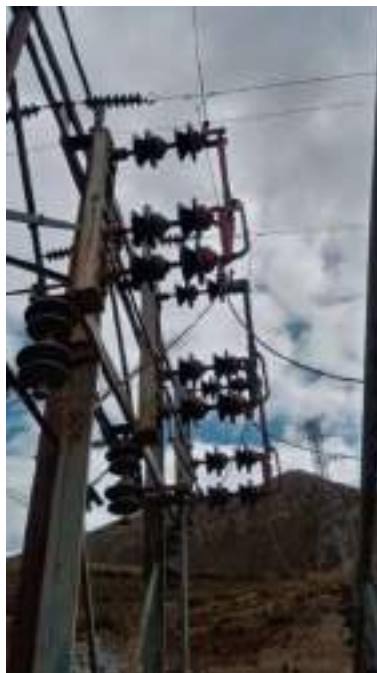
Fotografía 3.3-191 Vista de Seccionador de línea en 72.5 kV
