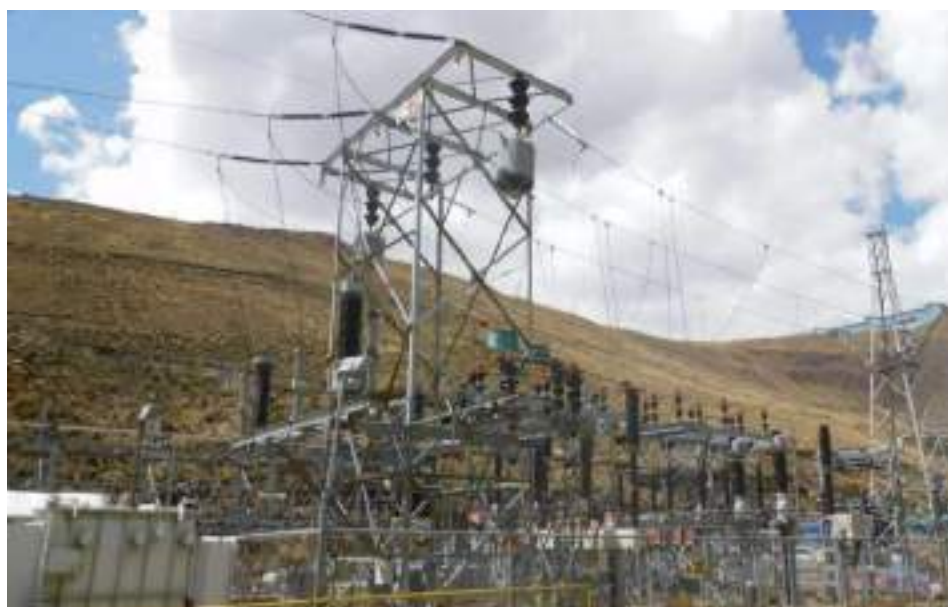
Fotografía 3-1 Pórtico de Llegada de LT 69 kV a la S.E. Chumpe desde S.E. Pachacayo
