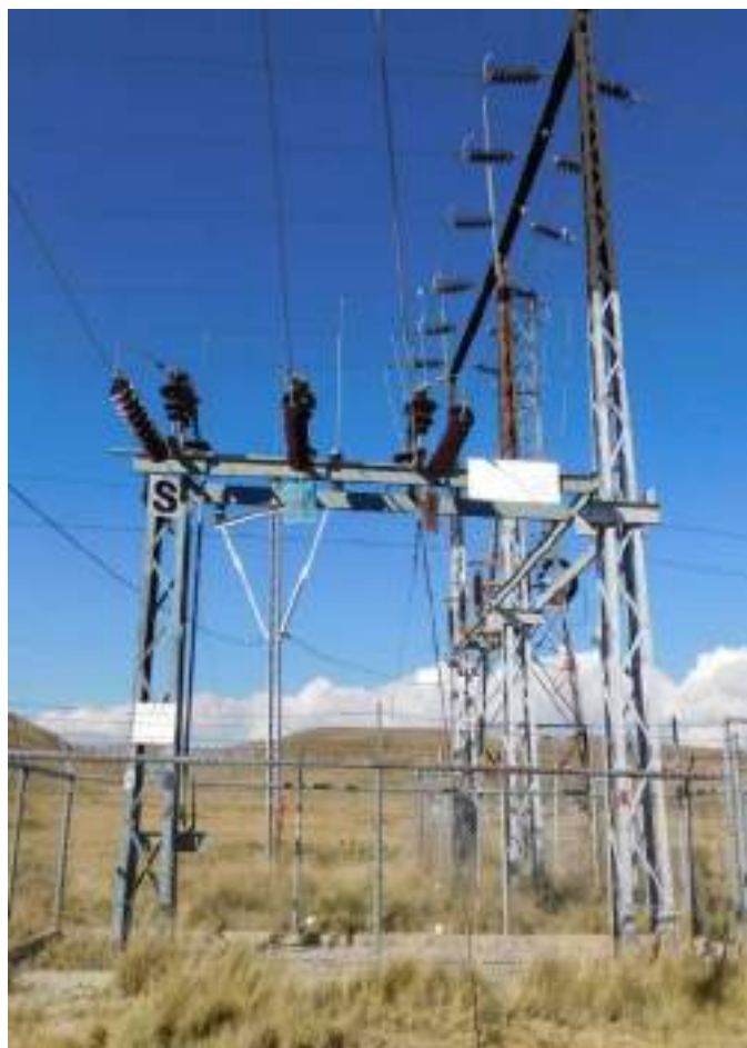
Fotografía 4-1 Pórtico de salida de LT 50 kV de S.E. Buenavista hacia S.E. La Fundición
