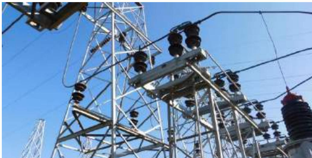
Fotografía 6-4 Seccionador de línea de 50 kV
