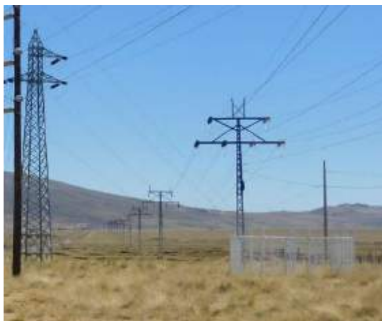
Fotografía 3-1 LT 50 kV desde la S.E Vista Alegre hacia la S.E Shelby con torre metálicas
