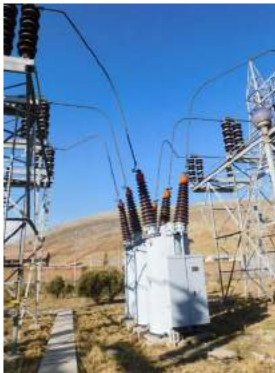
Fotografía 6-6 Interruptor de potencia de 138 kV
