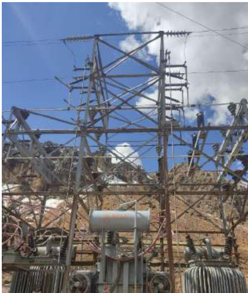
Fotografía 3-2 Pórtico de salida (lado izquierdo) de LT 50 kV S.E. San Cristóbal – S.E. San Antonio.
