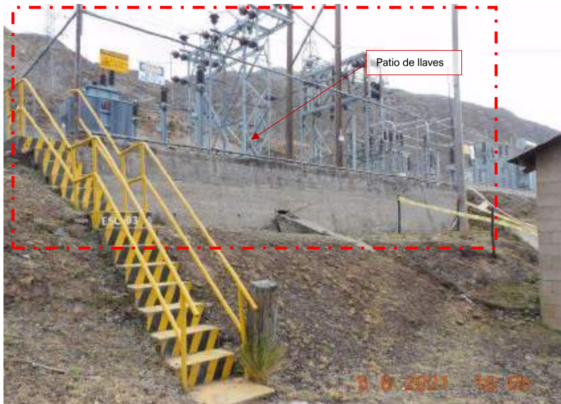
Fotografía 3.3-190 Vista de Patio de Llaves
