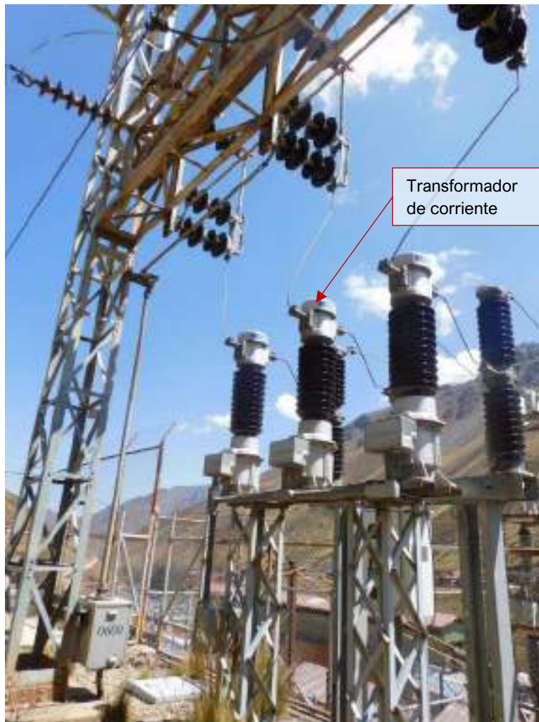
Fotografía 3.3-284 Transformador de corriente en 50 kV
