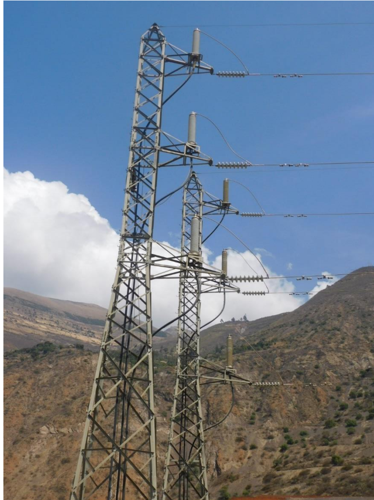
Fotografía 3-2 LT 69 kV de llegada a S.E. Cobriza II desde S.E. Cobriza I
