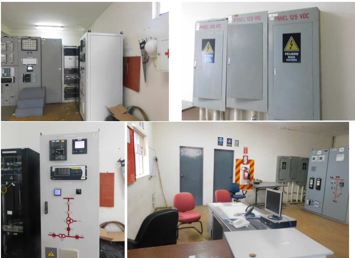
Fotografía 3.3-11 Vistas de interiores de Sala de Control
