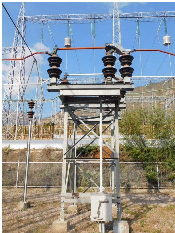
Fotografía 3.3-9 Vista de Seccionador de barra en 72.5 kV
