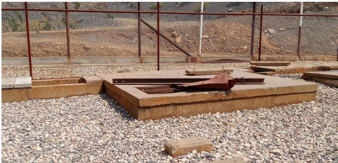
Fotografía 3.3-32 Vista exterior de caja de pase
