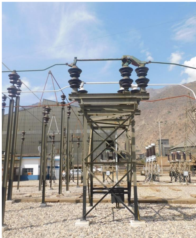
Fotografía 3.3-27 Vista de Seccionador de barra en 72.5 kV.
