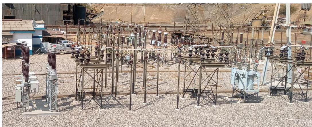
Fotografía 3.3-23 Vista de Patio de Llaves
