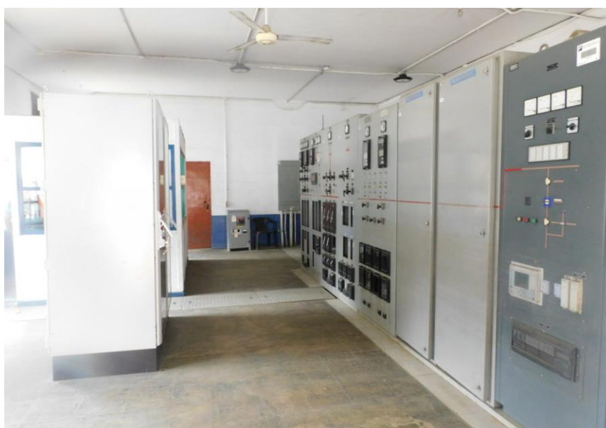
Fotografía 3.3-29 Vistas Interiores de Sala de Control
