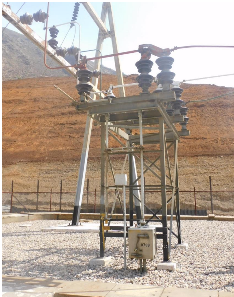
Fotografía 3.3-26 Vista de Seccionador de línea de 72.5 kV
