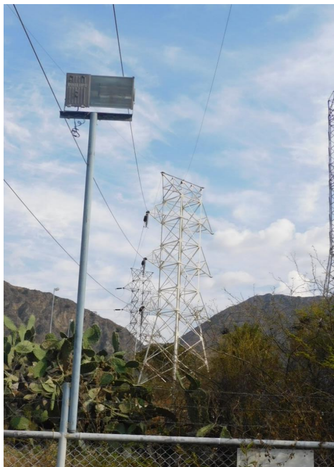
Fotografía 3-2 LT 69 kV de salida desde S.E. Cobriza I hacia S.E. Cobriza II
