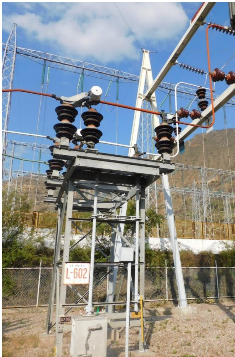
Fotografía 3.3-8 Vista de Seccionador de línea en 72.5 kV.
