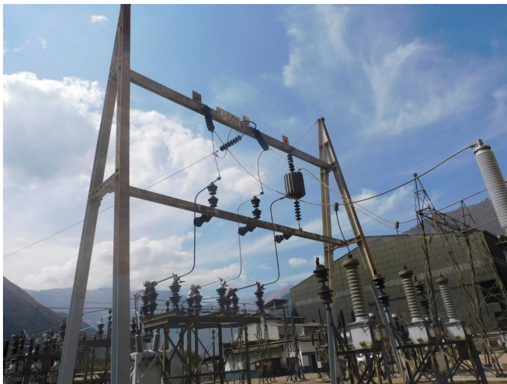
Fotografía 3-1 Pórtico de llegada de LT 69 kV S.E. Cobriza II desde Cobriza I
