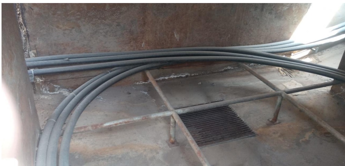
Fotografía 3.3-33 Vista interior de caja de pase
