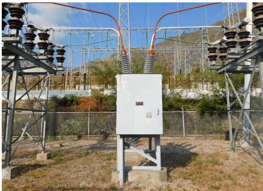
Fotografía 3.3-7 Vista de Interruptor de potencia de 72.5 kV
