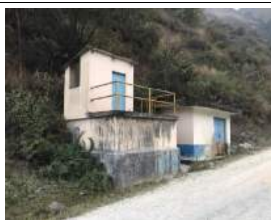
Fotografía 6.2-26 Plantas de tratamiento de agua potable (PTAP) (PAD-CHY-10c)
