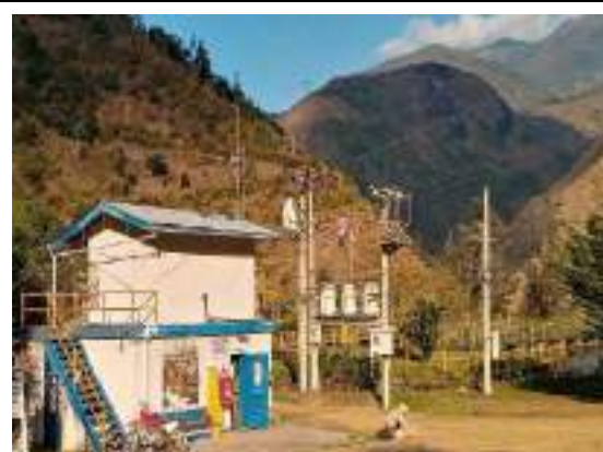
Fotografía 6.2-36 Líneas de media tensión (PAD-CHY-13)
