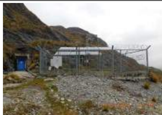
Fotografía 6.2-38 Paneles solares en presas (PAD-CHY-14b)
