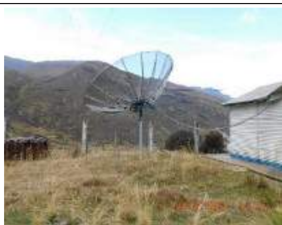
Fotografía 6.2-16 Estaciones de telecomunicación 3 (PAD-CHY-07c)
