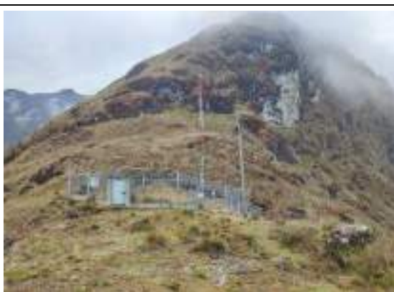
Fotografía 6.2-39 Paneles solares (PAD-CHY-15a)
