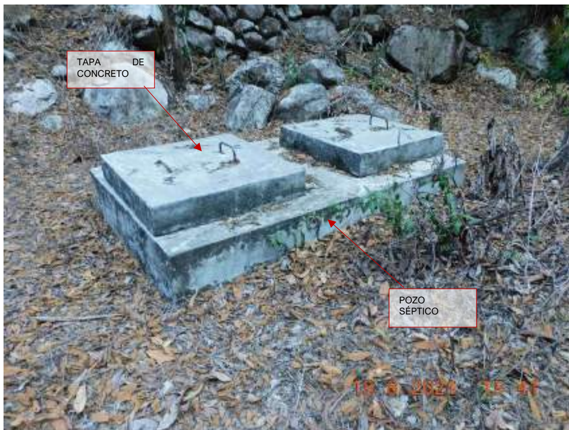
Fotografía 3-40 Estado actual del pozo séptico en campamento Manto
