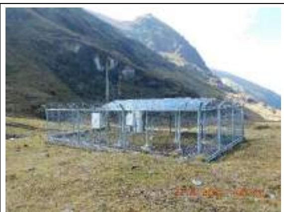
Fotografía 6.2-45 Paneles solares (PAD-HGB-05)
