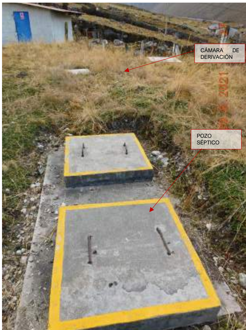
Fotografía 3-42 Estado actual del pozo séptico en campamento Tingocancha
