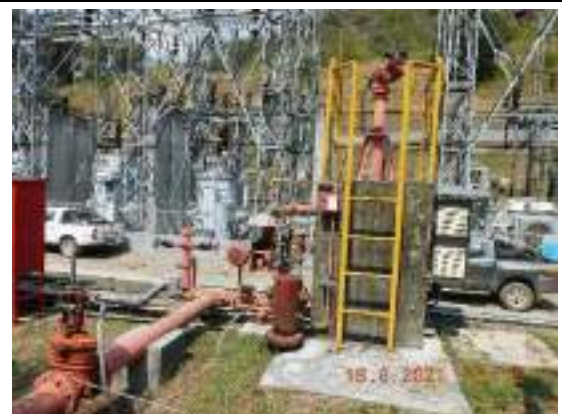
Fotografía 6.2-35 Sistema contra incendio (PAD-CHY-12)
