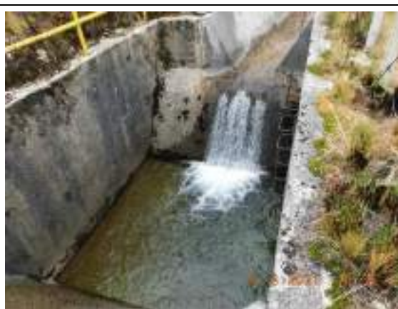
Fotografía 6.2-9 Cámara de carga (PAD-CHY-03b)
