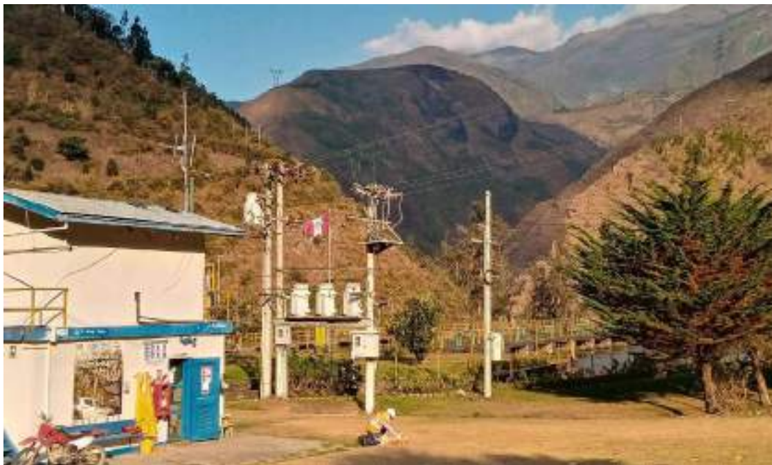
Fotografía 3-63 Estado actual del componente línea de media tensión
