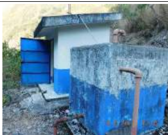
Fotografía 6.2-25 Plantas de tratamiento de agua potable (PTAP) (PAD-CHY-10b)
