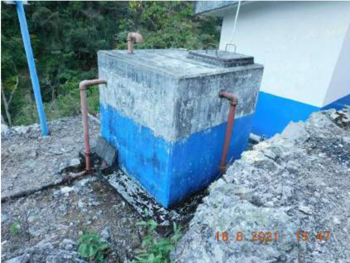
Fotografía 3-47 Estado actual del componente PTAP
