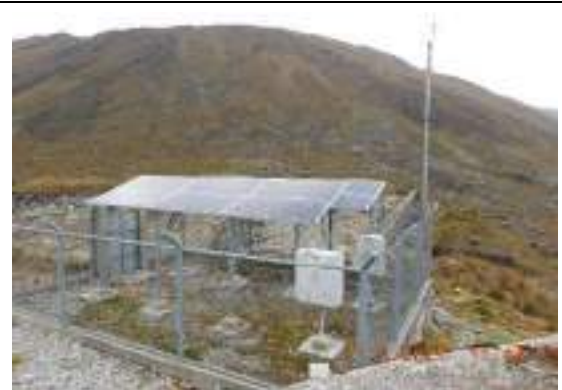
Fotografía 6.2-37 Paneles solares en presas (PAD-CHY-14a)
