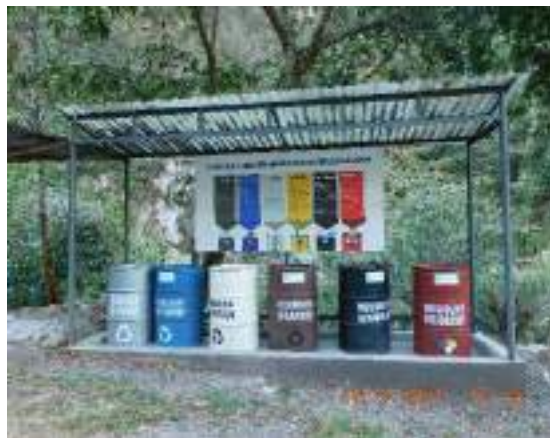
Fotografía 6.2-32 Puntos de acopio de residuos sólidos 5 (PAD-CHY-11e)
