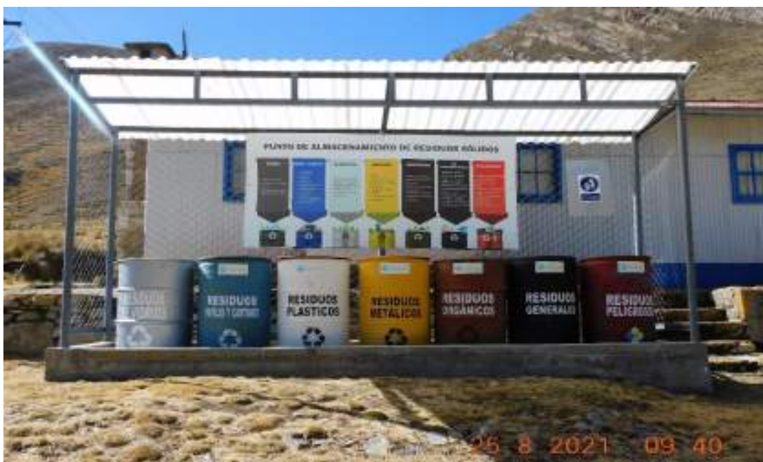
Fotografía 3-29 Vista de estructura metálica del componente punto de acopio de residuos sólidos 2
