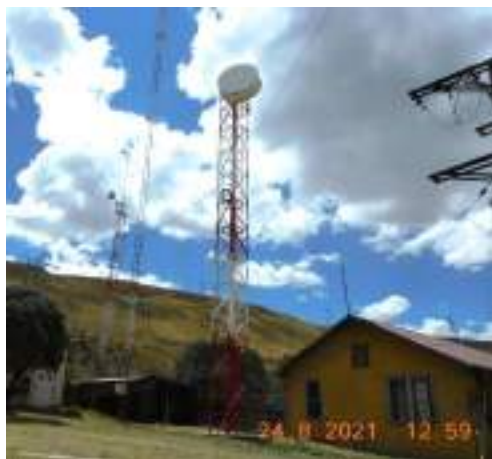
Fotografía 6.2-3 Estaciones de telecomunicación (PAD-CHP-03)
