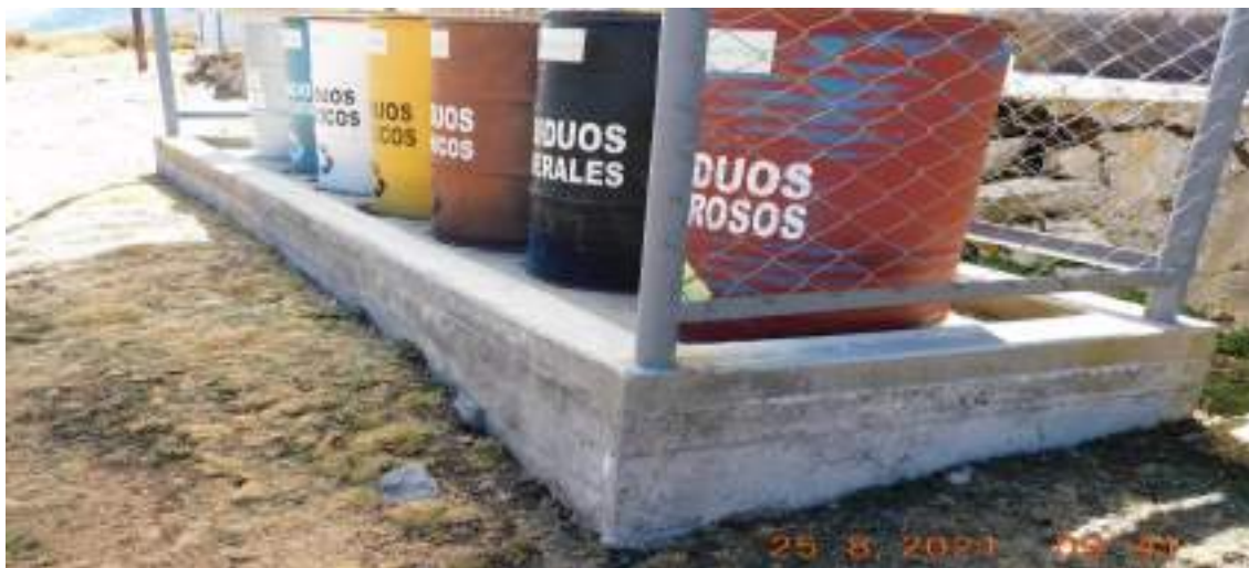
Fotografía 3-28 Vista de losa de delimitación del componente punto de acopio de residuos sólidos 2
