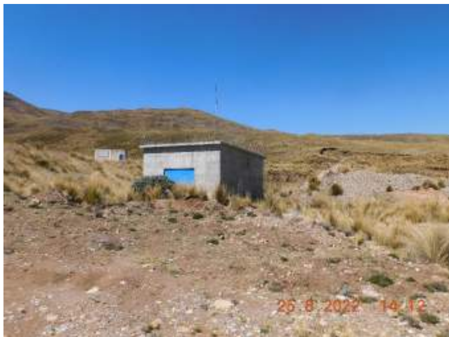
Fotografía 15: Componente Caseta de válvula de seguridad ubicado en la zona CH Pachachaca 2, distrito de Morococha, provincia de Yauli, departamento de Junín.
