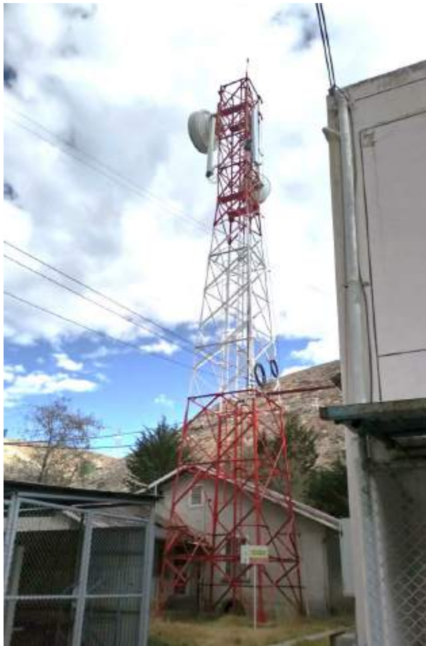
Fotografía 3.3-11 Vista actual del componente Estación de telecomunicación 1
