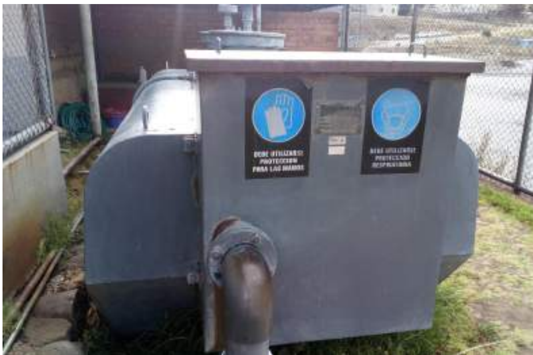
Fotografía 3.3-27 Vista del equipo metálico de tratamiento del componente PTARD 2
