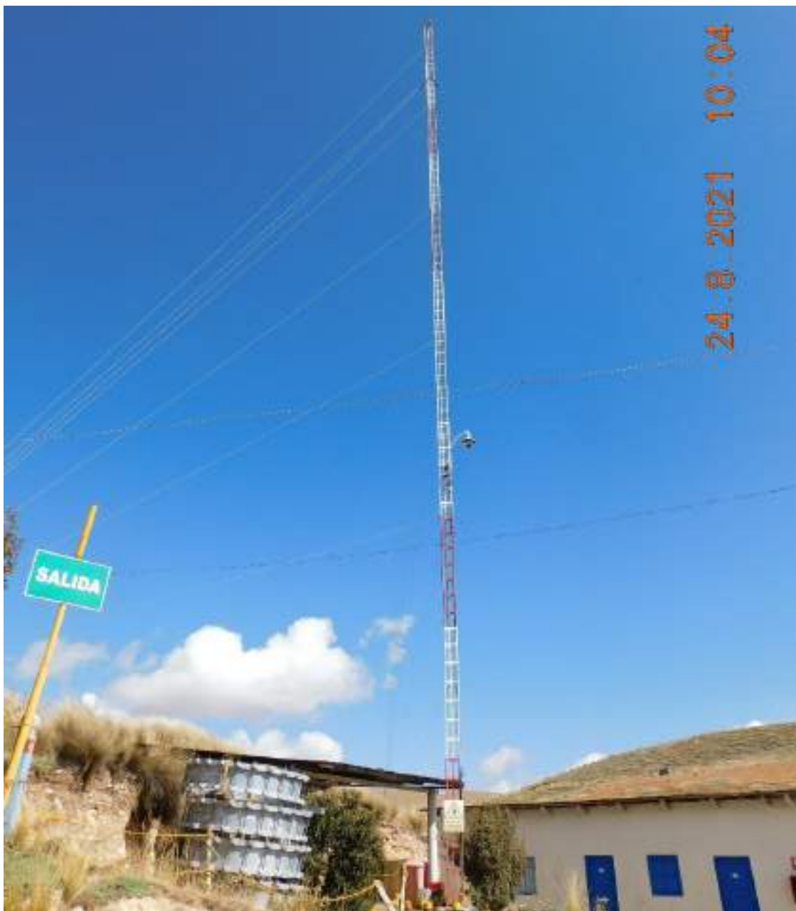
Fotografía 3.3-14 Vista actual - Estaciones de telecomunicación 4
