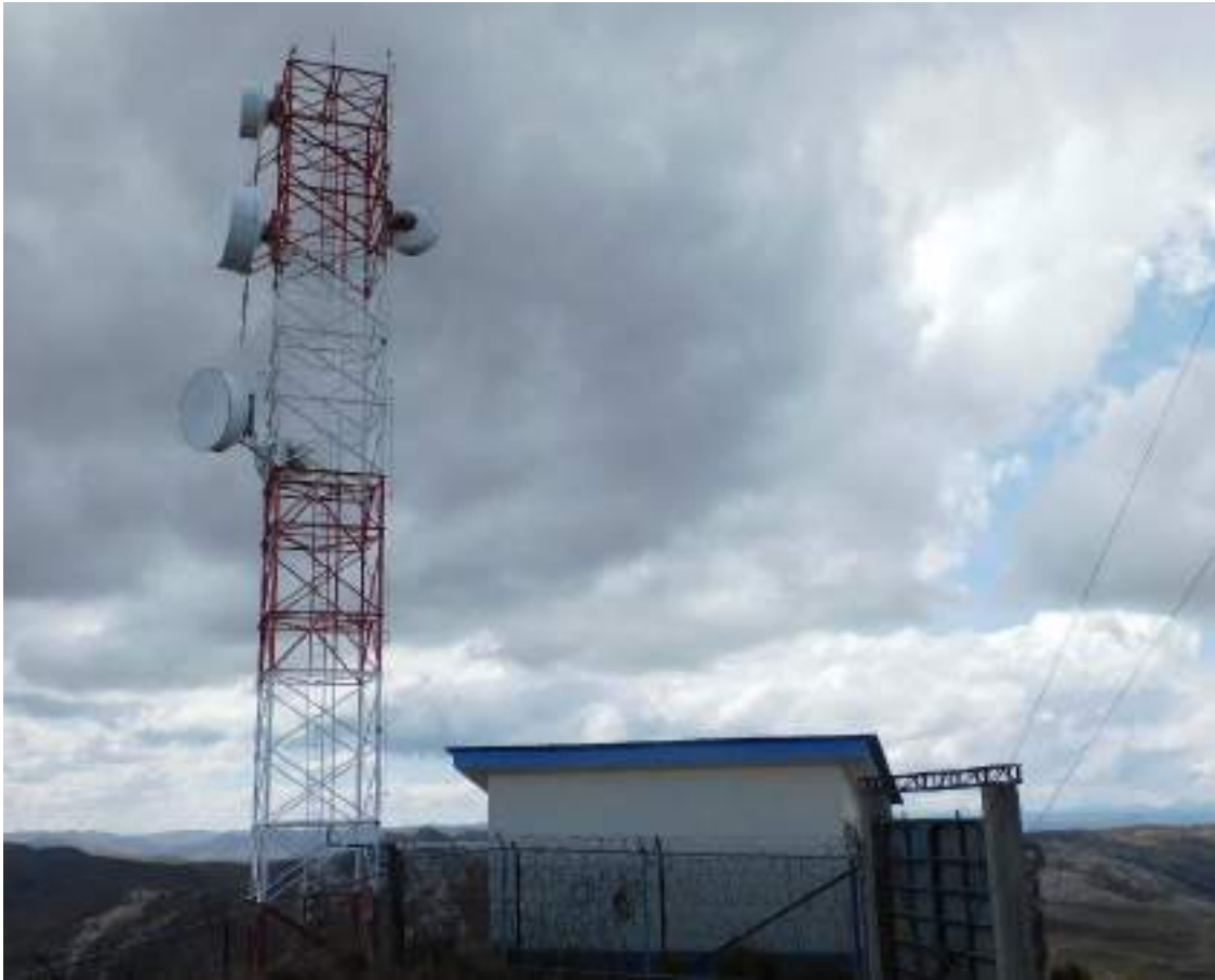
Fotografía 3.3-12 Vista actual - Estaciones de telecomunicación 2
