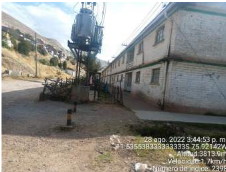
Fotografía 37: Asociación de Vivienda Buenos Aires, se puede apreciar las redes de alumbrado público, además de las conexiones de energía a viviendas.
