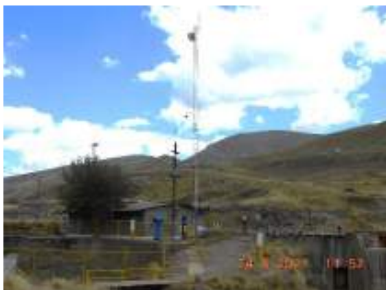
Fotografía 6.2-7 Estaciones de telecomunicaciones 3 (PAD-CHO-03a)
