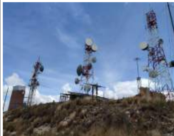
Fotografía 6.2-6 Estaciones de telecomunicaciones 2 (PAD-CHO-03a)
