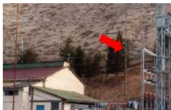
Fotografía 6.2-28 Línea de media tensión 2.4 kv (PAD-CHO-10)
