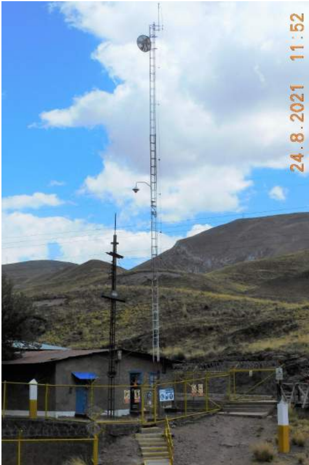
Fotografía 3.3-13 Vista actual - Estaciones de telecomunicación 3
