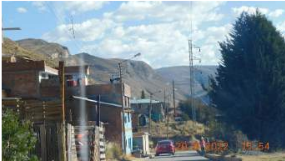
Fotografía 29: Pueblo Joven San Vicente de Paul, se observó la presencia de redes de alumbrado público desplegadas en todo el poblado.
