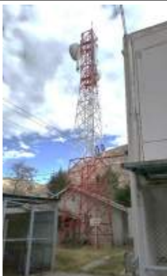
Fotografía 6.2-5 Estaciones de telecomunicaciones 1 (PAD-CHO-03a)
