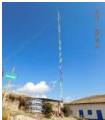
Fotografía 6.2-8 Estaciones de telecomunicaciones 4 (PAD-CHO-03a)
