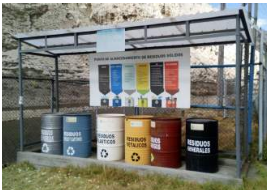
Fotografía 3.3-36 Vista actual del punto de acopio de Residuos Sólidos5 (PAD-CHO-08e)
