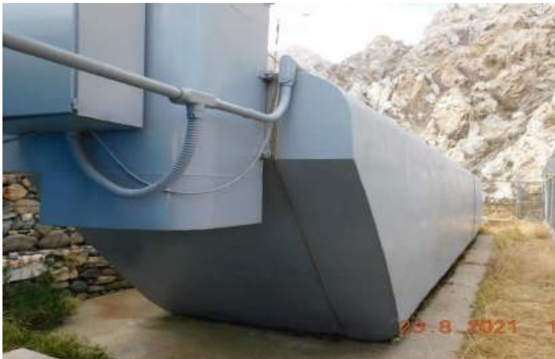
Fotografía 3.3-25 Vista del tanque metálico del componente PTARD 1
