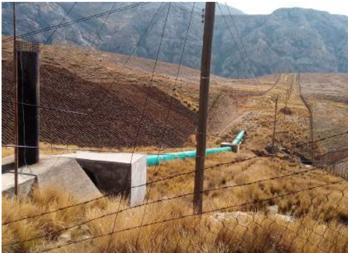
Fotografía 3.3-41 Vista llegada de Línea de media tensión 2.4 kV
