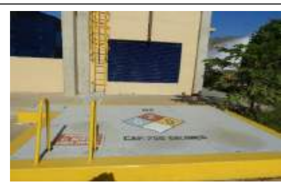
Fotografía 6.2-10 Tanque de combustible (PAD-CHG-07)
