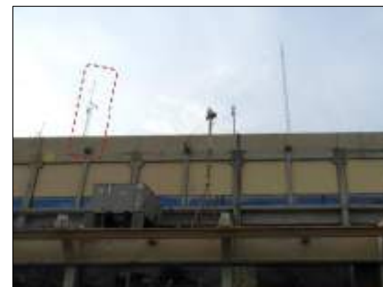
Componente: Pararrayos – Casa de máquinas Superficie: 10.35 m 2
