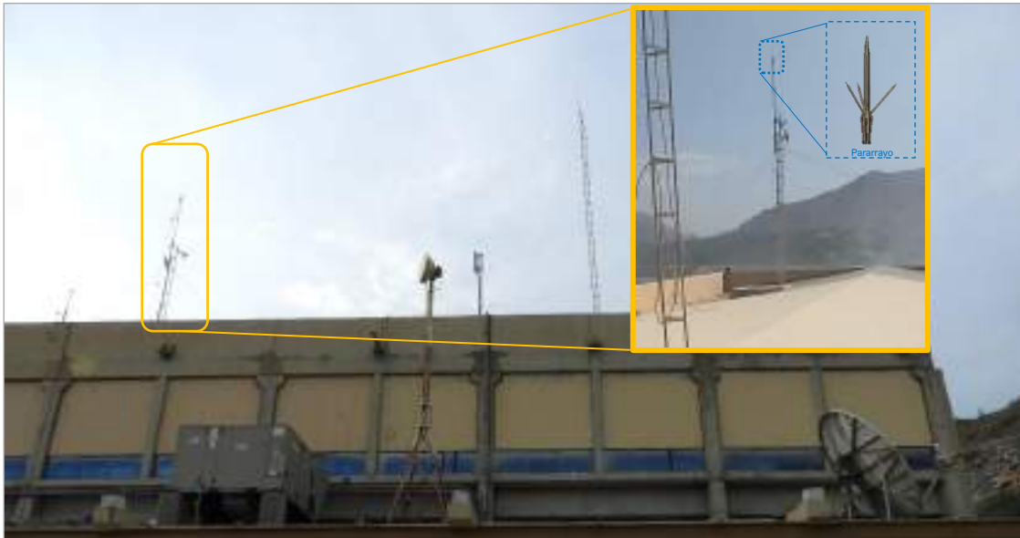
Fotografía 3.3-12 Vista actual del Pararrayos 1
