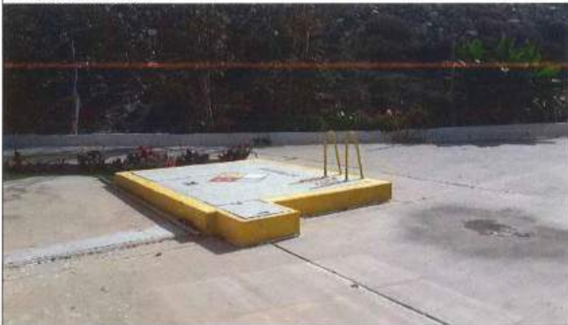
Tanque de combustible
