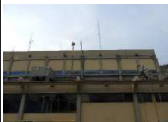
Fotografía 6.2-4 Estación de telecomunicación (PAD-CHG-03)
