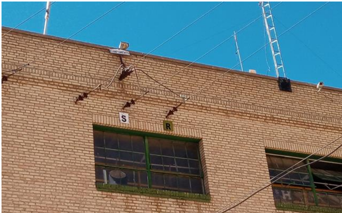
Fotografía 3.3-12 Salida de línea de transmisión de 2.4 kV
