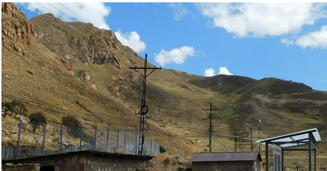
Fotografía 3.3-11 Línea de media tensión
