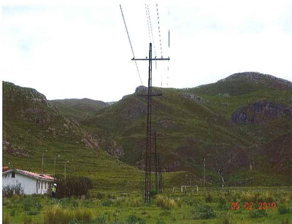
Línea de media tensión de 2.4 kV
