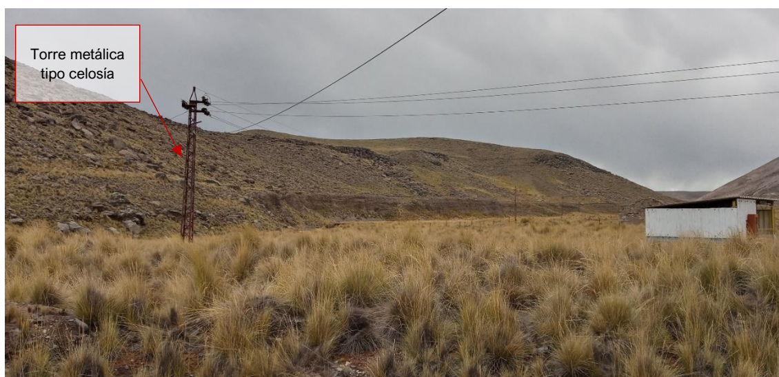
Fotografía 3-27 Torres de línea de transmisión de 15 kV
