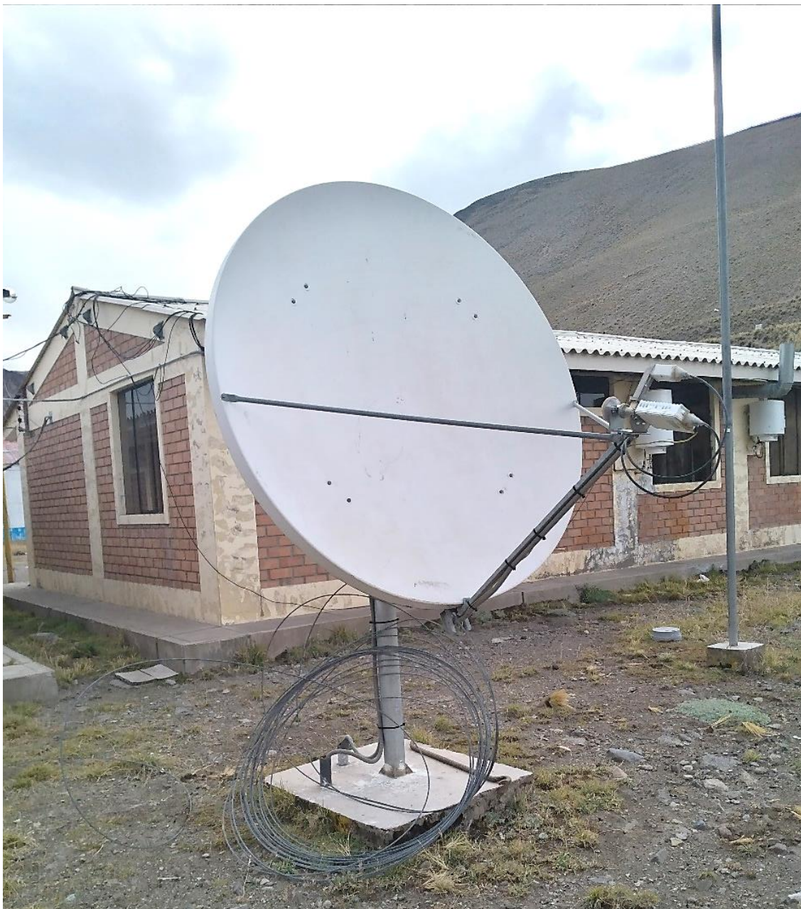
Fotografía 3-22 Vista actual de la estación de telecomunicación 2
