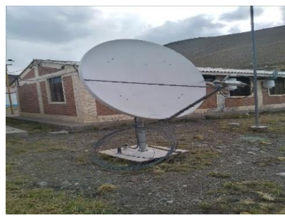
Fotografía 6.2-8 Estación de telecomunicación 2 (PAD-CSI-07b)
