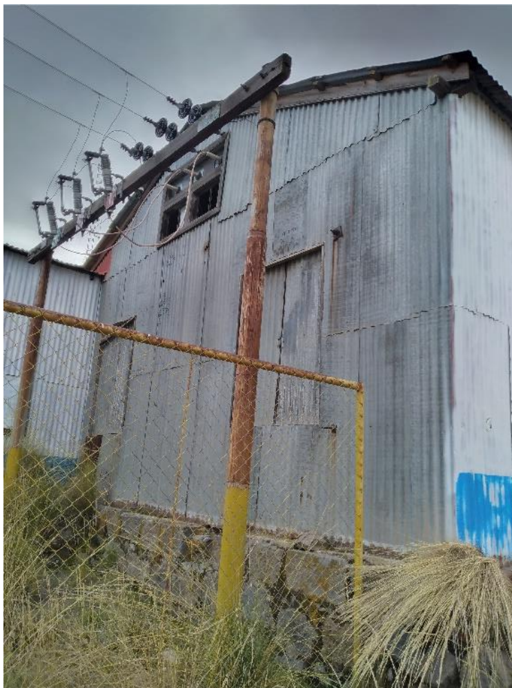
Fotografía 3-26 Salida de línea de media tensión 15 kV
