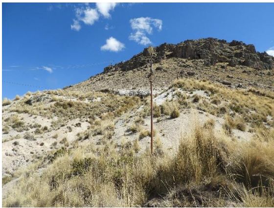
Fotografía 6.2-7 Estación de telecomunicación 1 (PAD-CSI-07a)
