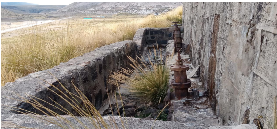
Fotografía 3-10 Válvulas y rectificador de caudal
