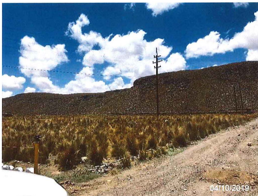
Línea de media tensión 10.5 kV
