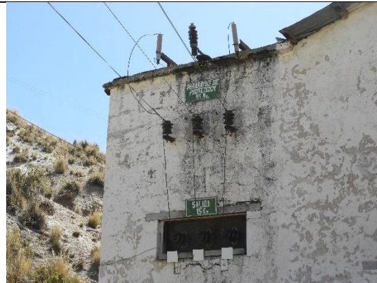
Fotografía 6.2-8 Línea media de tensión 15 kv
