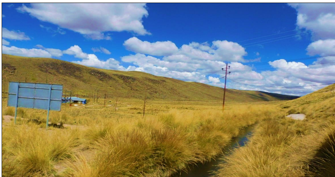
Fotografía 3.2-10 Vista actual de los vértices de la Línea de media tensión 15kV
