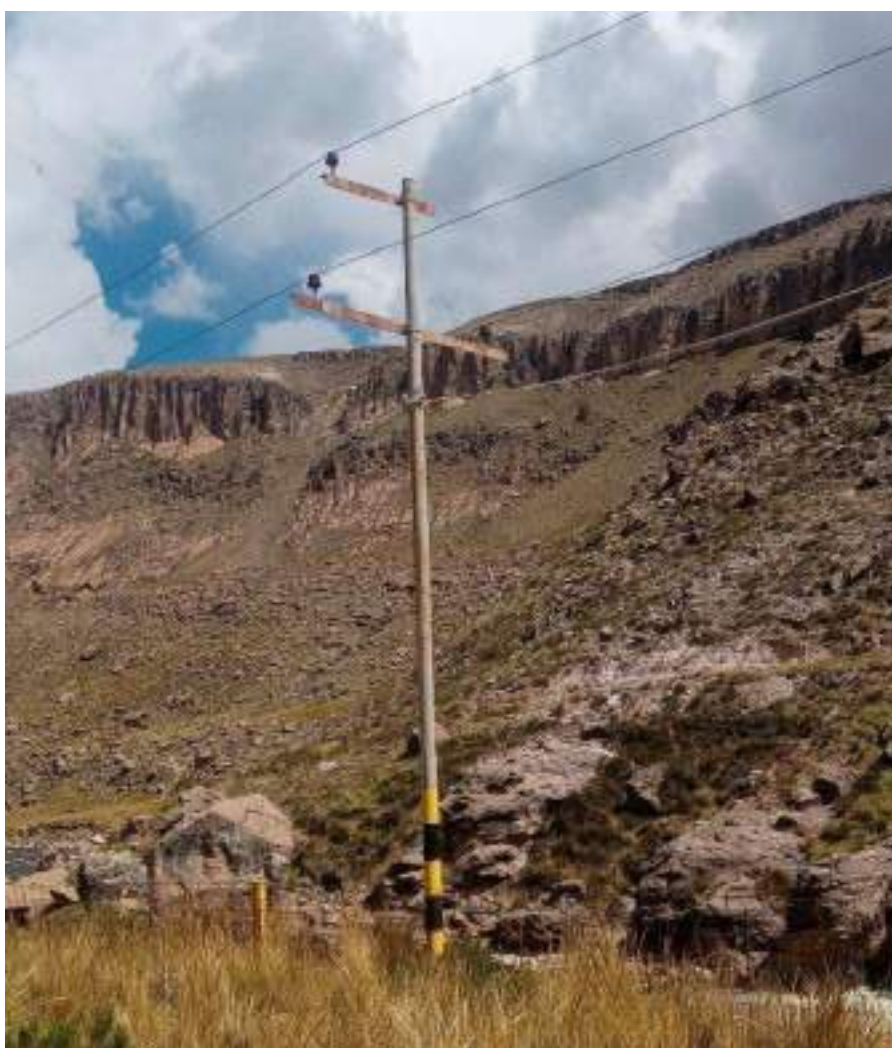
Fotografía 3.3-32 Postes metálicos de línea de media tensión 2.4kV
