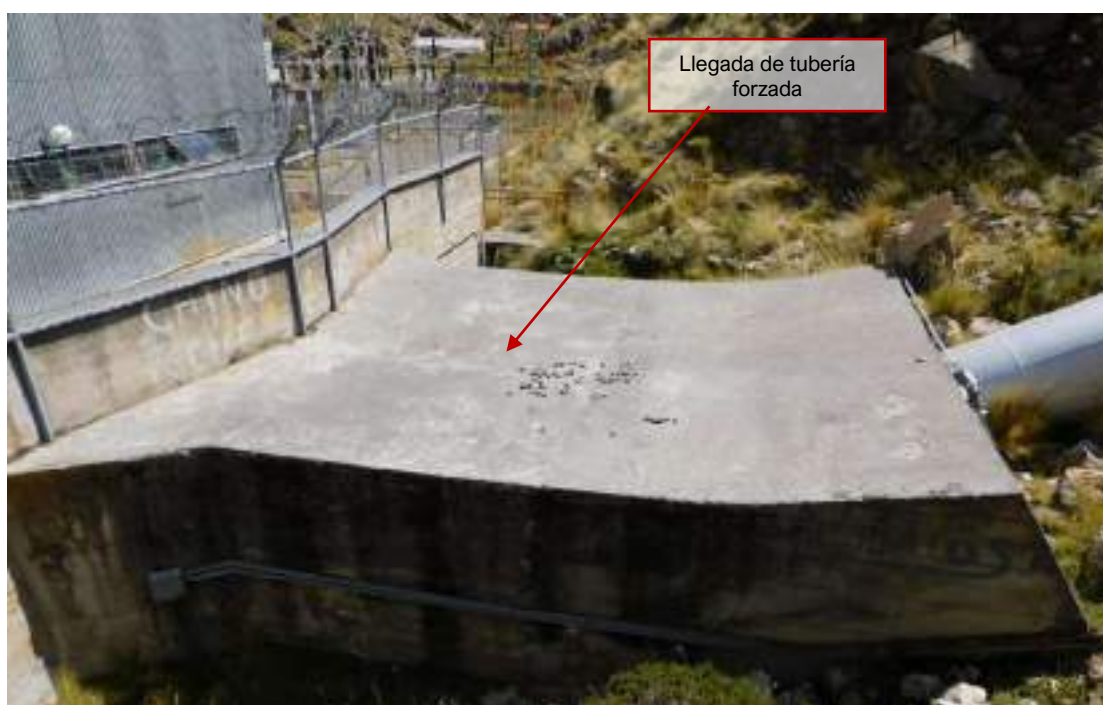
Fotografía 3.3-10 Tubería forzada - Llegada a casa de máquinas
