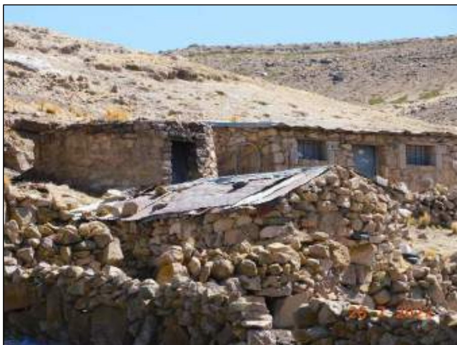
Fotografía 22: Infraestructura de la estancia Llojeta. Viviendas con paredes de piedra y techo de calamina.
