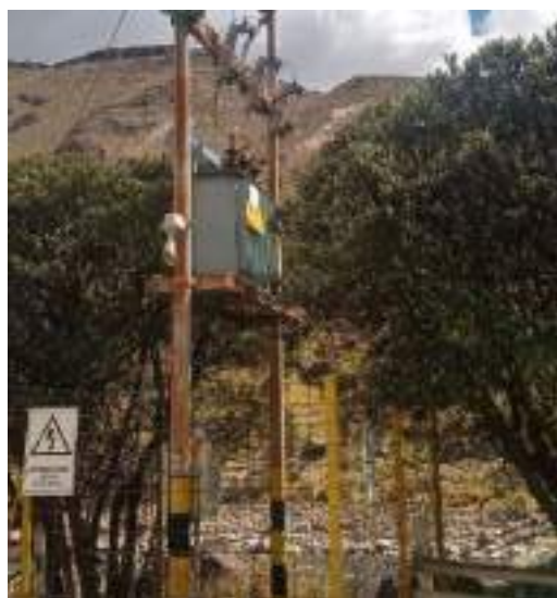
Fotografía 3.3-31 Línea de media tensión 2.4 kv - Vertice de llegada
